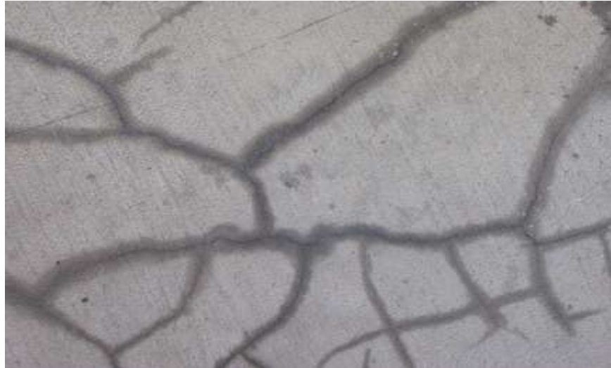
Figura 13: Lesiones del Concreto.
