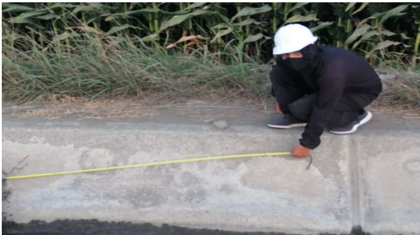
Imagen 6: Presencia de Eflorescencia en el Canal Monte Chimbote de Cambio Punte, Distrito de Chimbote, provincia del Santa, región Áncash.
