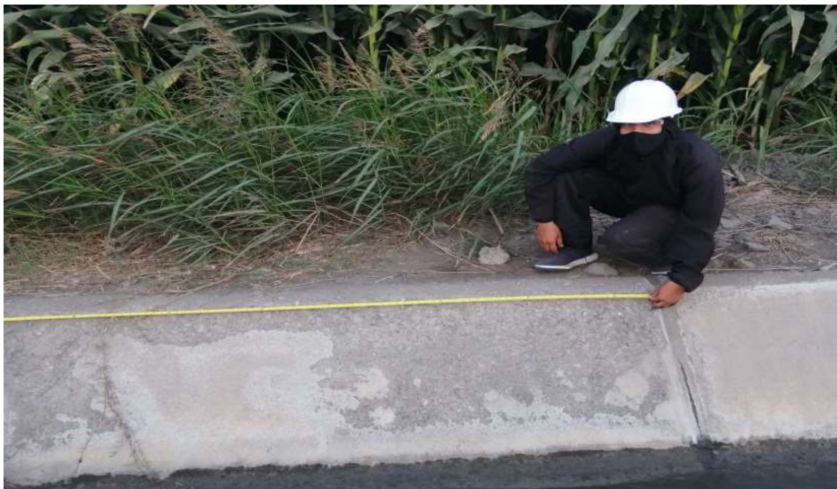
Imagen 4: Presencia de Erosión en el Canal Monte Chimbote de Cambio Puente, Distrito de Chimbote, provincia del Santa, región Áncash.
