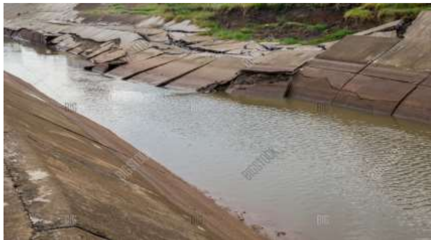
Figura 14: Erosión del Concreto en un canal.
