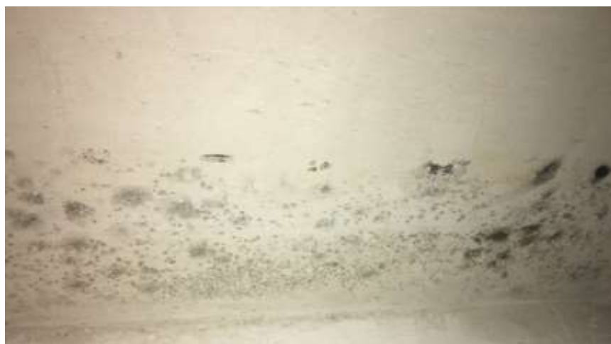
Figura 20: Moho presente en el Canal.
