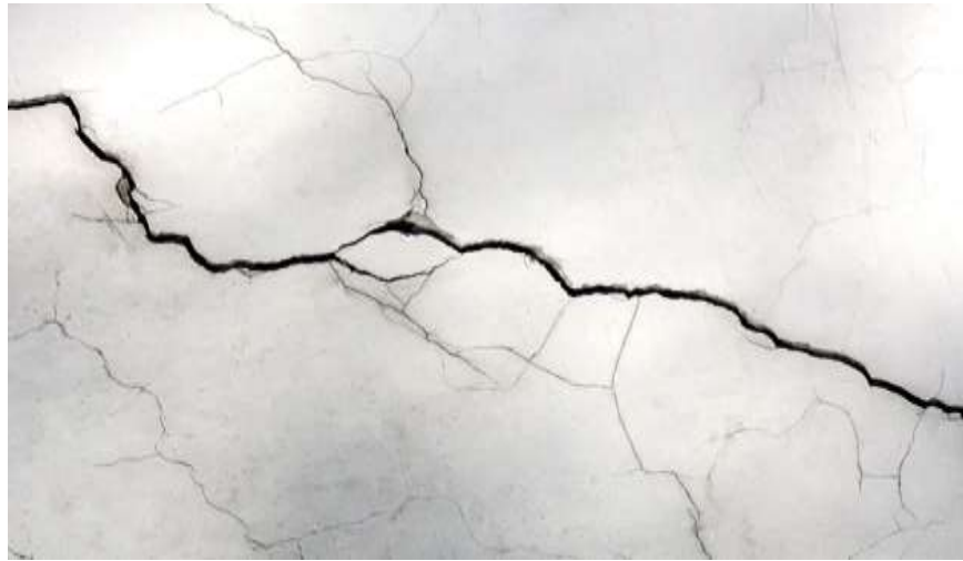
Figura 16: Grietas presentes en el Canal.
