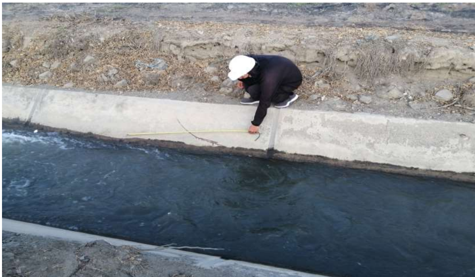
Imagen 2: Presencia de Moho en el Canal Monte Chimbote de Cambio Punte, Distrito de Chimbote, provincia del Santa, región Áncash.
