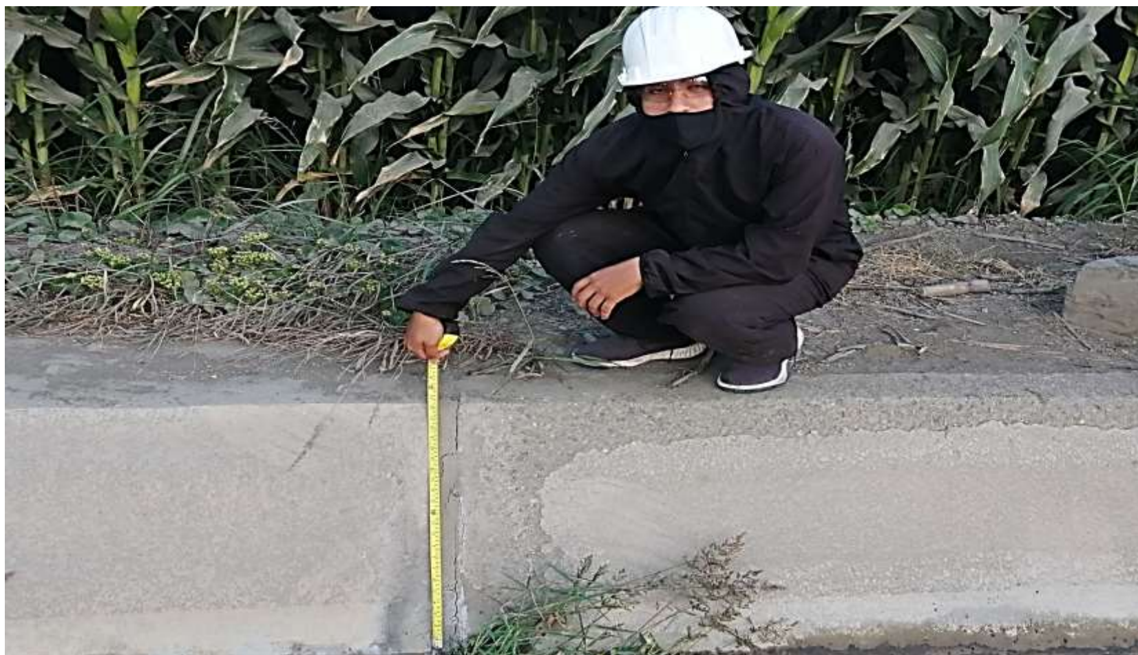
Imagen 5: Presencia de Fisura en el Canal Monte Chimbote de Cambio Puente, Distrito de Chimbote, provincia del Santa, región Áncash.
