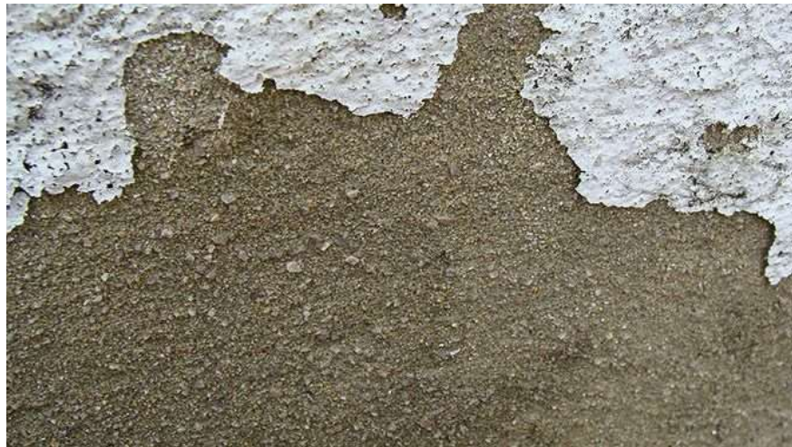
Figura 17: Desprendimiento del mortero en el Canal.
