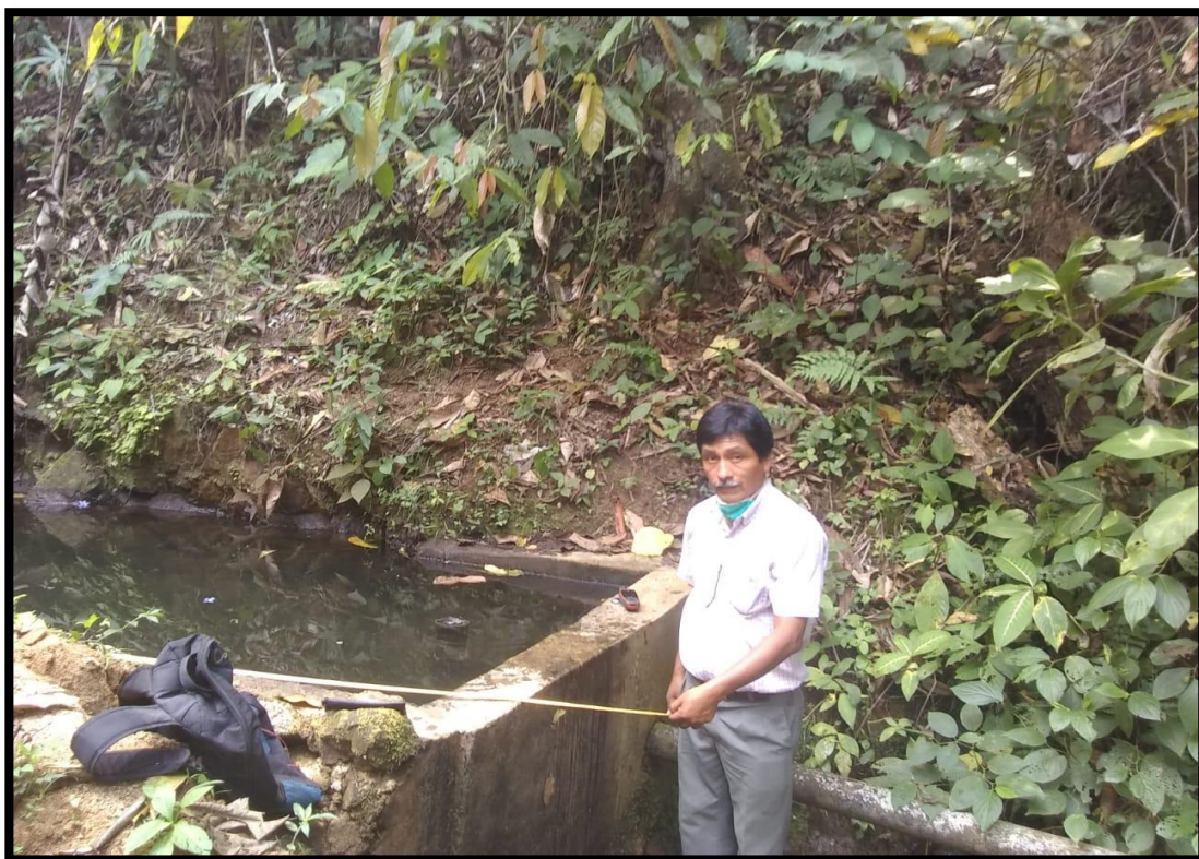
Figura 29: Estado de la captacion tipo ladera.
