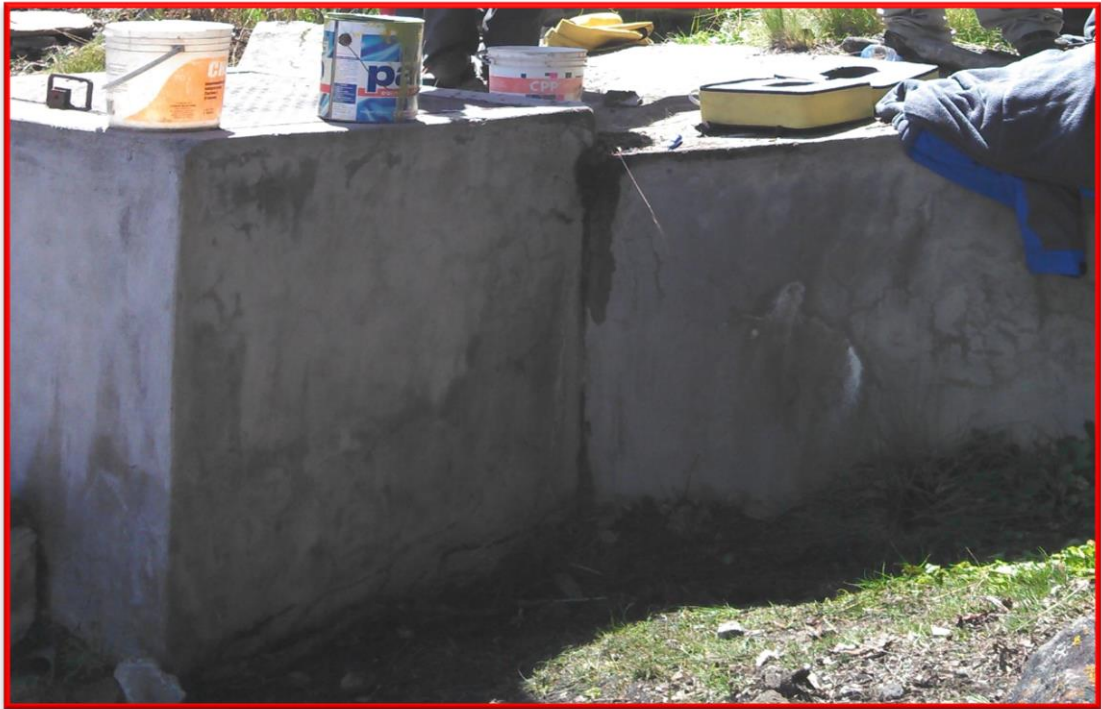
Fotografía 03: Vista de la cámara de captación 2.
