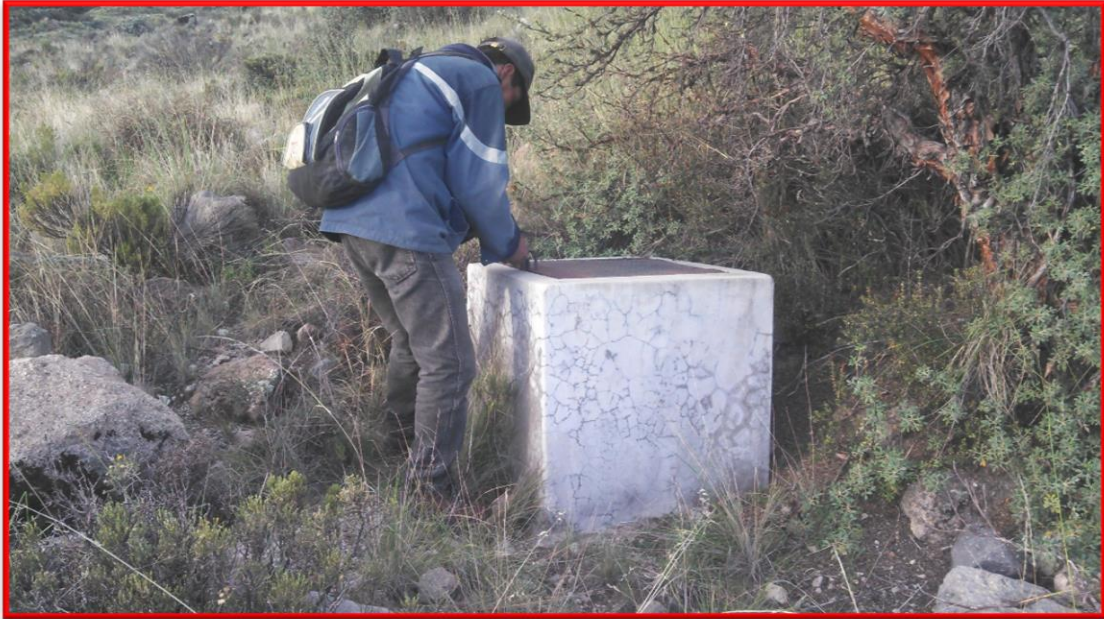
Fotografía 05: Se aprecia la cámara rompe presión tipo 6.
