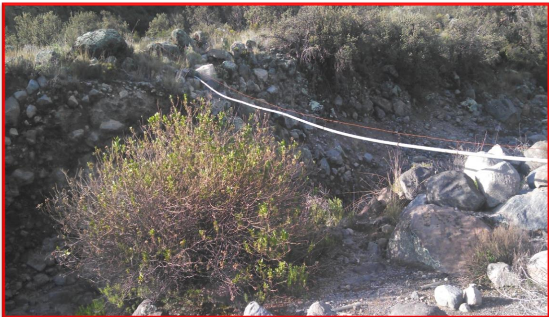
Fotografía 04: Se observa el pase aéreo en la línea de conducción.
