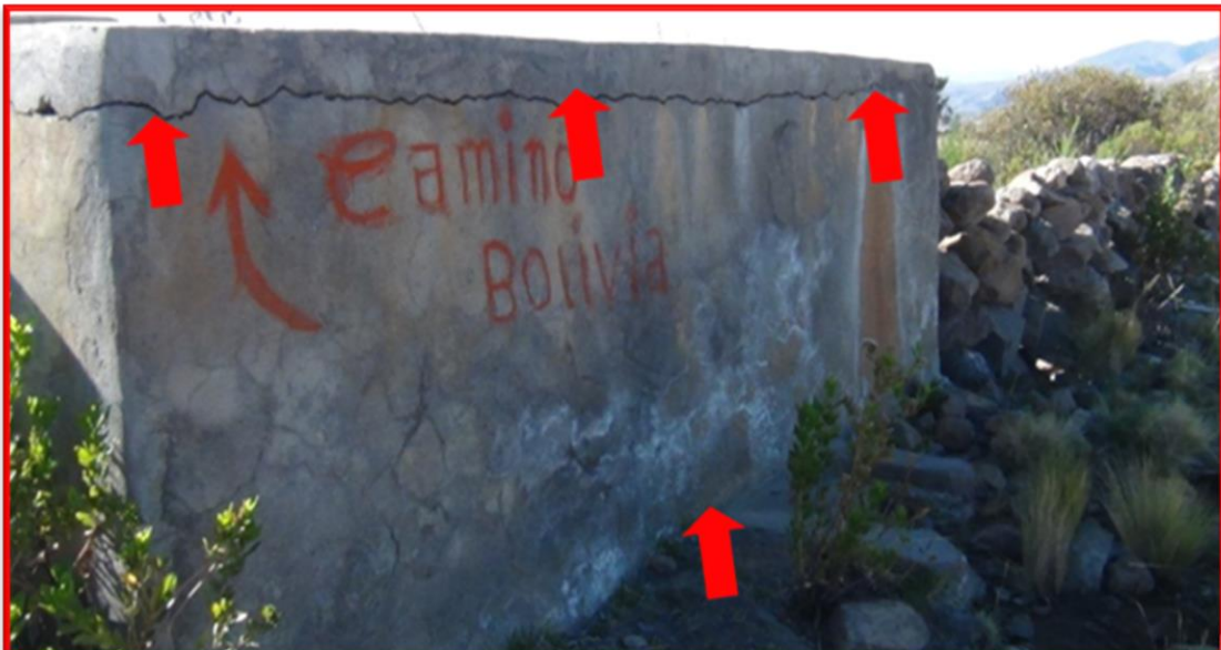
Fotografía 06: Se observa el reservorio de almacenamiento con presencia de grieta.
