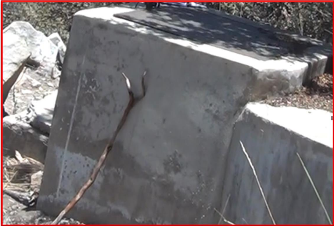
Fotografía 02: Vista de la cámara de captación 1.
