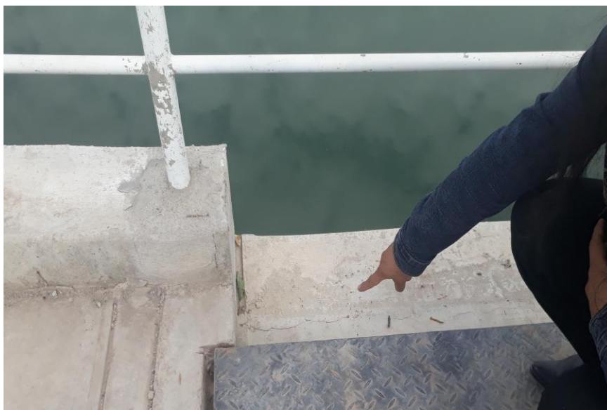
Se observa la fisura en la laguna
