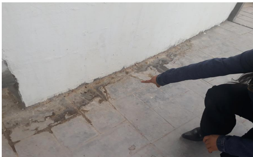
Se observa filtración en la construcción en la parte de los módulos
