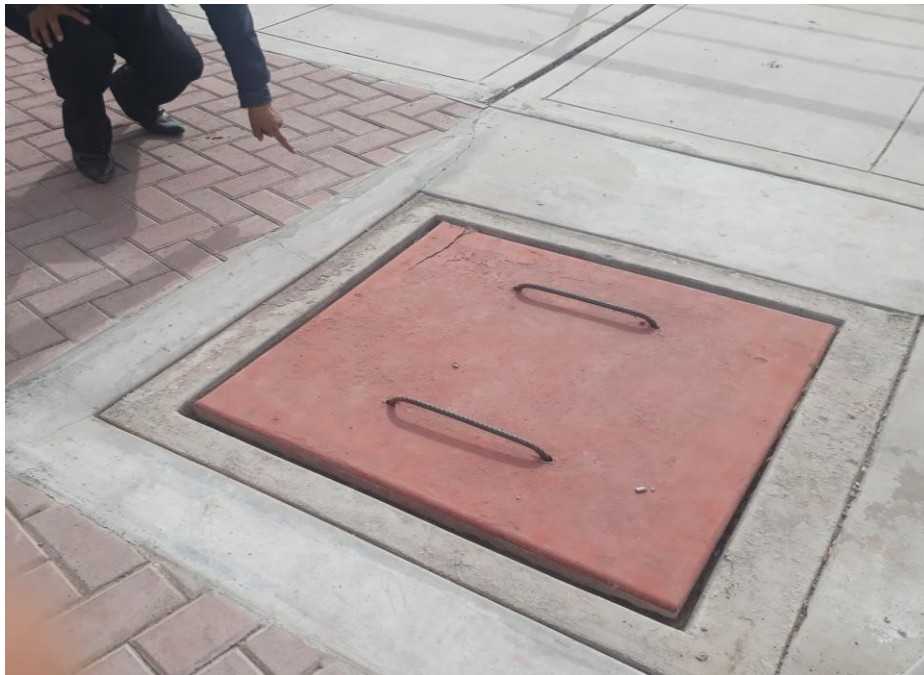
Se encuentra la patología de fisuras en la cascada
