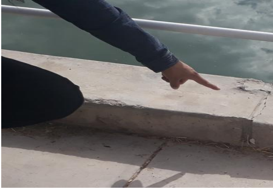
Se observa las patologías in situ a la construcción de la laguna
