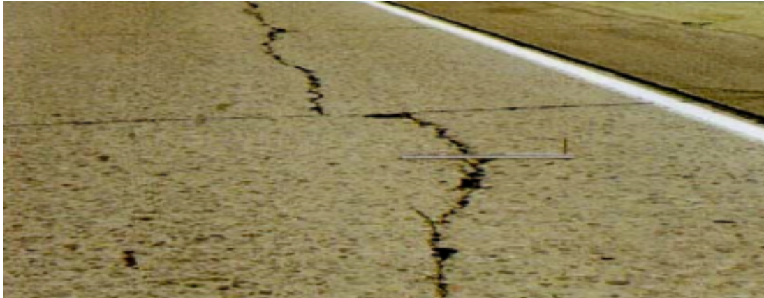
Figura 2.7: Fotografía de la presencia de falla real denominada "fisura longitudinal." Fuente:(AASHTO, 1993).
