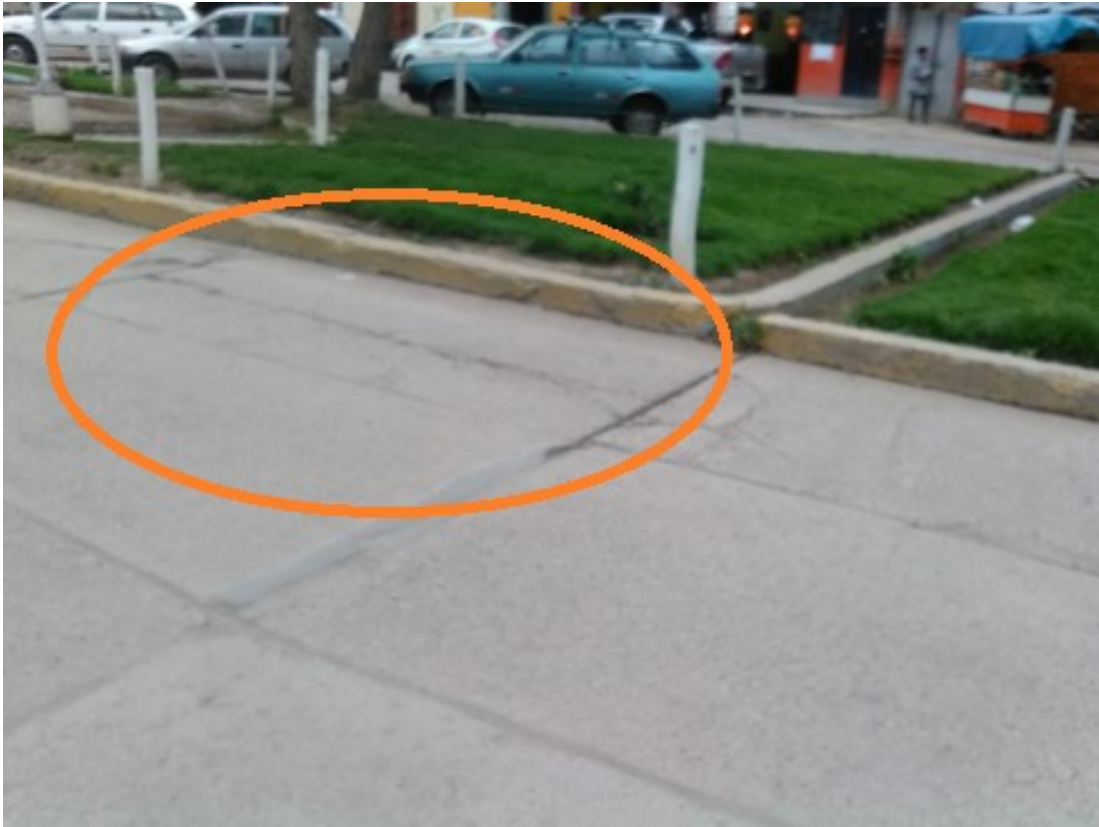
Fotografía 3: Patología denominada fisuras longitudinal.
