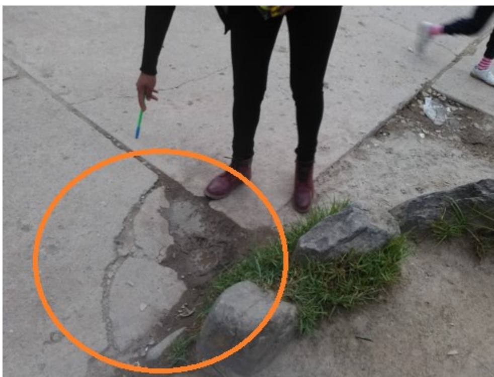
Fotografía 2: Patología denominada fisuras de esquina.
