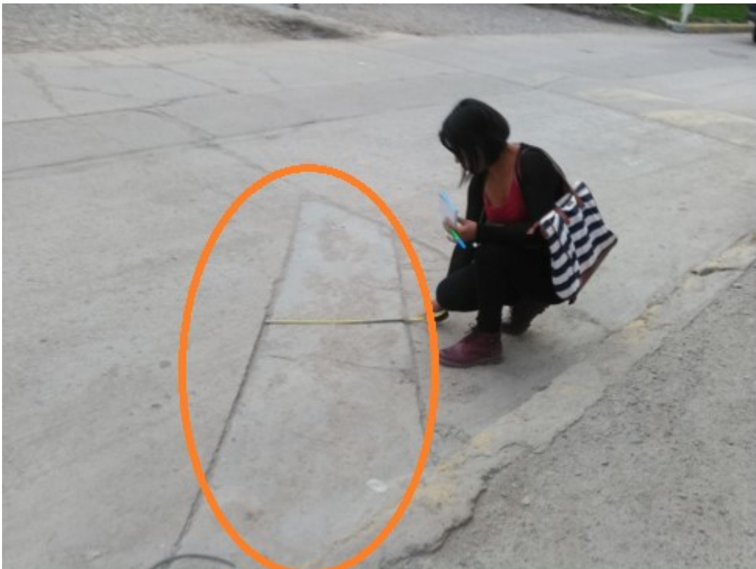
Fotografía 4: Patología denominada parcheo grande.
