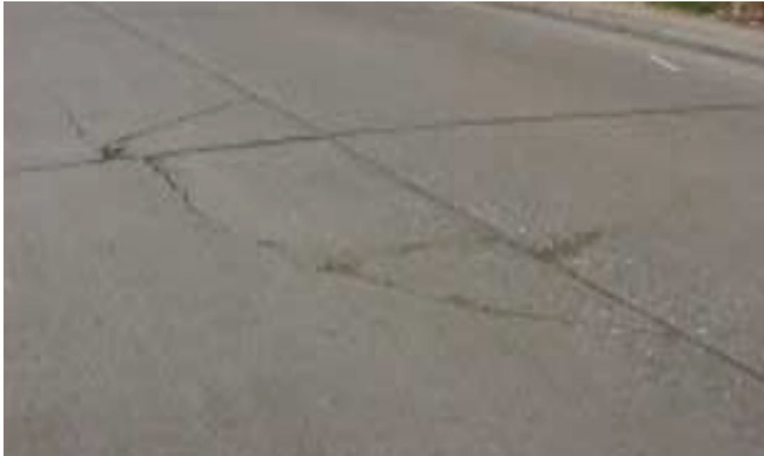
Figura 2.9: Fotografía de la presencia de falla real denominada " Fisura de esquina. Fuente:(AASHTO, 1993).
