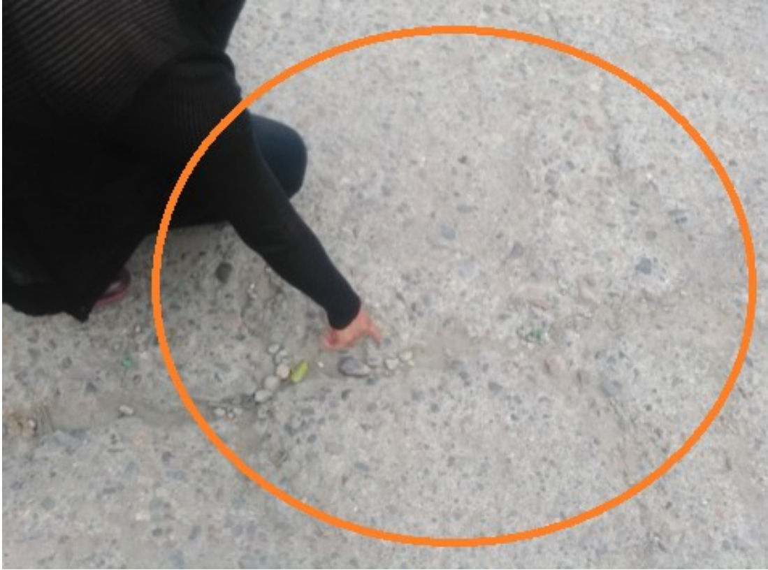
Fotografía 5: Patología denominada pulimiento de agregado 1.
