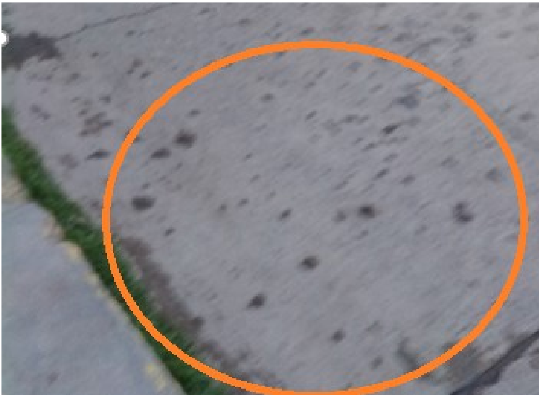
Fotografía 6: Patología denominada pulimiento de agregado 2.
