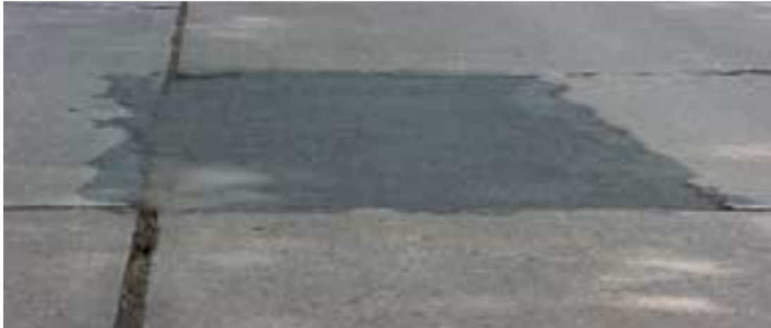
Figura 2.21: Fotografía de la presencia de falla real denominada ” Parchados y reparaciones para servicios públicos.
