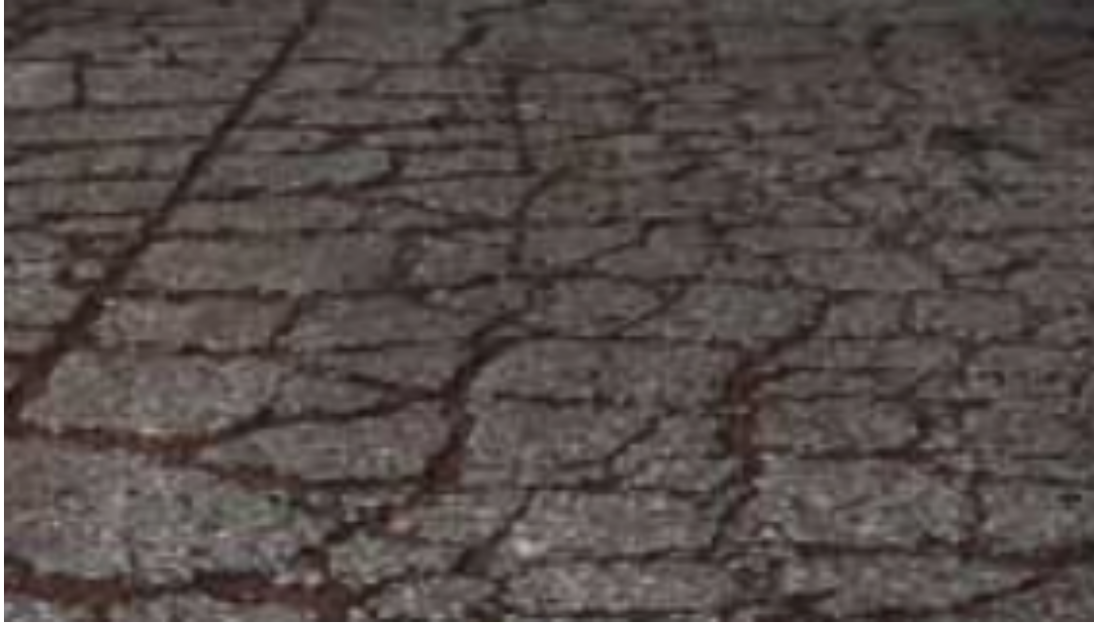
Figura 2.11: Fotografía de la presencia de falla real denominada "Fisura de losa subdividida." Fuente:(AASHTO, 1993).
