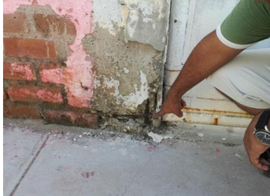
Gráfico 17: Oxidación y corrosión.
