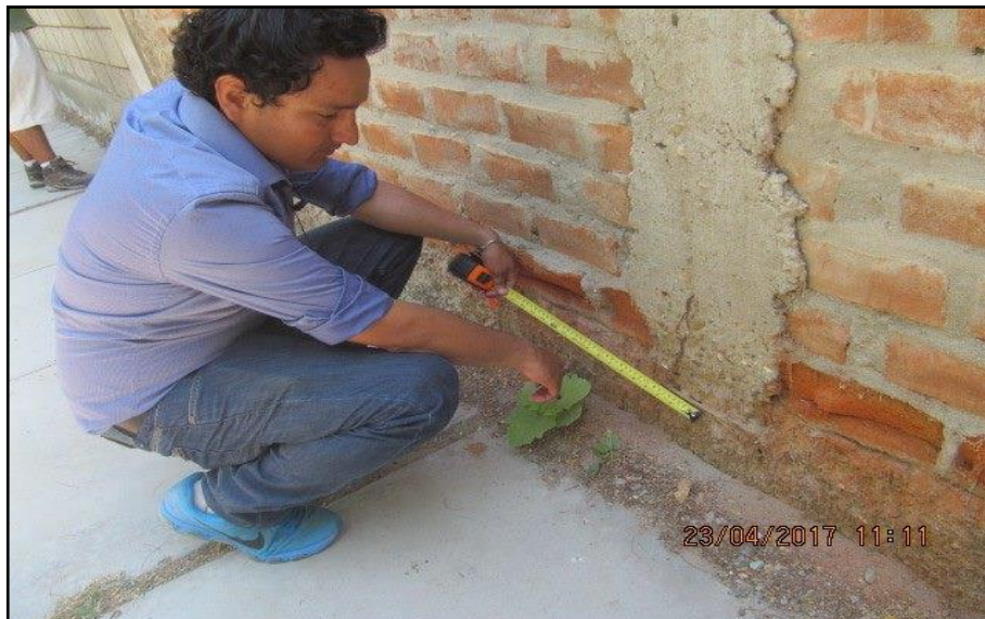
Gráfico 51: Presencia de eflorescencia en la parte inferior del muro en la unidad de muestra 6.
