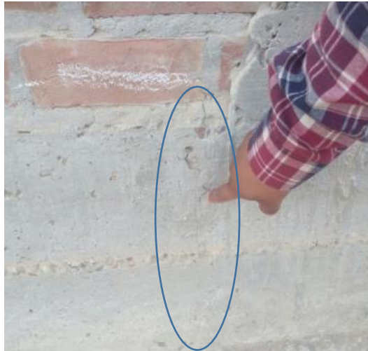
Gráfico 13: Fisura en el sobrecimiento.
