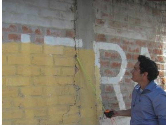
Gráfico 12: Grieta entre la columna y muro de albañilería.
