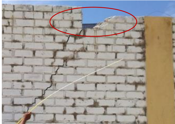
Gráfico 14: desprendimiento del ladrillo.
