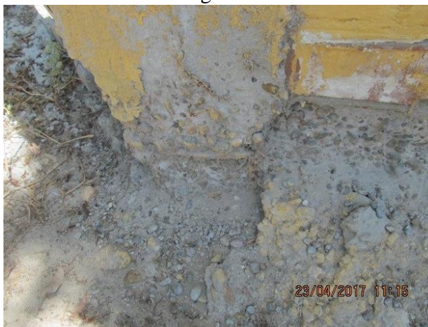
Gráfico 7: Patologías en el concreto.
