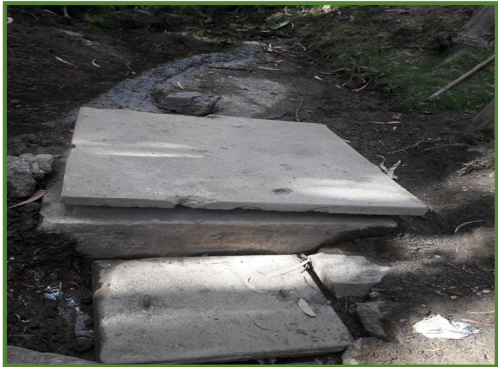
Imagen 01. La protección de afloramiento de la captación está en mal estado y en la cámara húmeda no cuenta con aletas.
