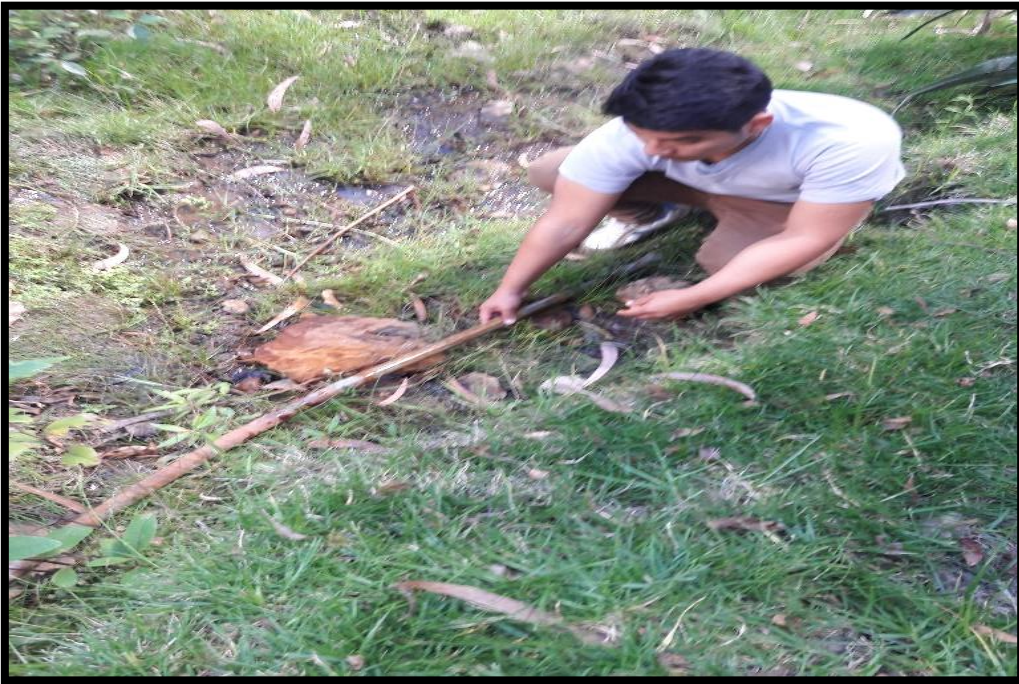
Imagen 19. Tubería de la línea de conducción
