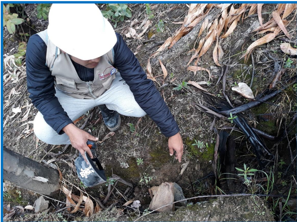
Imagen 08. Línea de aducción expuesta a peligros de la zona
