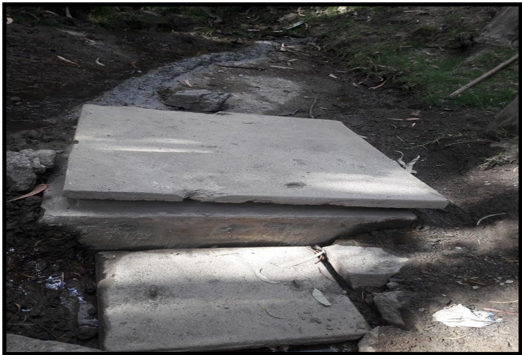
Imagen 18. Captación Nueva Esperanza (protección de afloramiento, cámara húmeda y seca deterioradas)
