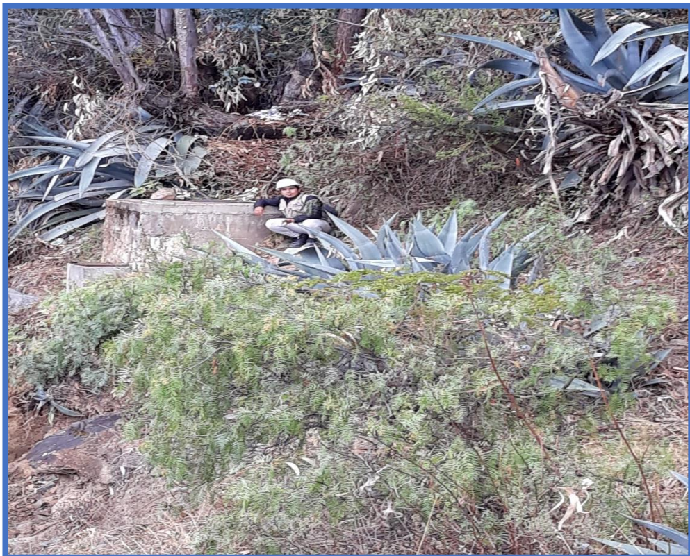
Imagen 16. Cámara rompe presión tipo 7 (vista panorámica)
