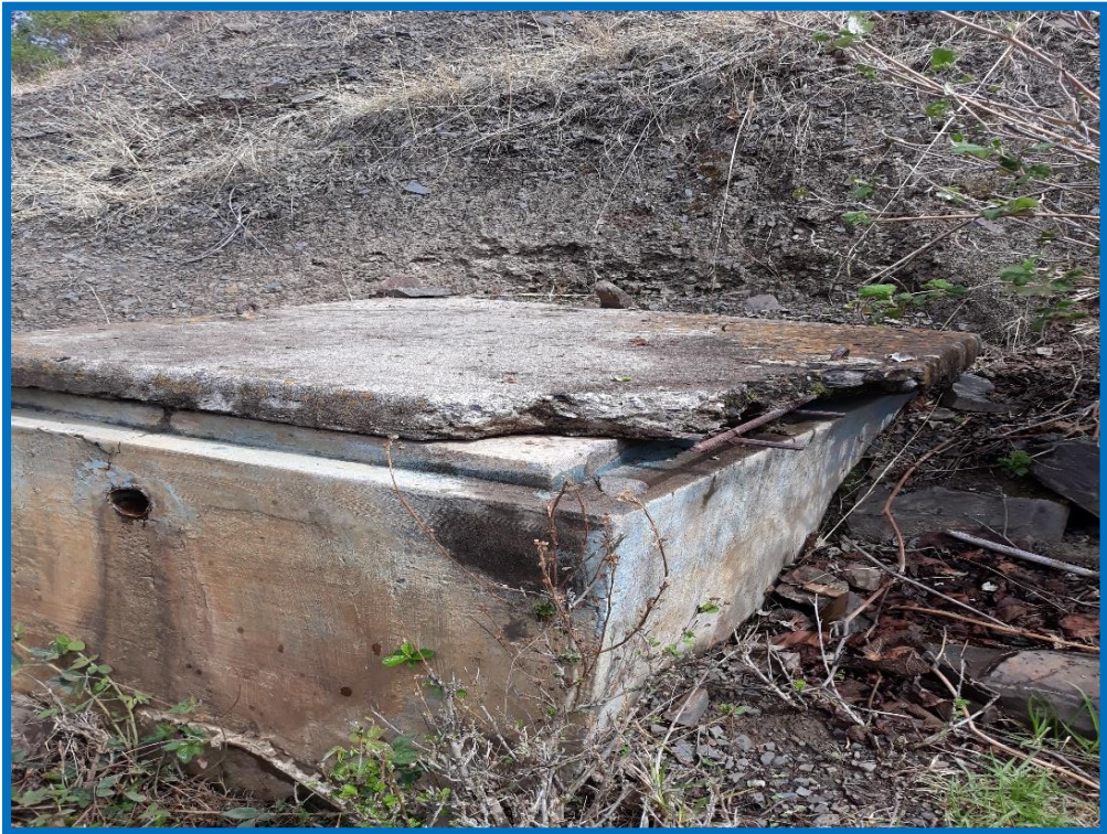
Imagen 13. Estructura de la Cámara rompe presión tipo 6 deteriorada.
