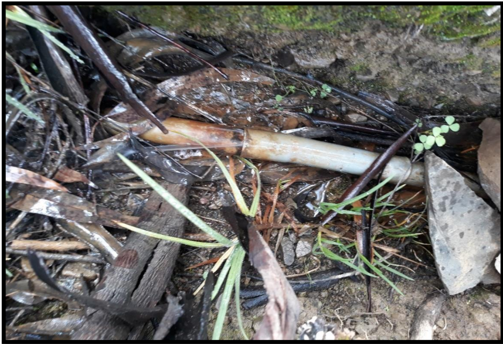
Imagen 21. Tubería de la línea de aducción
