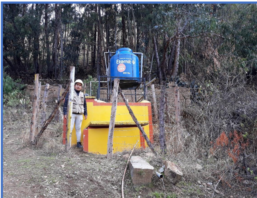
Imagen 05. Cerco perimétrico rustico del reservorio de almacenamiento
