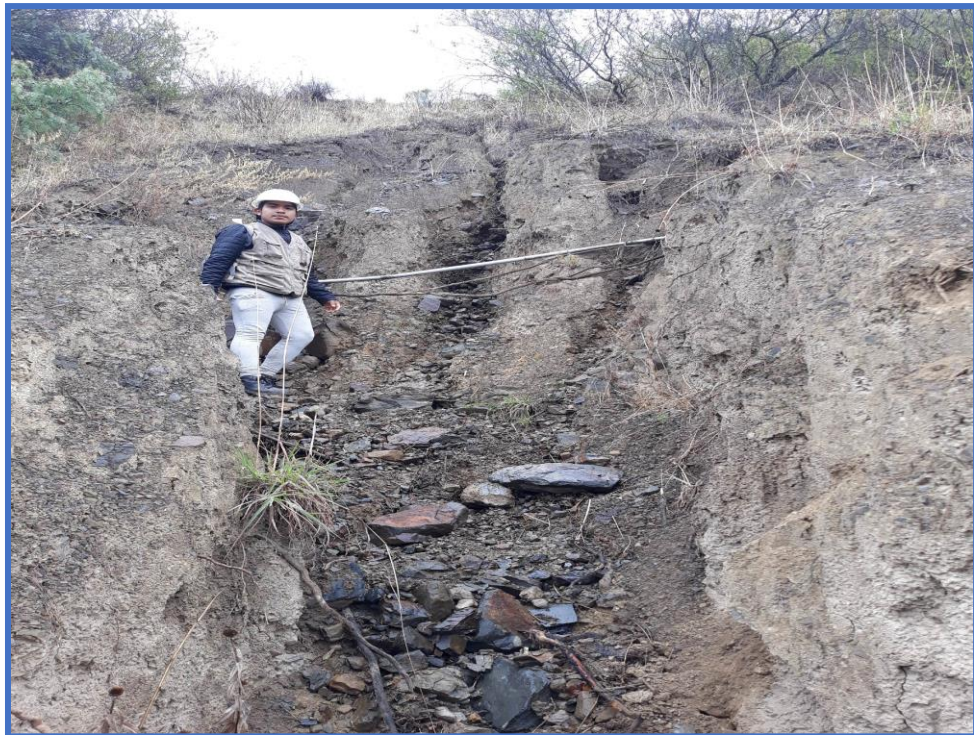
Imagen 04. Línea de conducción tramo 2 expuesta a la intemperie
