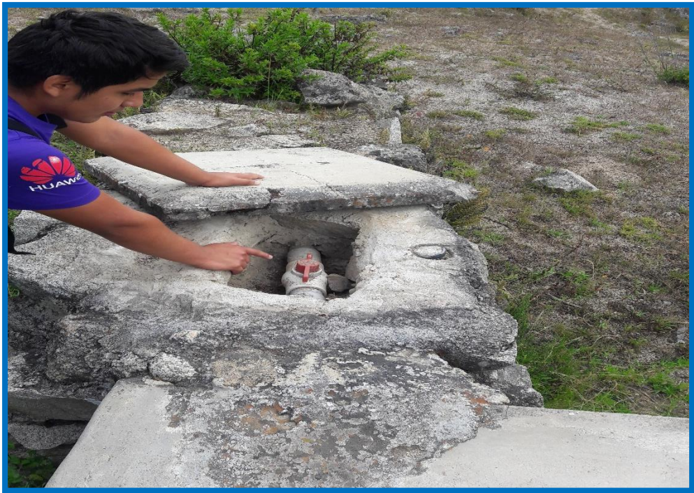
Imagen 11. Válvulas de control de la red expuesta a la intemperie cubierta solamente con una caja de concreto.
