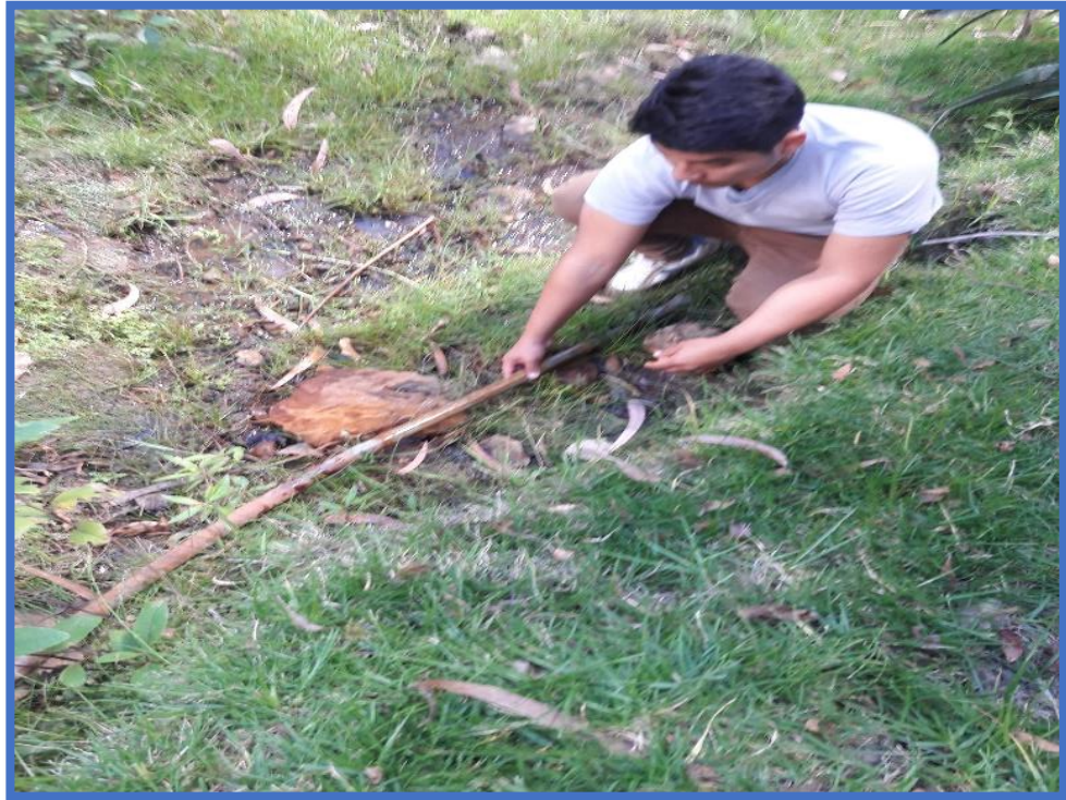
Imagen 03. Línea de conducción tramo 1 expuesta a la intemperie
