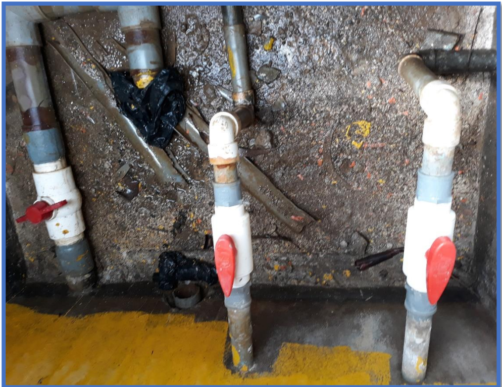
Imagen 07. Accesorios de la caseta de válvulas del reservorio
