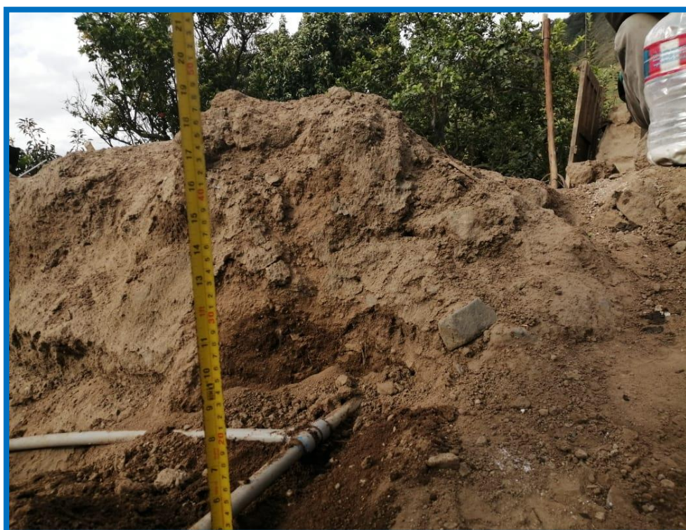
Imagen 10. Red de distribución expuesta a la intemperie (tubería secundaria)
