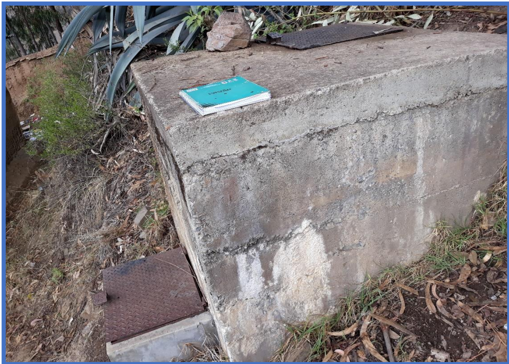
Imagen 15. Cámara rompe presión tipo 7 en malas condiciones
