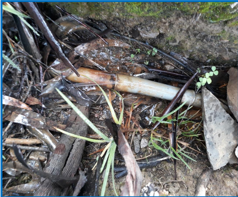
Imagen 07. Patologías presentadas en la tubería de la línea de aducción
