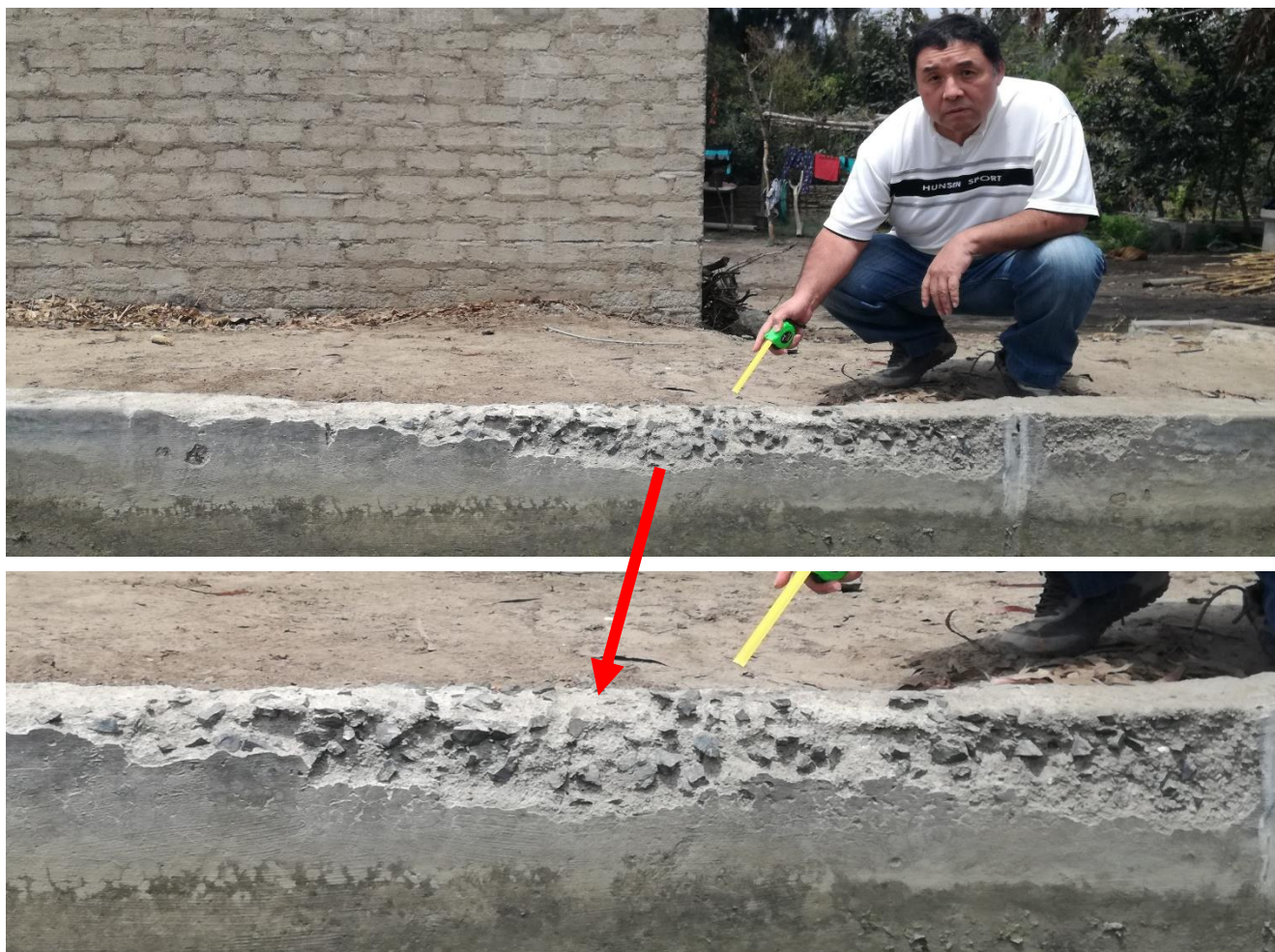
Figura 132. Daño por desagregación, ubicado en la unidad de muestra 09. Fuente: Elaboración propia – 2020.
