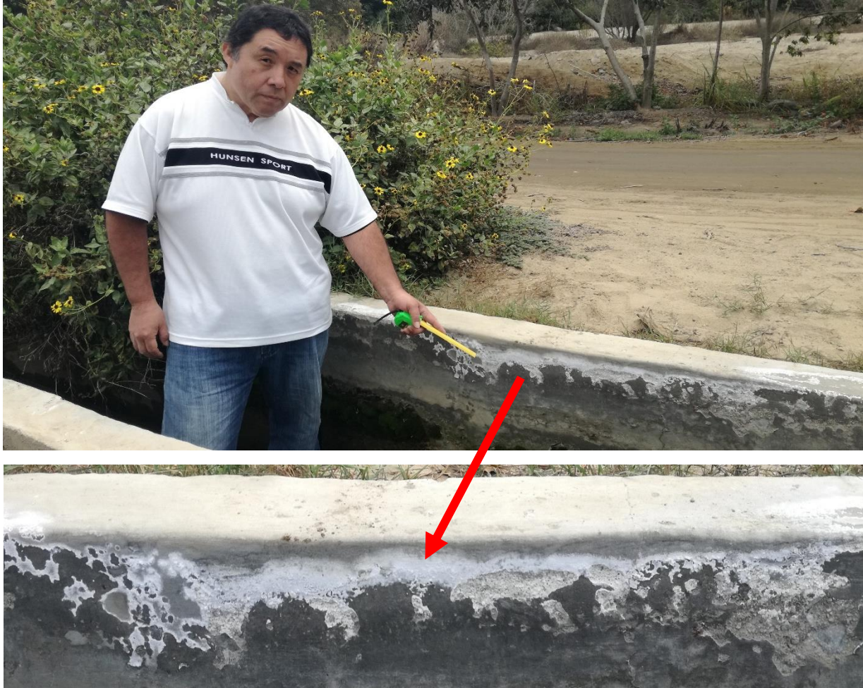
Figura 133. Daño por eflorescencia, ubicado en la unidad de muestra 03.
