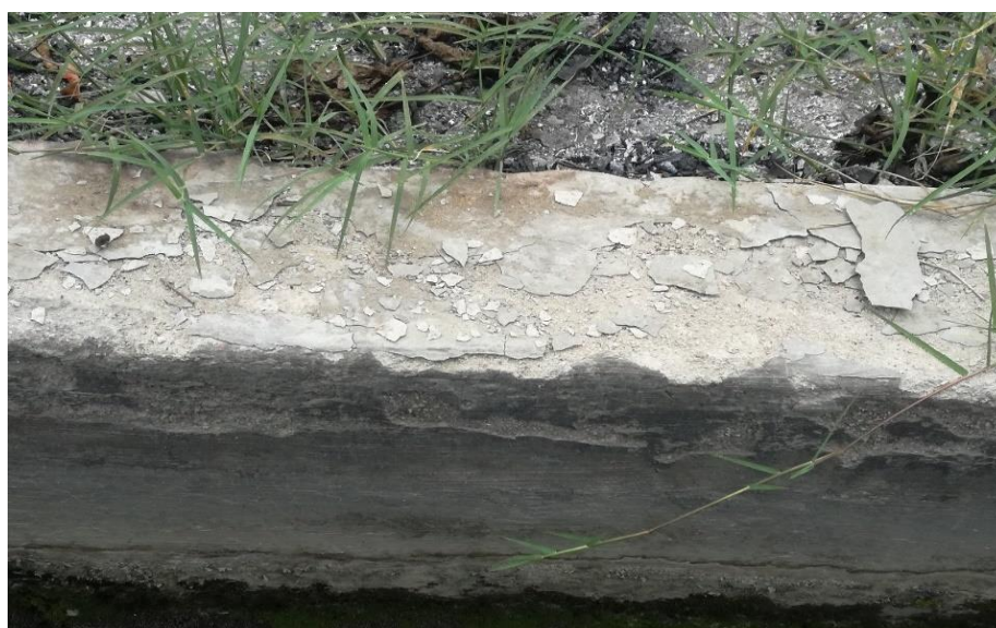
Figura 28. Desagregación en el canal sub lateral B-24. Fuente: Elaboración propia – 2020.
