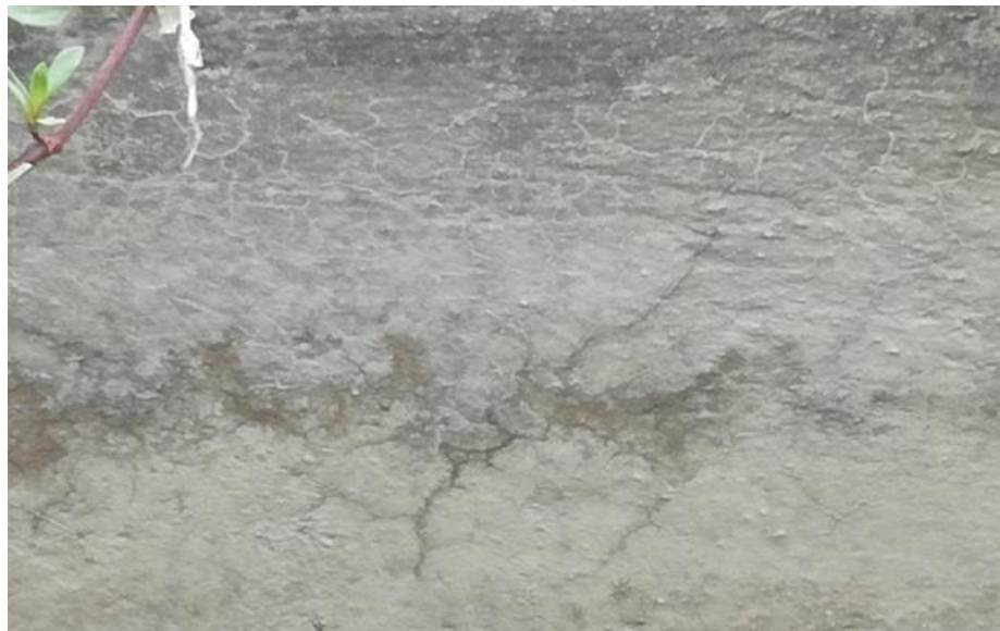
Figura 23. Fisuras en paredes del canal sub lateral B-24 Fuente: Elaboración propia – 2020.
