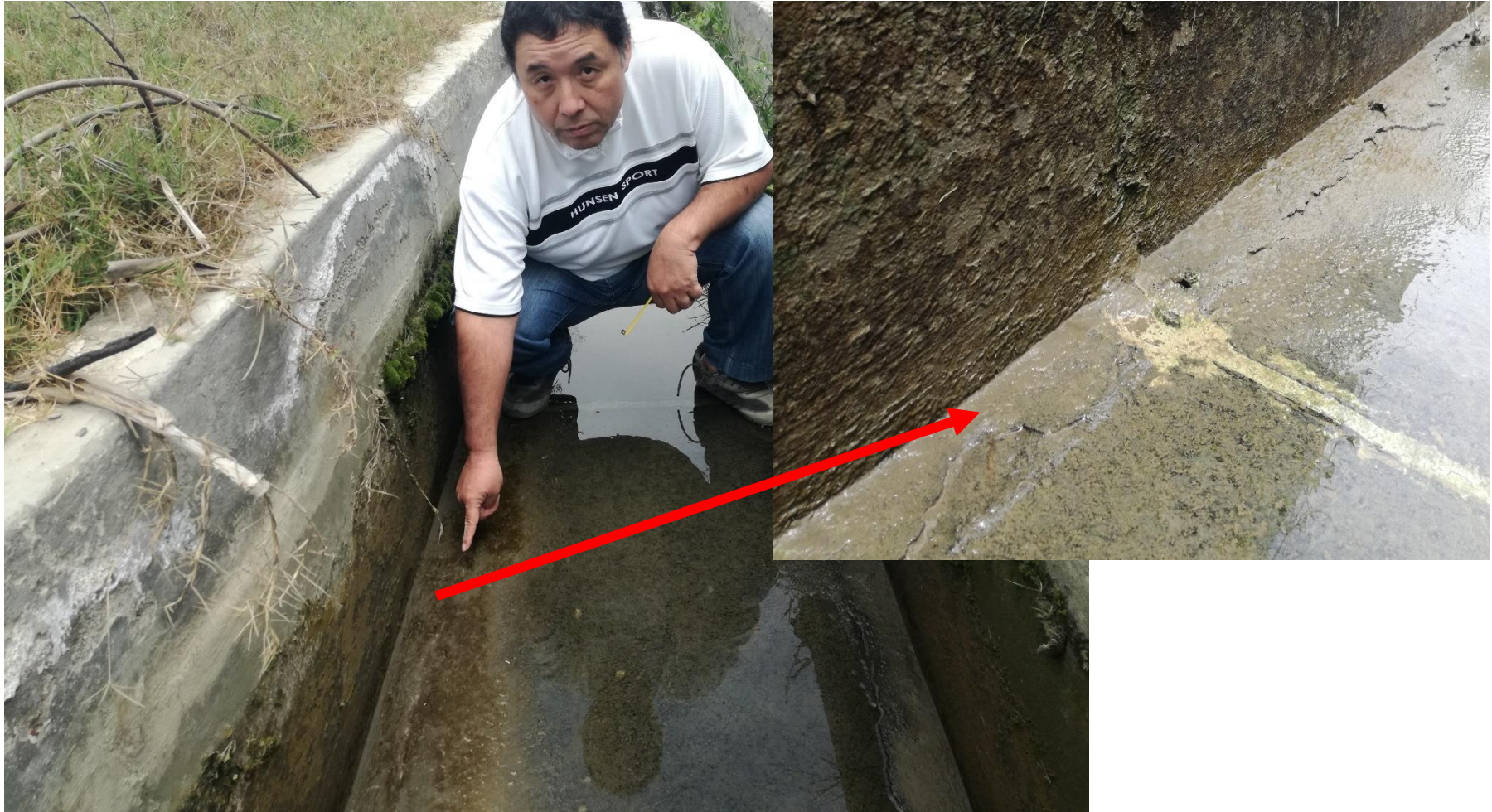
Figura 136. Daño por sedimentación, ubicado en la unidad de muestra 14. Fuente: Elaboración propia – 2020.
