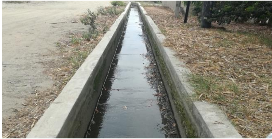
Figura 29. Sedimentación en el canal sub lateral B-24. Fuente: Elaboración propia – 2020.
