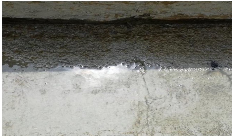
Figura 30. Erosión en el fondo del canal sub lateral B-24. Fuente: Elaboración propia – 2020.
