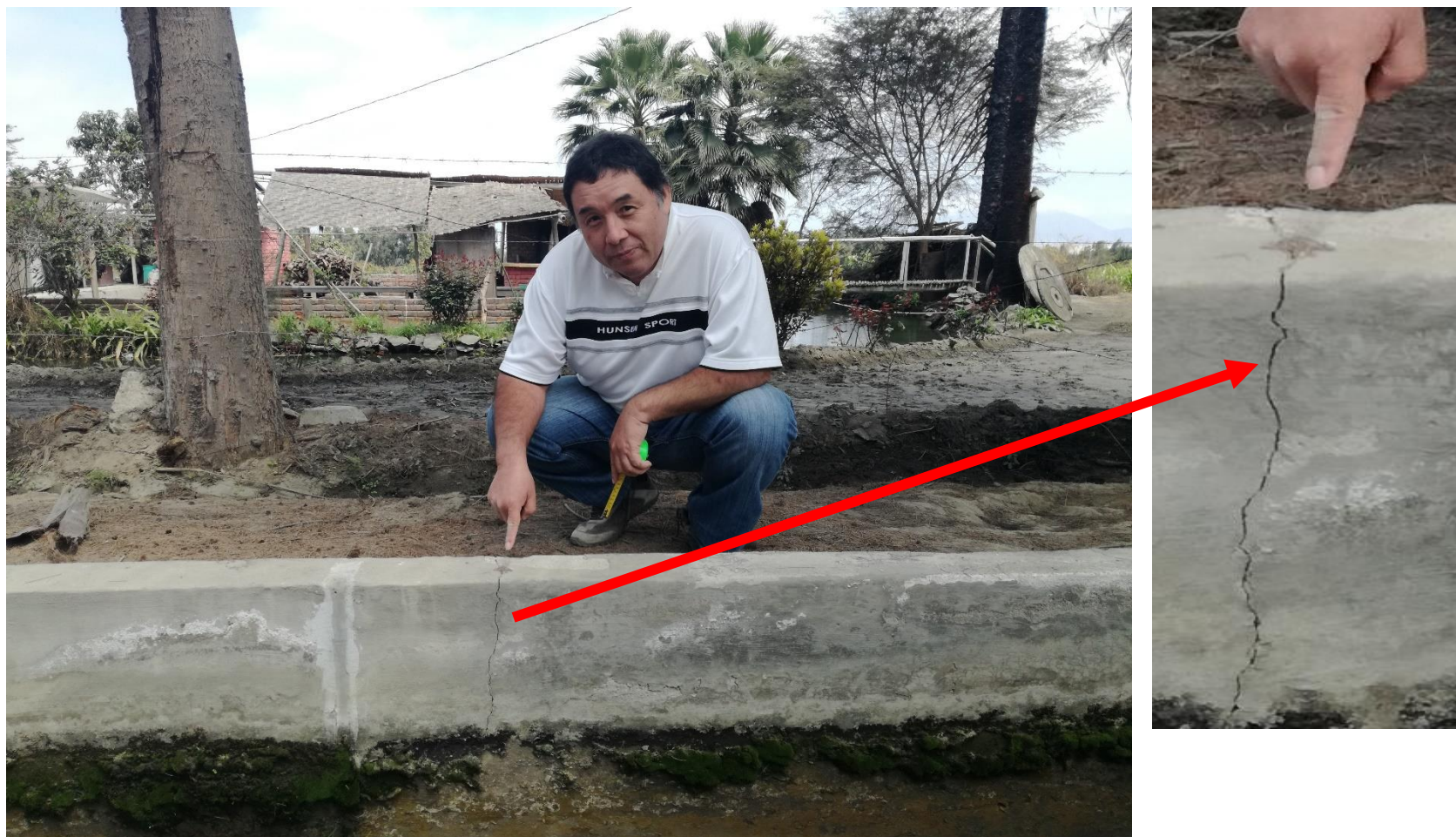
Figura 130. Daño por grieta, ubicada en la unidad de muestra 11.
