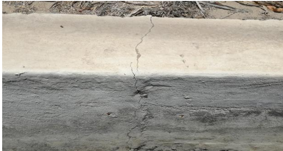
Figura 22. Grieta en el canal sub lateral B-24. Fuente: Elaboración propia – 2020.
