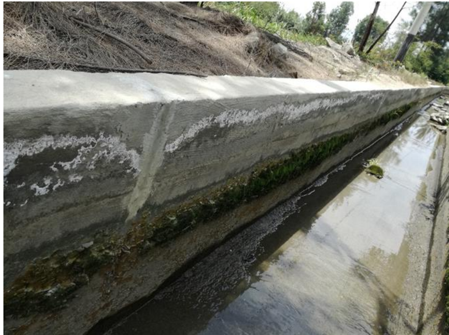
Figura 25. Eflorescencias en el canal sub lateral B-24. Fuente: Elaboración propia – 2020.
