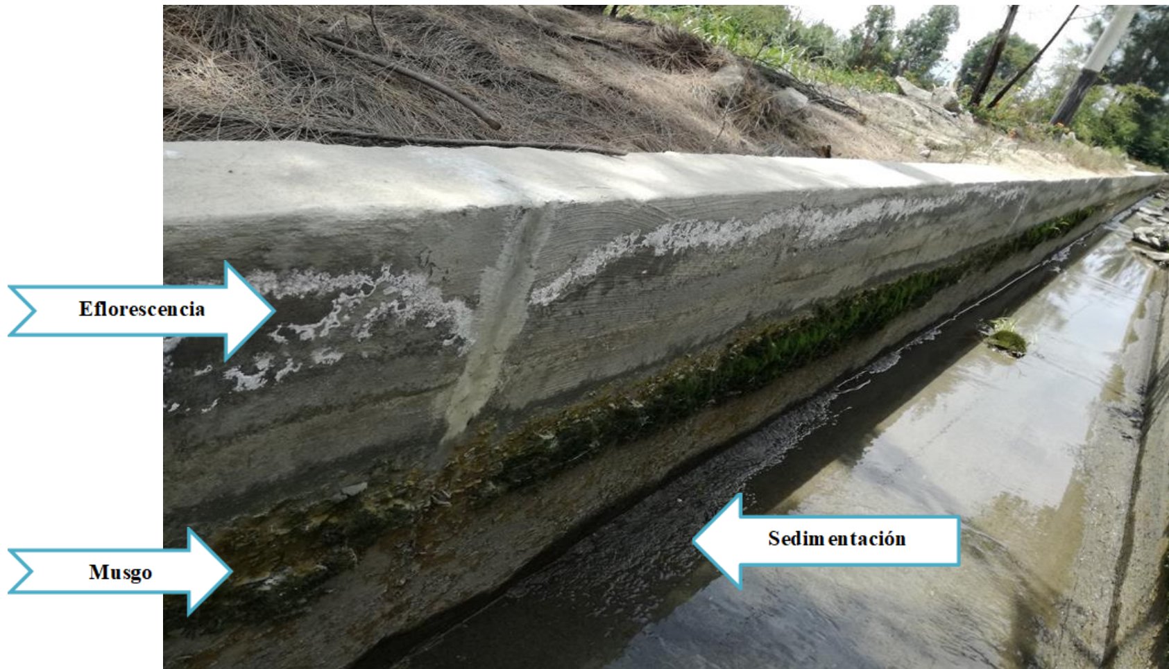
Figura 129. Daños por eflorescencia, musgo y sedimentación en el canal sub lateral B-24.
