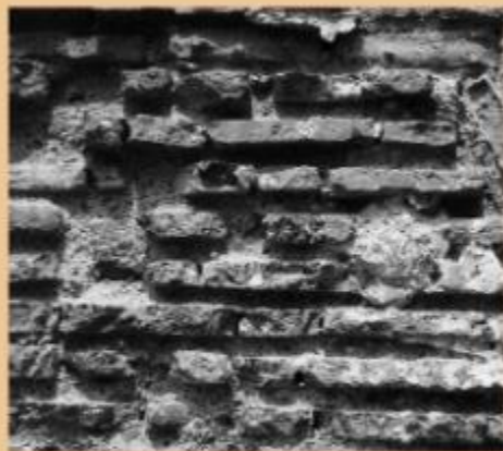
Erosión mecánica de las partículas que transporta el viento sobre el mortero de agarre de este muro de ladrillos.
