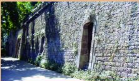
Proliferación de vegetales en muros de piedra. La fuerza de las raíces y la retención de humedad causan roturas, grietas y manchas respectivamente.
