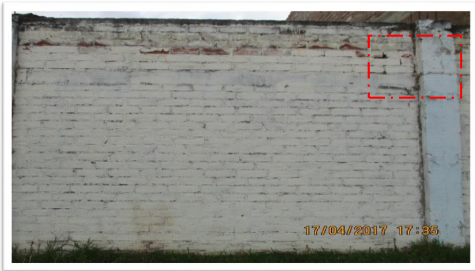
Determinación de fisura en la UM 06 de la losa deportiva de Tarica
