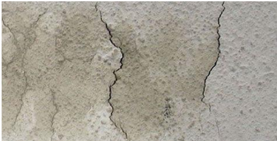
Figura 10: Fisuras en muros
