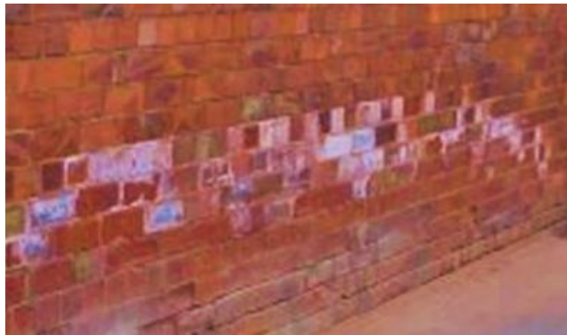
Figura 15: Eflorescencia en muros
