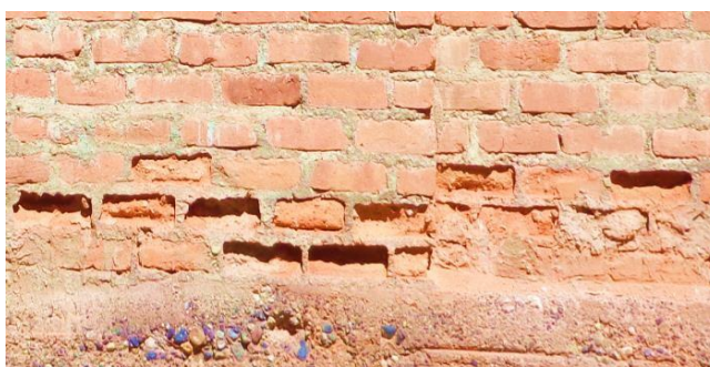
Figura 08: Heladicidad en muros
