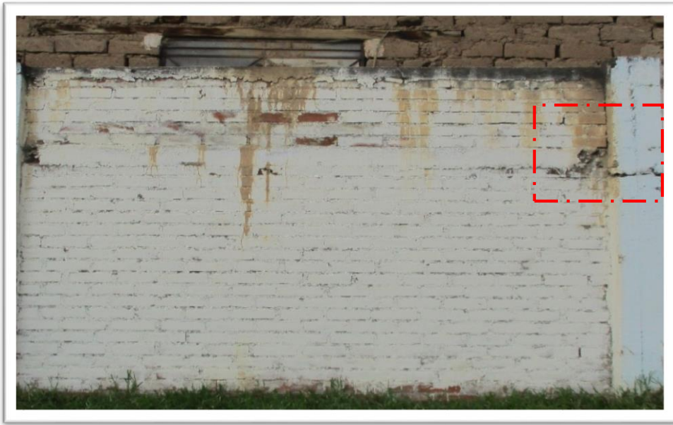
Determinación de grieta en la UM 05 de la losa deportiva de Tarica
