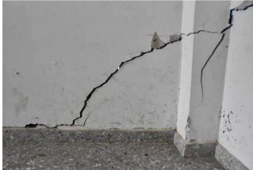
Figura 11: Grieta en muros
