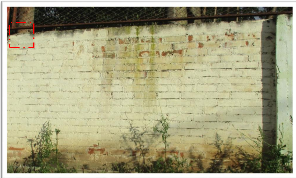
Determinación de corrosión en la UM 04 de la losa deportiva de Tarica
