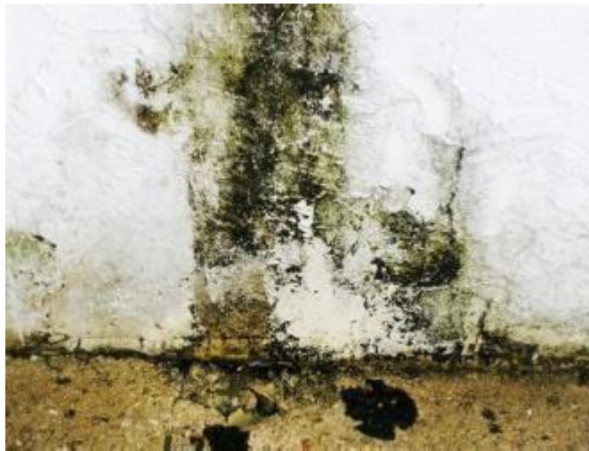
Figura 13: Mohos en muros
