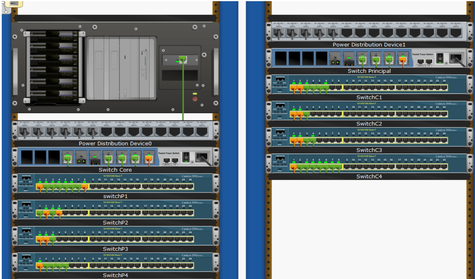
Ilustración Nro. 11: Esquema tentativo de los Centro de Datos del Hospital Base Huánuco
