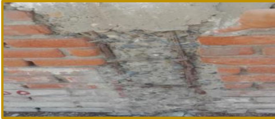
Imagen 23: Corrosión en columna confinada.
