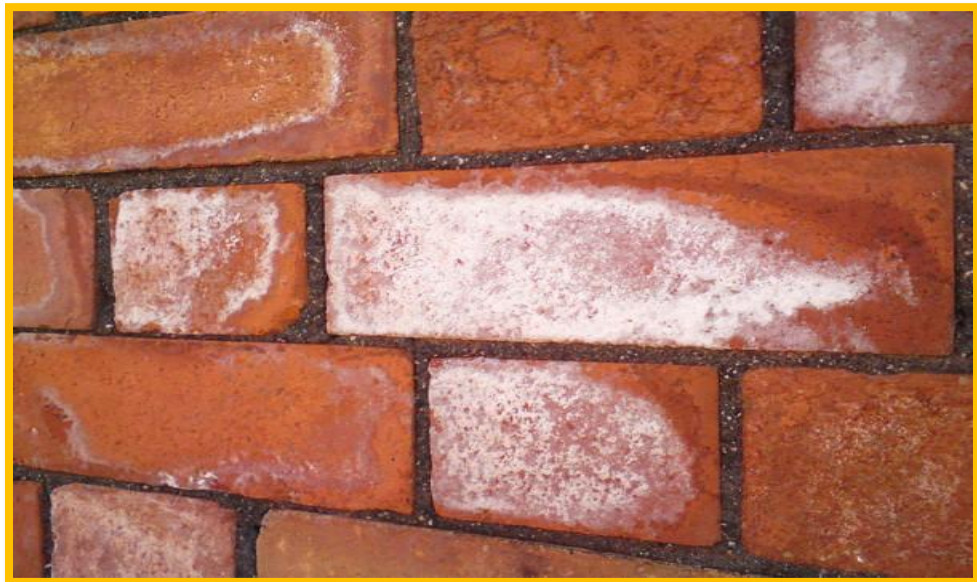
Imagen 20: Eflorescencia en muro de albañilería.
