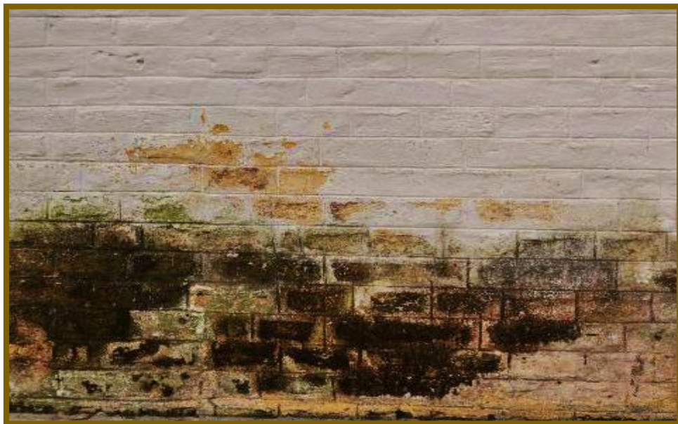
Imagen 19: Moho en muro de albañilería.
