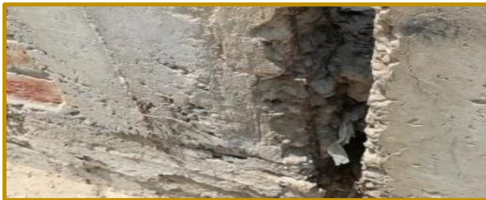
Imagen 22: Oxidación en columna de concreto armado.
