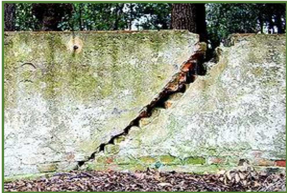
Imagen 18: Grieta en muro de albañilería.
