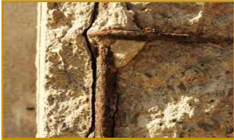
Imagen 21: Varilla de acero afectada por oxidación y corrosión en columna.
