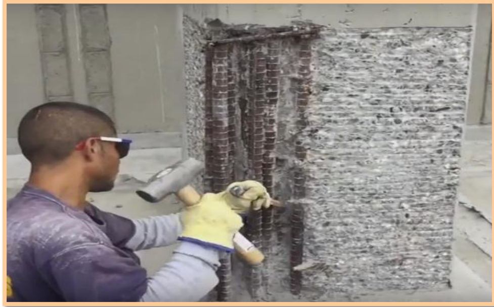
Imagen 24: Alternativa de Reparación para oxidación de varillas de acero en columna.
