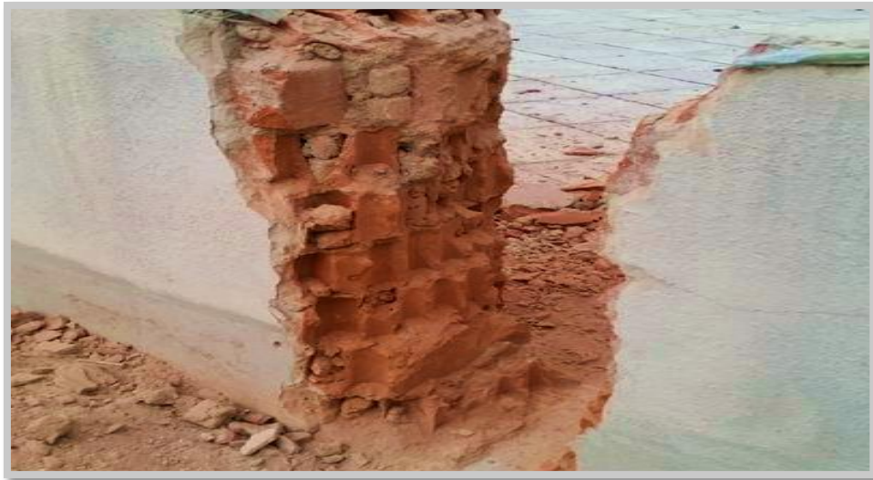
Imagen 16: Erosión Mecánica en muro de albañilería.
