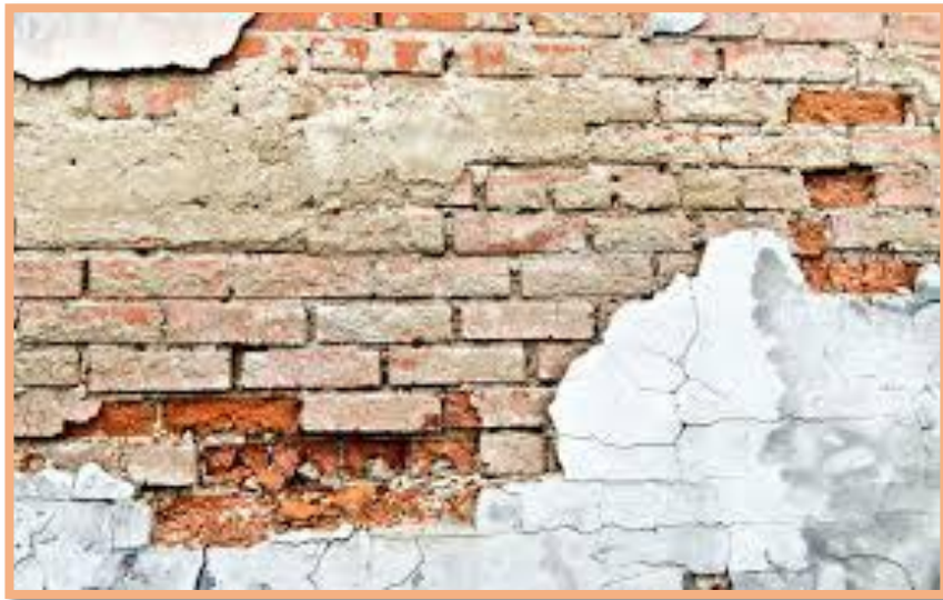
Imagen 15: Erosión Física en muro de albañilería.
