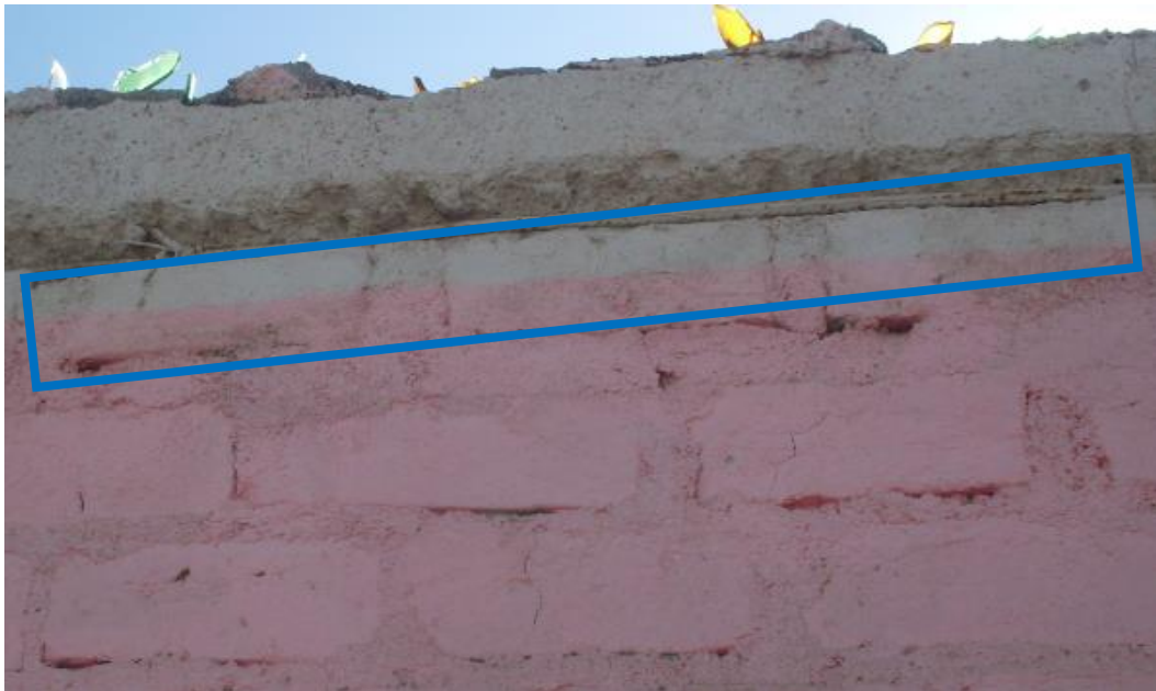
Fotografía 06: Oxidación del acero en viga en la unidad de muestra 06, del cerco perimétrico de la institución educativa José Abelardo Quiñones.
