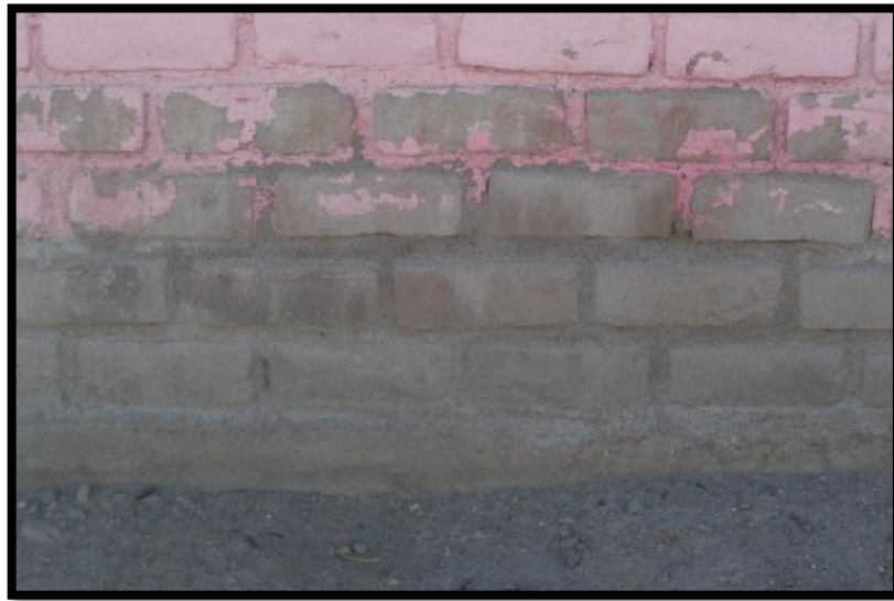
Figura 05. Erosión en muro
