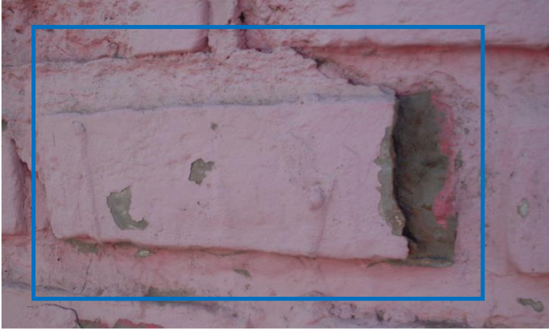
Fotografía 07: Desprendimiento en muro en la unidad de muestra 07, del cerco perimétrico de la institución educativa José Abelardo Quiñones.
