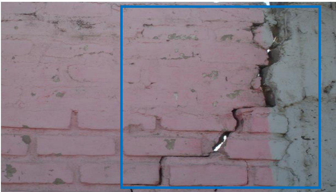
Fotografía 04: Grieta en muro en la unidad de muestra 02, del cerco perimétrico de la institución educativa José Abelardo Quiñones.
