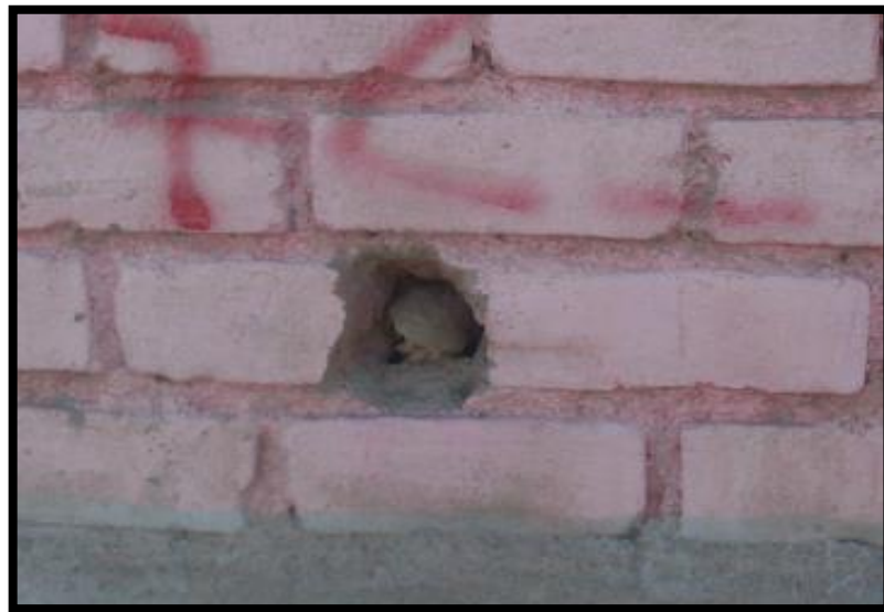
Figura 06: Picadura en muro
