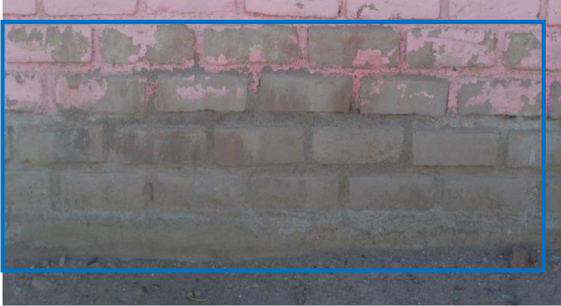
Fotografía 09: Erosión en muro en la unidad de muestra 05, del cerco perimétrico de la institución educativa José Abelardo Quiñones.
