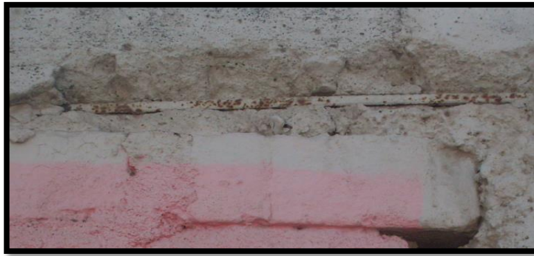
Figura 09: Oxidación en el acero.
