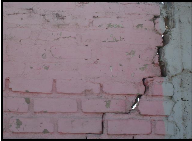
Figura 08. Grieta en muros
