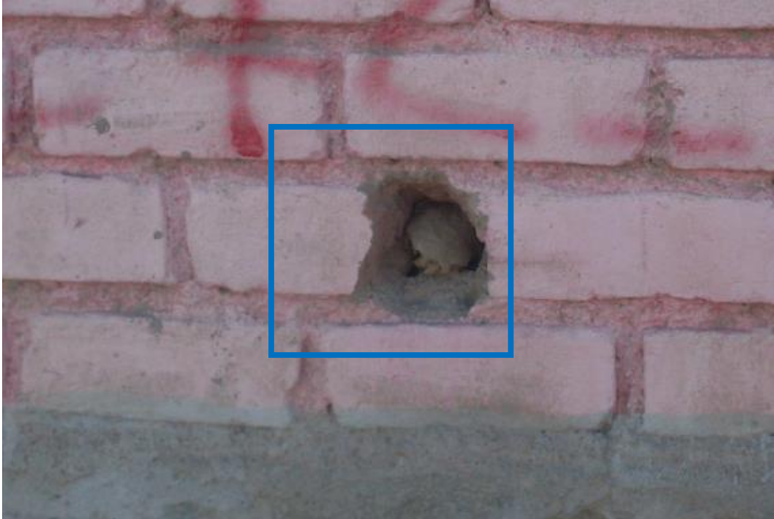
Fotografía 03: Picadura en muro en la unidad de muestra 01, del cerco perimétrico de la institución educativa José Abelardo Quiñones.
