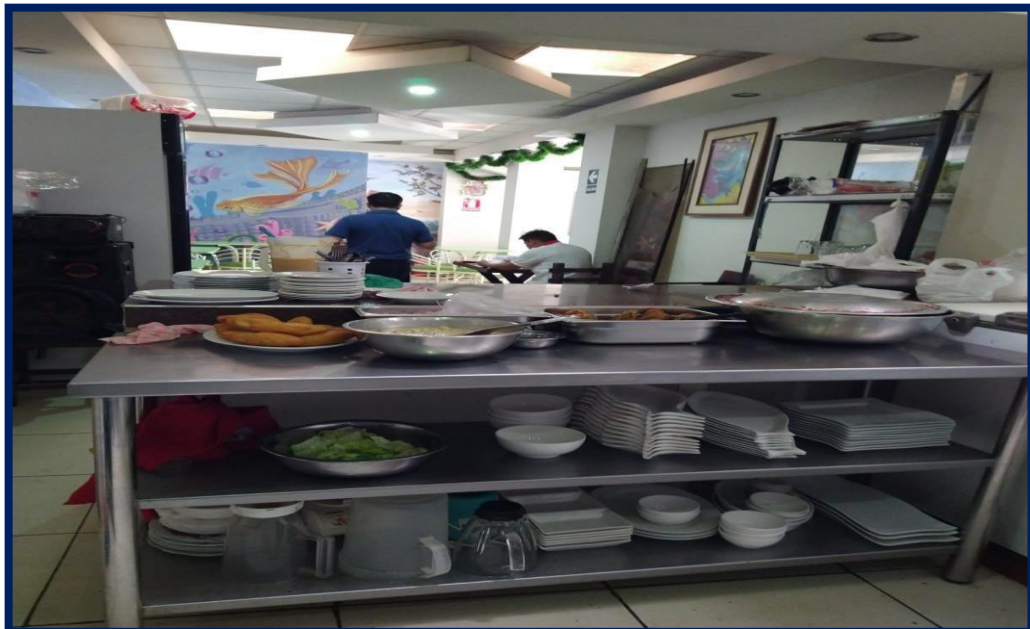
Imagen 02: vista frontal del área de cocina luego de los trabajos de remodelación.
