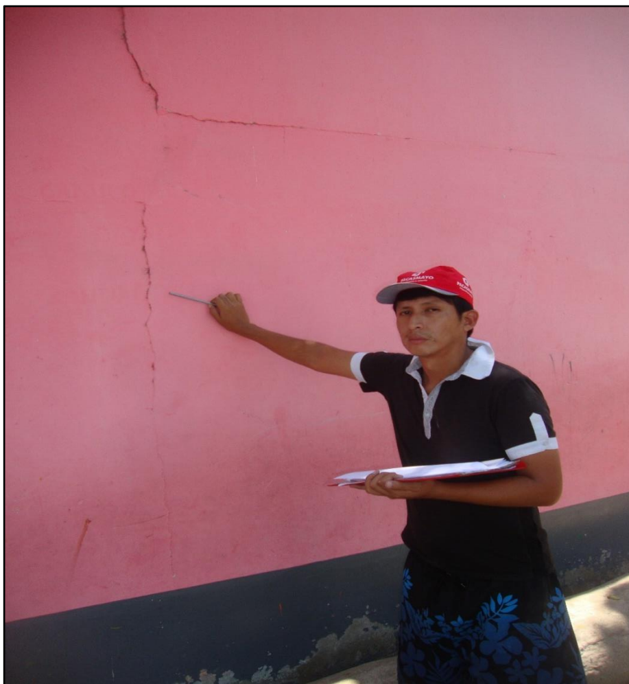
Determinación de fisura vertical en la UM 13 de la I.E 304.
