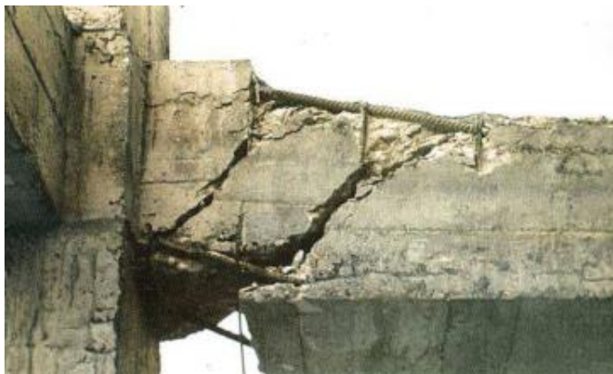
Figura 55. Falla por cortante en viga Nota. Fuente: (Navarro y Pino) 60
