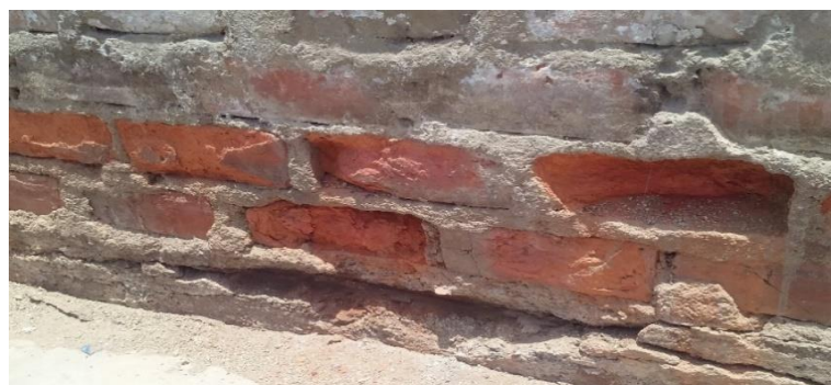
Figura 48. Erosión química en muro de albañilería Nota. Fuente: (Elaboración Propia)
