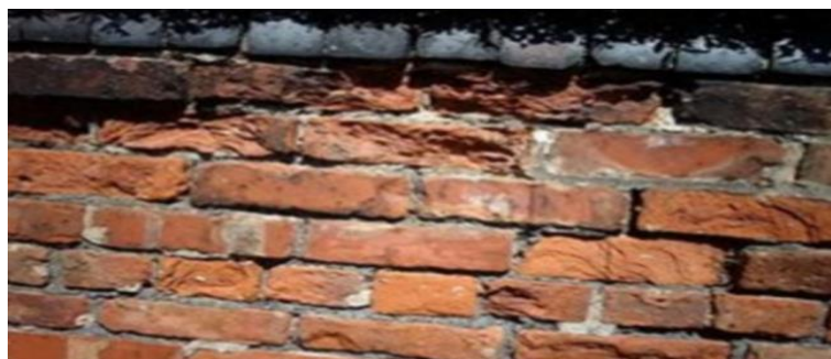
Figura 41. Erosión física ligada a desgastes Nota. Fuente: (Méndez) 58
