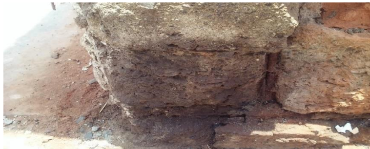
Figura 47. Acero de columna corroído Nota. Fuente: (Elaboración Propia)
