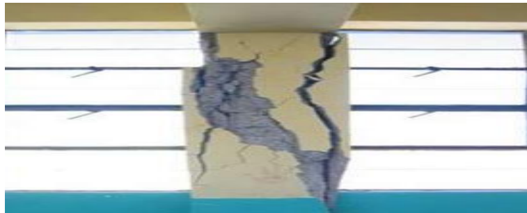
Figura 36. Columna afectada por un sismo Nota. Fuente: (Mata) 53
