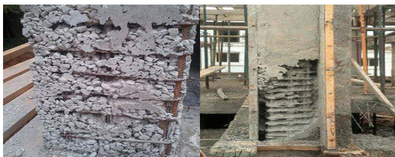
Figura 32. Perdida de mezcla o poco recubrimiento Nota. Fuente: (Pinterest) 52
