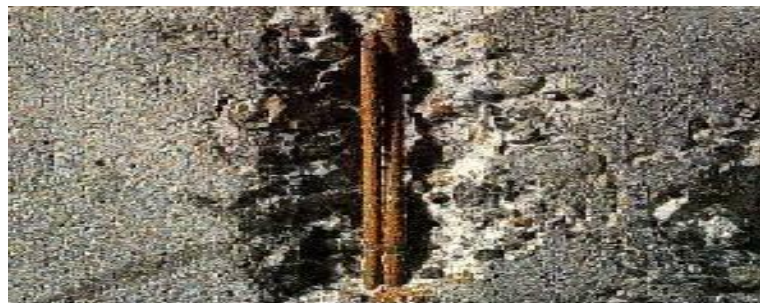
Figura 59. Oxidación del acero
