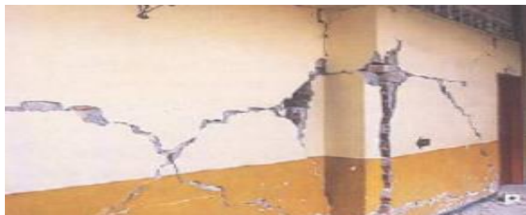
Figura 33. Estructura afectada por un sismo
