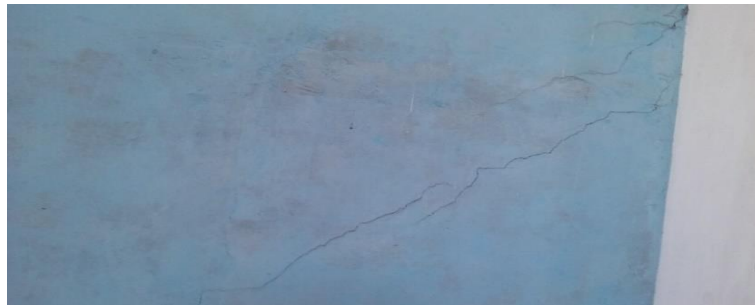
Figura 43. Fisura en muro de albañilería
