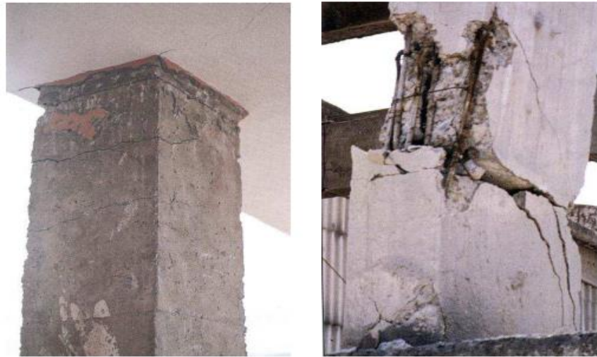
Figura 50. Rotura por flexión en columna Nota. Fuente: (Navarro y Pino) 60
