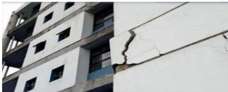
Figura 35. Daños en edificio Nota. Fuente: (Mata) 53
