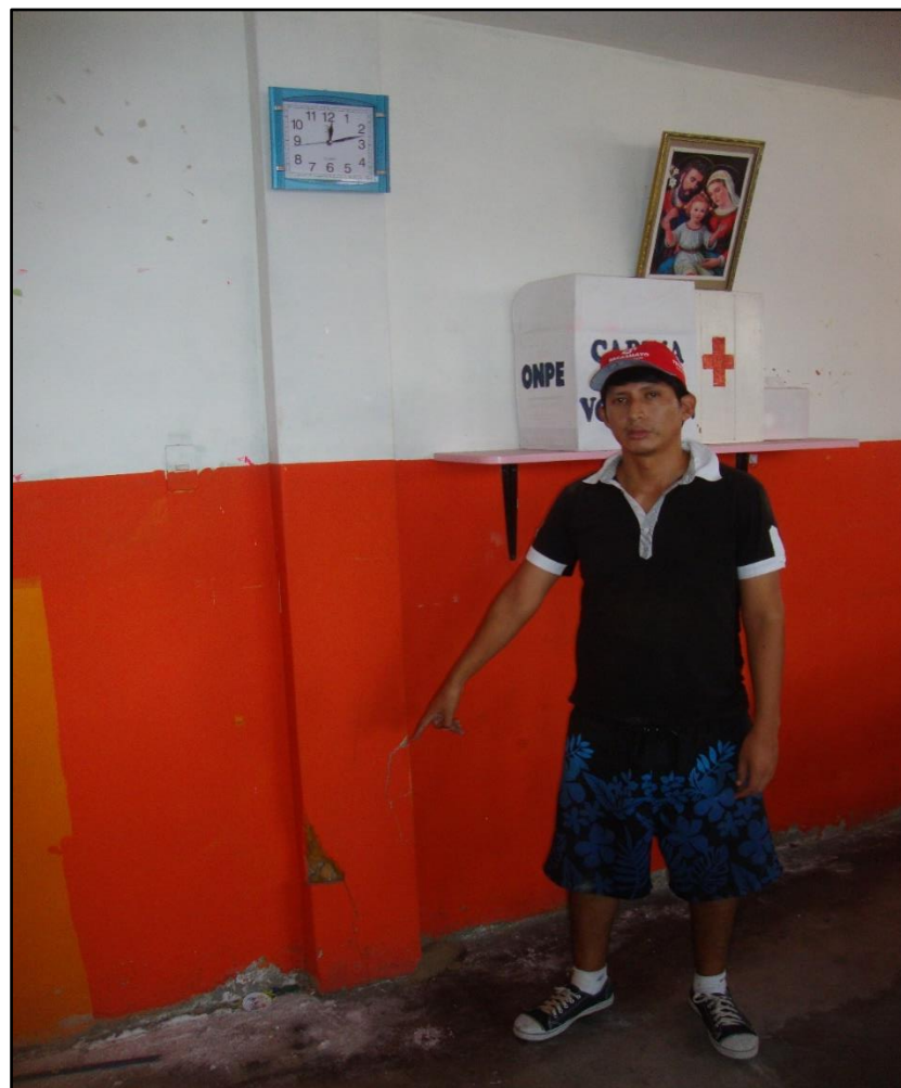
Determinación de corrosión en la UM 10 de la I.E 304.
