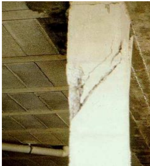
Figura 52. Falla por corte en columna Nota. Fuente: (Navarro y Pino) 60
