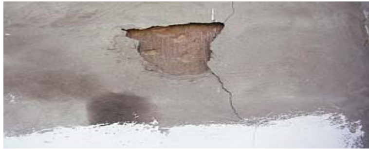
Figura 44. Desprendimiento del mortero
