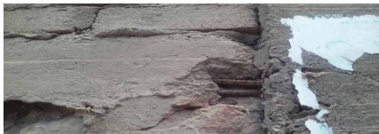
Figura 37. Acero expuesto por mal proceso constructivo Nota. Fuente: (Elaboración Propia)
