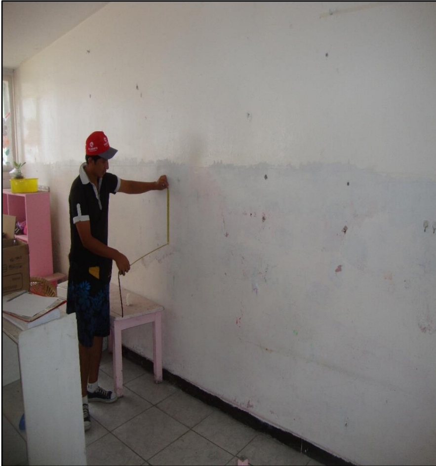
Determinación y medición de fisura en la UM 02 de la I.E 304.
