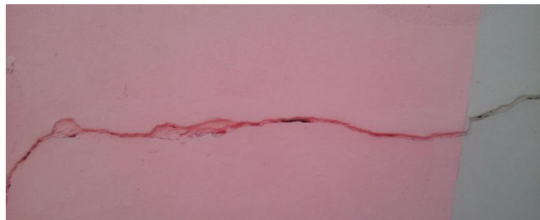
Figura 39. Grieta en muro de Albañilería
