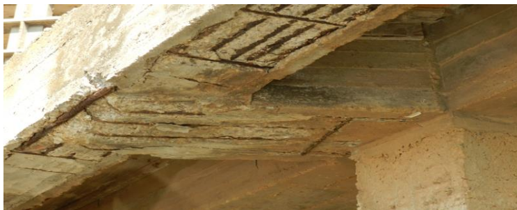
Figura 57. Corrosión en viga peraltada Nota. Fuente: (Alario) 62
