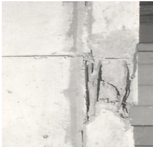
Figura 49. Aplastamiento de columna
