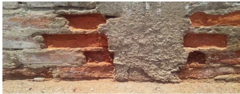
Figura 34. Estructura afectada por condiciones ambientales Nota. Fuente: (Elaboración Propia)
