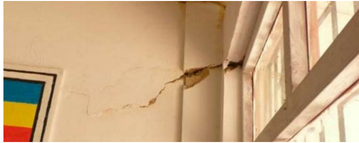
Figura 42. Grieta afectando toda la estructura
