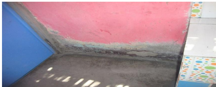
Figura 46. Eflorescencia Nota. Fuente: (Elaboración Propia)
