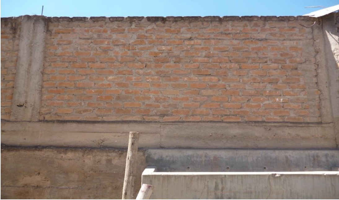
Figura 50. Vista de desprendimiento de concreto en la columna. Fuente: Elaboración propia.
