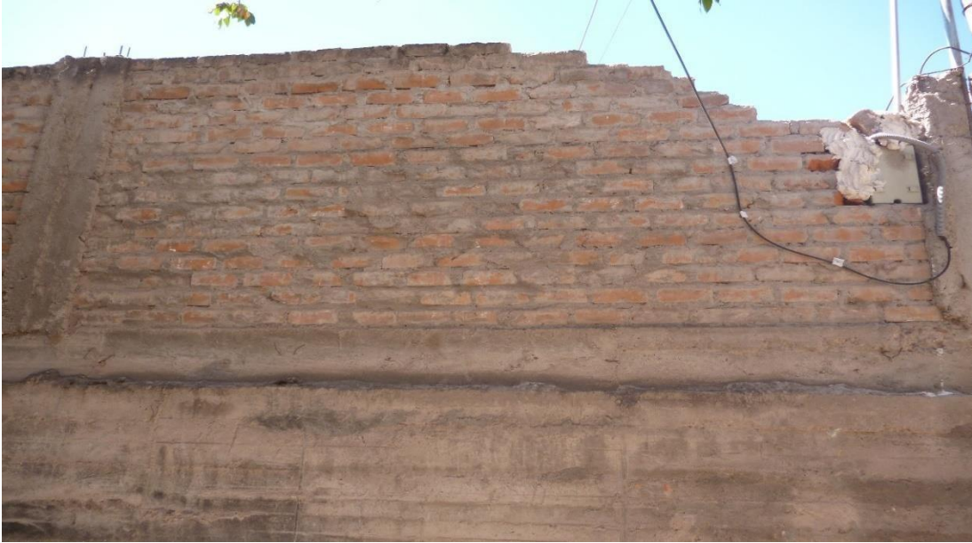
Figura 48. Vista de la cara interna de un muro con desprendimiento. Fuente: Elaboración propia.
