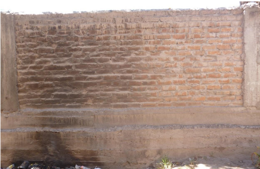
Figura 51. Vista de la cara interna de un muro con presencia de suciedad. Fuente: Elaboración propia.
