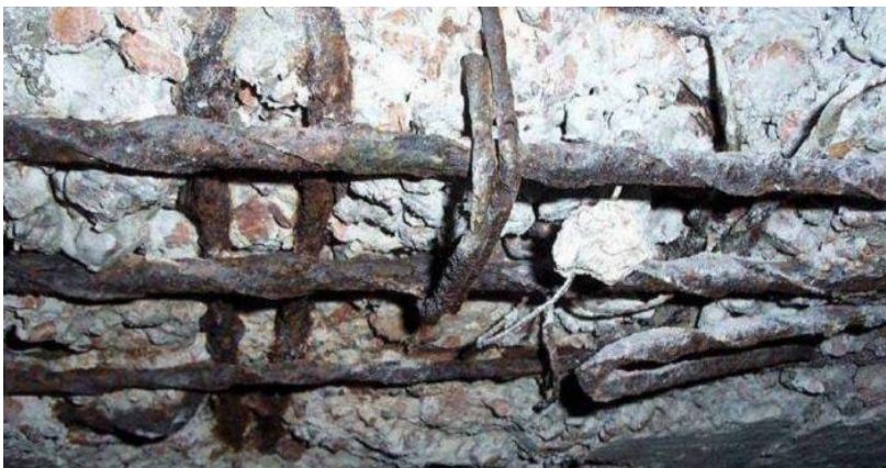
Figura 14. Corrosión del acero por causa de agentes externos. Fuente: Elaboración propia.
