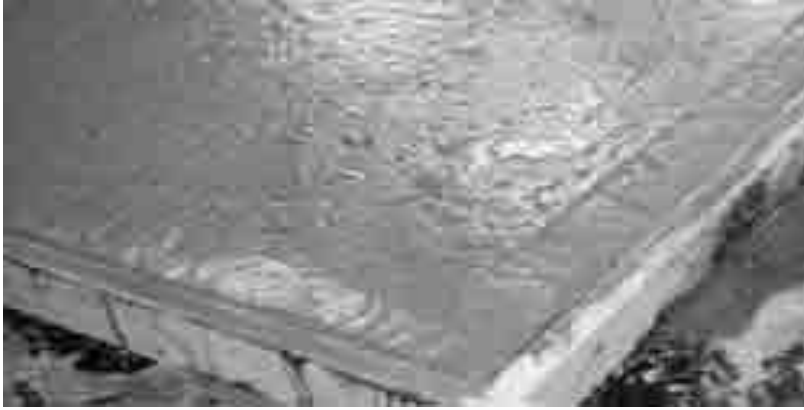
Figura 15. Exudación del concreto. Fuente: Elaboración propia.
