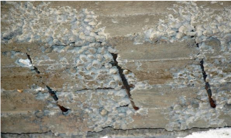
Figura 16. Segregación del concreto (cangrejeras). Fuente: Elaboración propia.
