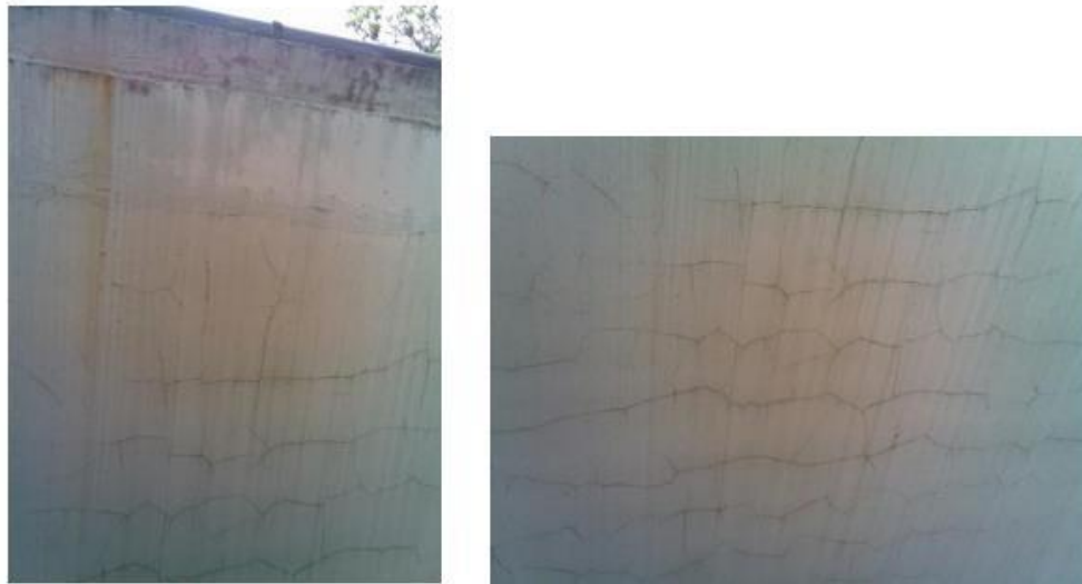
Figura 9. Muros con presencias de fisuras. Fuente: Elaboración propia.
