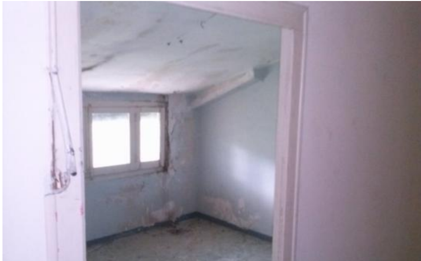
Figura 17. Presencia de humedad en hospitales de la selva. Fuente: Elaboración propia.
