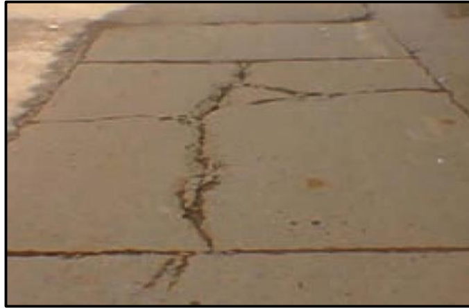
Figura 8. Falla de losa dividida Fuente: (Vásquez Varela, 2002)
