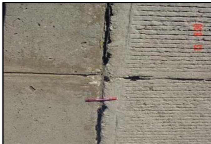
Figura 11. Daño del sello de la Junta Fuente: (Vásquez Varela, 2002)
