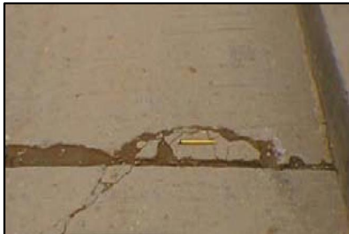
Figura 24. Descascaramiento de Junta
