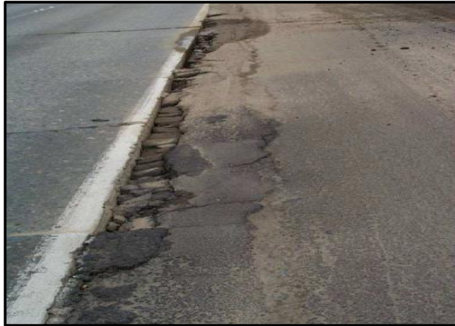
Figura 18. Falla por Bombeo Fuente: (Vásquez Varela, 2002)
