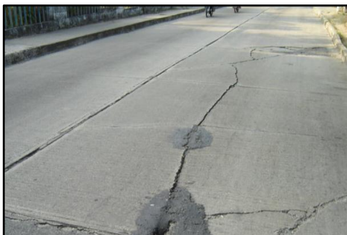
Figura 13. Falla por Grieta Lineal Fuente: (Vásquez Varela, 2002)
