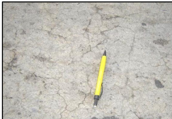
Figura 22. Grieta por Retracción Fuente: (Vásquez Varela, 2002)
