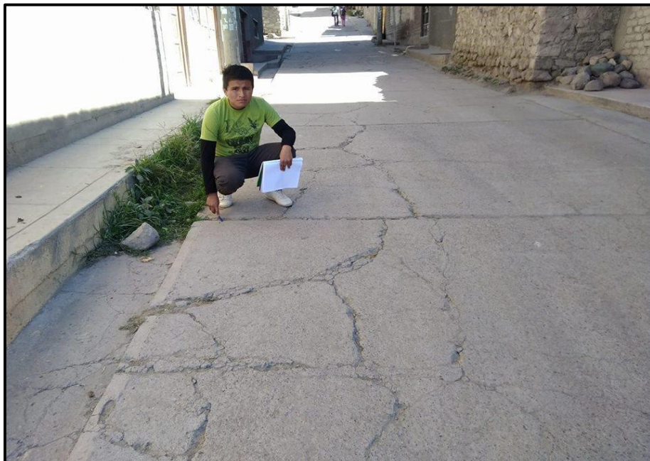
Figura 29. Grieta de esquina, pulimiento de agregados, grieta longitudinal y transversal de la cuadra 03 del Jirón Marsical Cáceres – Santa Ana
