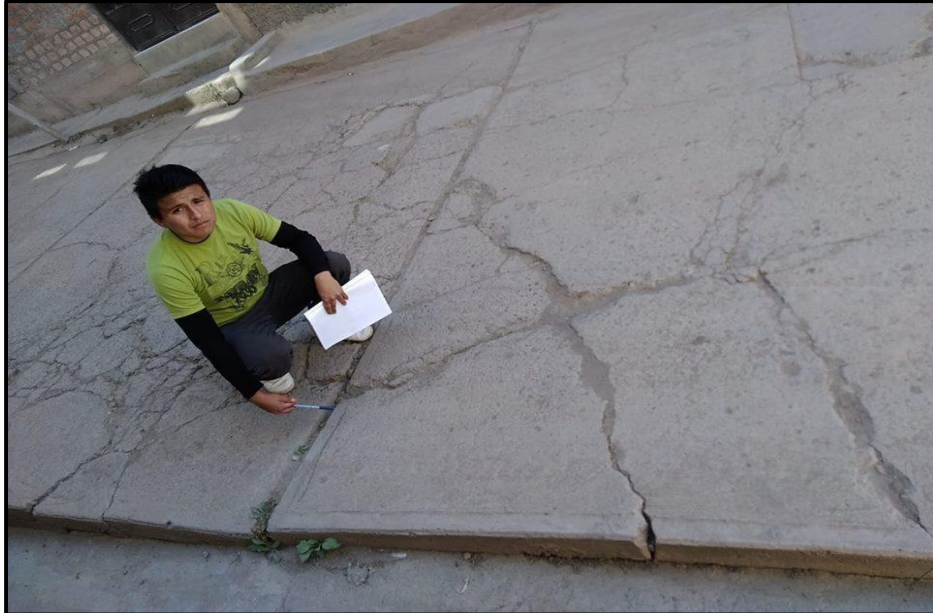
Figura 31. Grieta de esquina, parche grande, longitud transversal y longitudinal presente en la cuadra 03 del Jirón Mariscal Cáceres – Santa Ana
