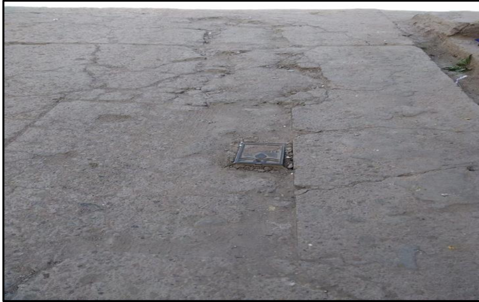
Figura 30. Grieta longitudinal y transversal, descascaramiento de junta, parcheo grande presente en la cuadra 02 del Jirón Mariscal Cáceres – Santa Ana
