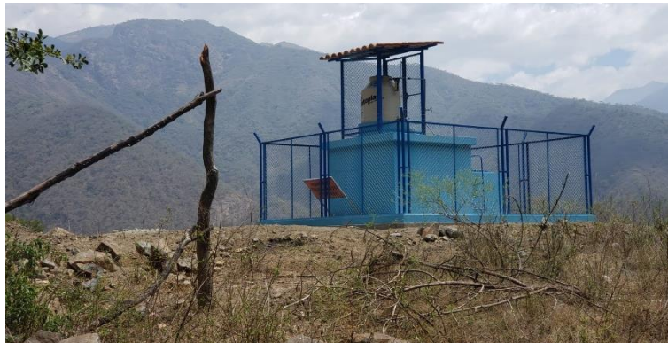
Gráfico 7: Estación de Bombeo
