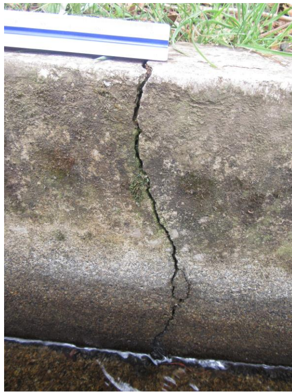
Imagen 5: Medición de la patología grieta.
