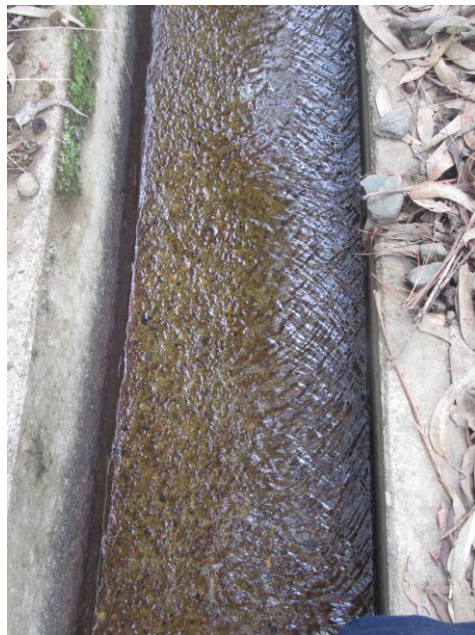
Imagen 7: Vista de la patología erosión
