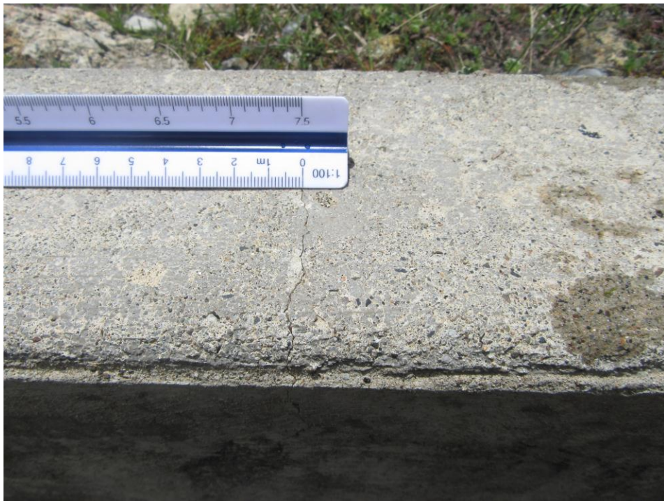
Imagen 4: Medición de la patología fisura
