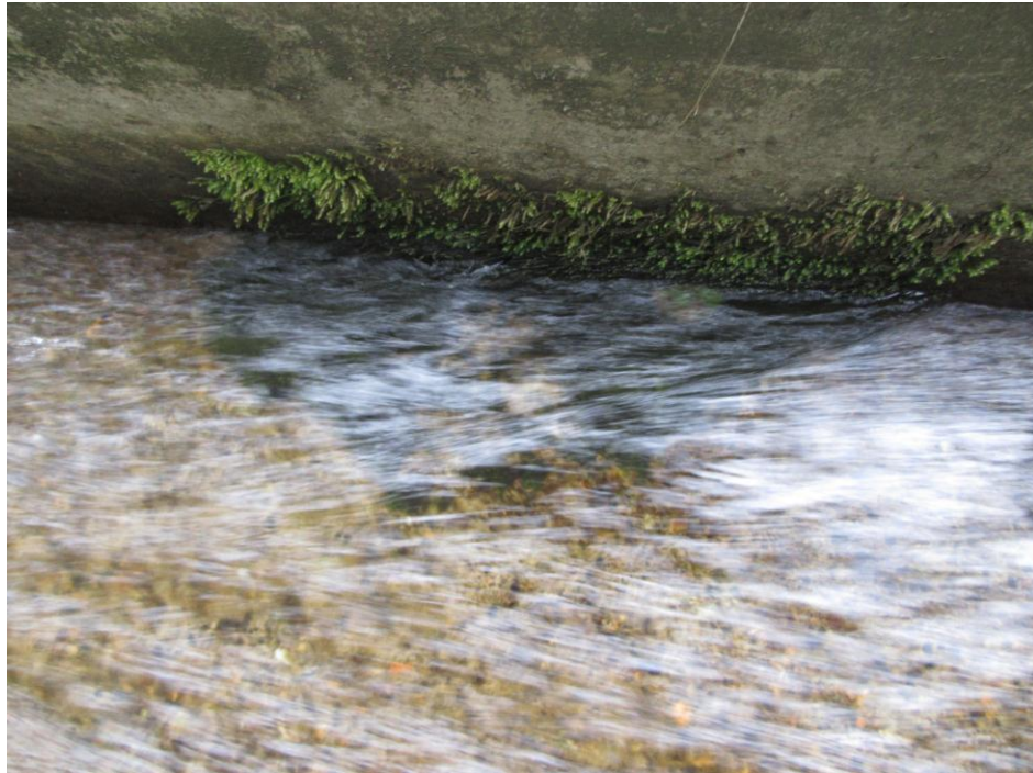
Imagen 6: Vista de la patología musgo
