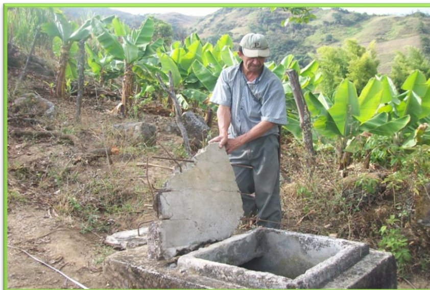
Foto N° 8. cajas de valvulas crp en mal estado
