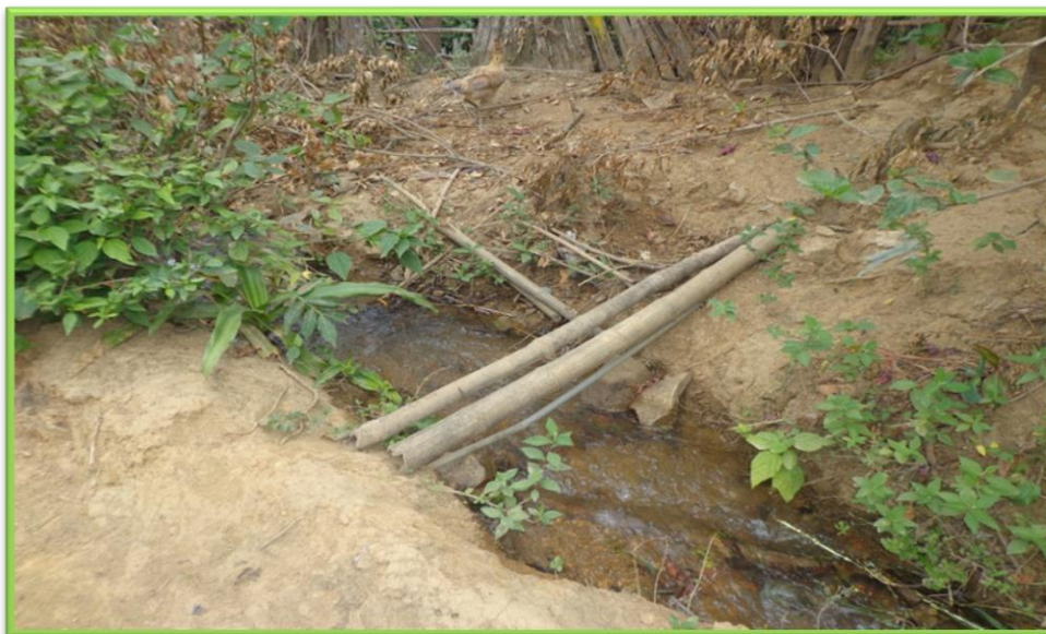
Foto N° 11. Línea de conducción sin cubrirse y mal estado
