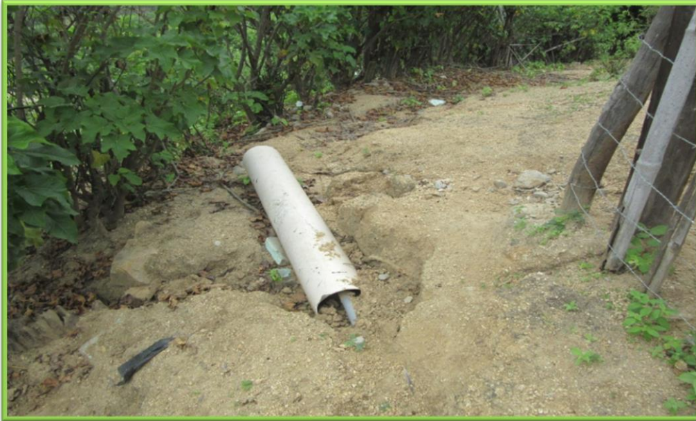
Foto N° 13. Tubería en mal estado
