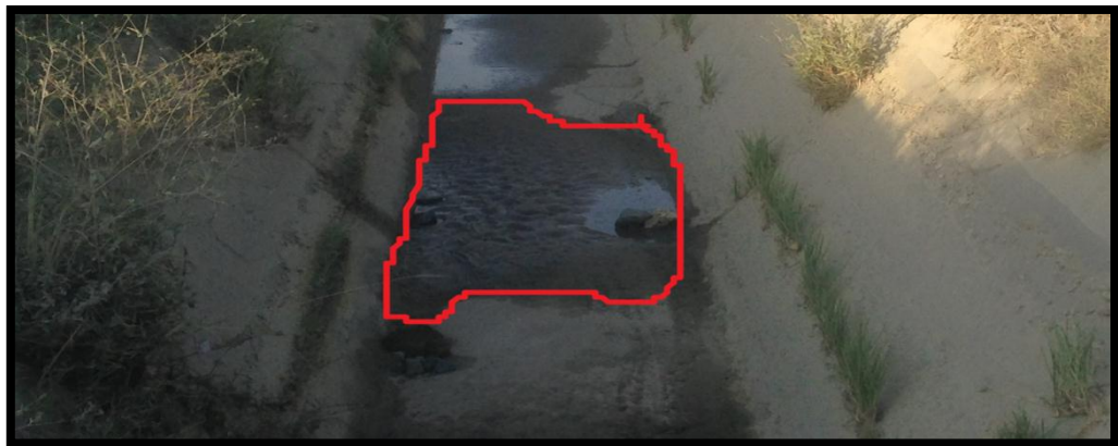
Figura 32: Erosión en fondo del canal
