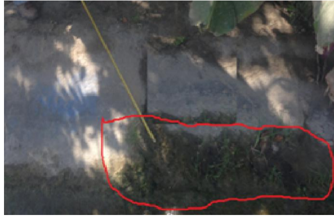
Figura 03. Erosión de la superficie de canal Carlos Leigh.
