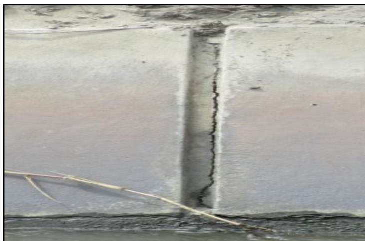
Figura 01. Agrietamiento en junta de canal Carlos leigh.
