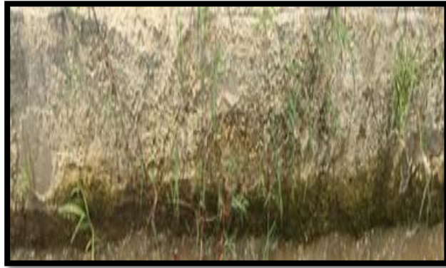
Figura 07. Mohos en paredes de canal Quillhuay.
