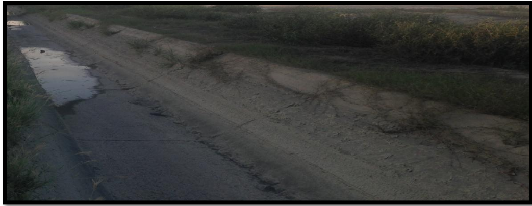
Figura 30: Descascaramiento en pared del canal.
