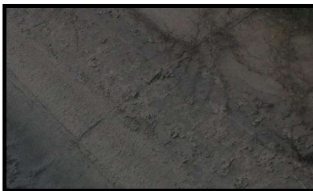
Figura 06. Descascaramiento en Canal Calos Leigh.
