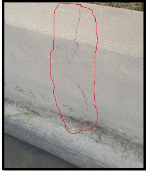
Figura 29: Agrietamiento en talud.
