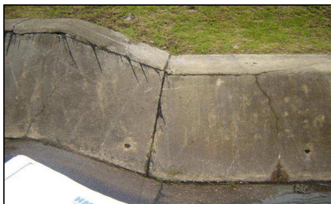
Figura 04. Agrietamiento en paredes de canal.
