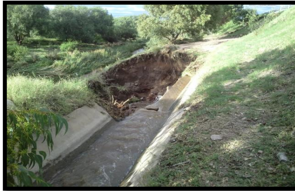
Figura 02. Rotura en canal de conducción.
