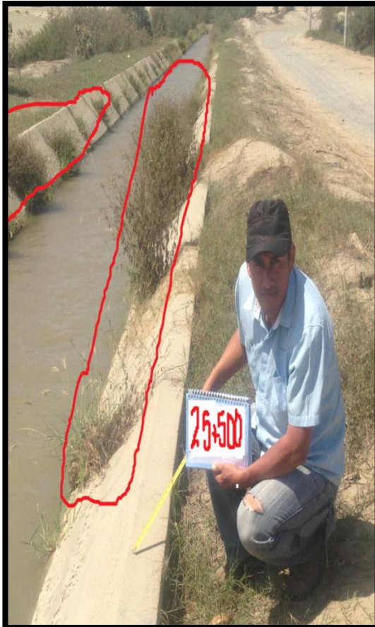
Figura 22. Daño por vegetación. Nota. Fuente: Elaboración propia
