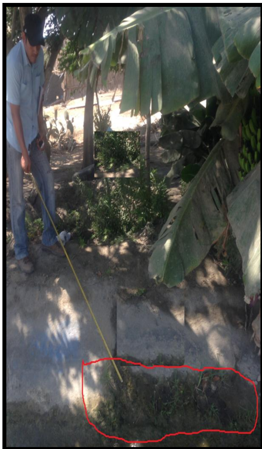
Figura 23. Erosión. Nota. Fuente: Elaboración propia
