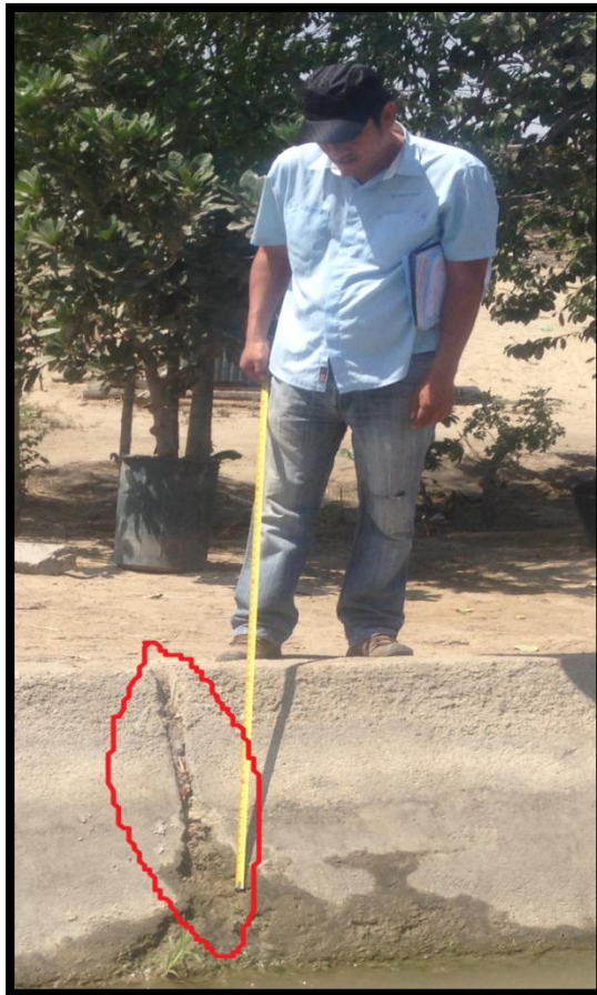
Figura 21. Daño en el sello de junta. Nota. Fuente: Elaboración propia
