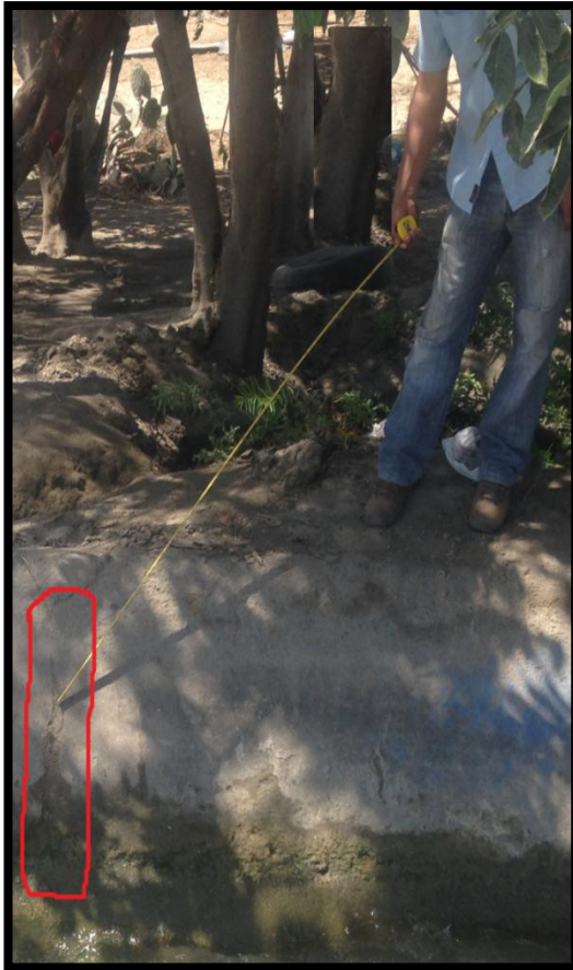
Figura 24. Agrietamiento. Nota. Fuente: Elaboración propia
