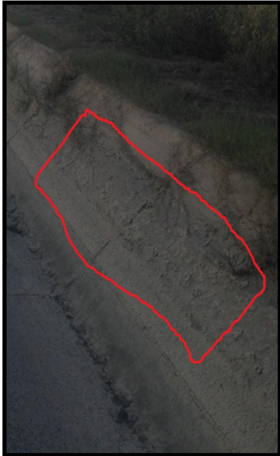
Figura 25. Descascamiento. Nota. Fuente: Elaboración propia
