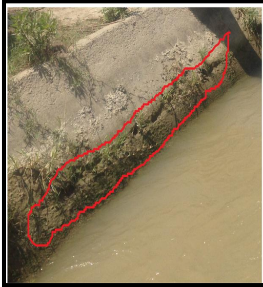
Figura 26: Erosión en las paredes del canal.
