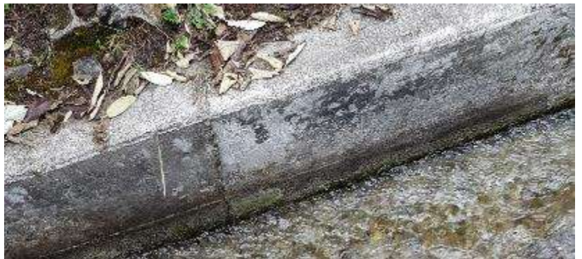
Imagen 06: Eflorescencia en la pared del canal
