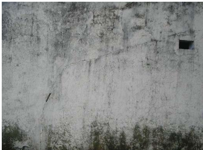
Imagen N°2: Fisura en Muro Norte. (Monroy R.)
