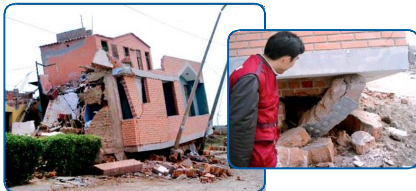
Imagen N° 6: Vivienda dañada debido al terremoto de Pisco. (Zapata J.)
