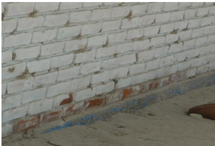
Imagen N° 20: Suciedad en muros de albañilería. (Broto)
