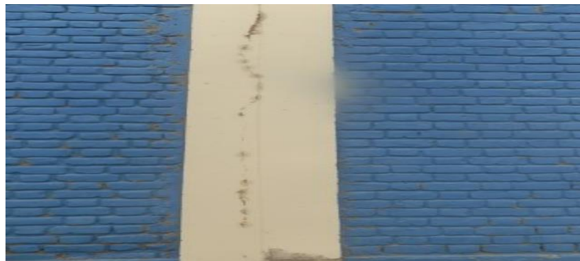
Imagen N°15: Grieta en columna de albañilería. (Pedro R.)
