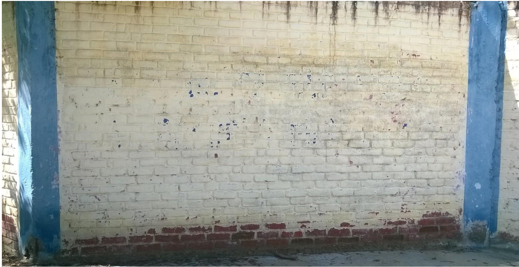
Imagen N° 29: Suciedad y Erosión encontrada en las estructuras de albañilería confinada.
