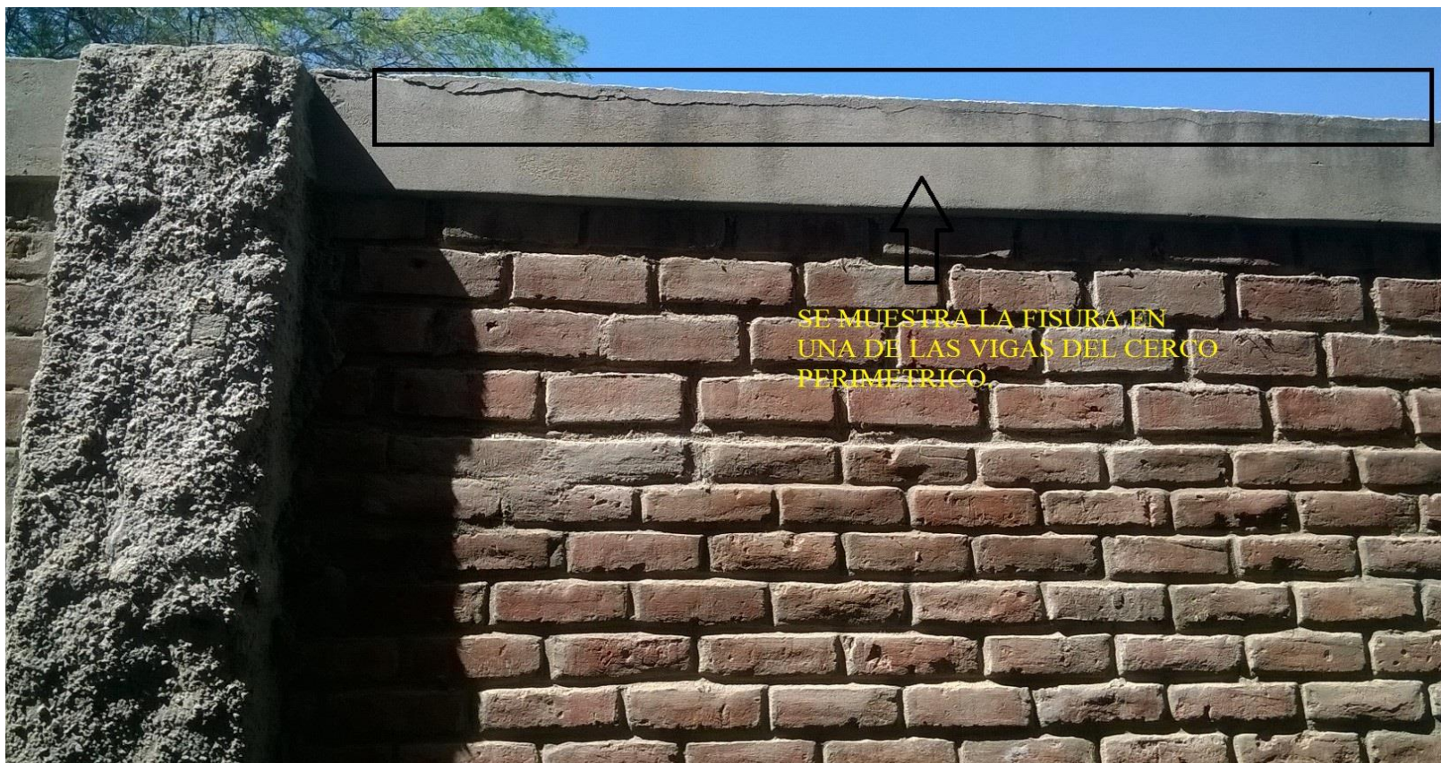
Imagen N° 22: Fisura en la viga del cerco perimétrico.
