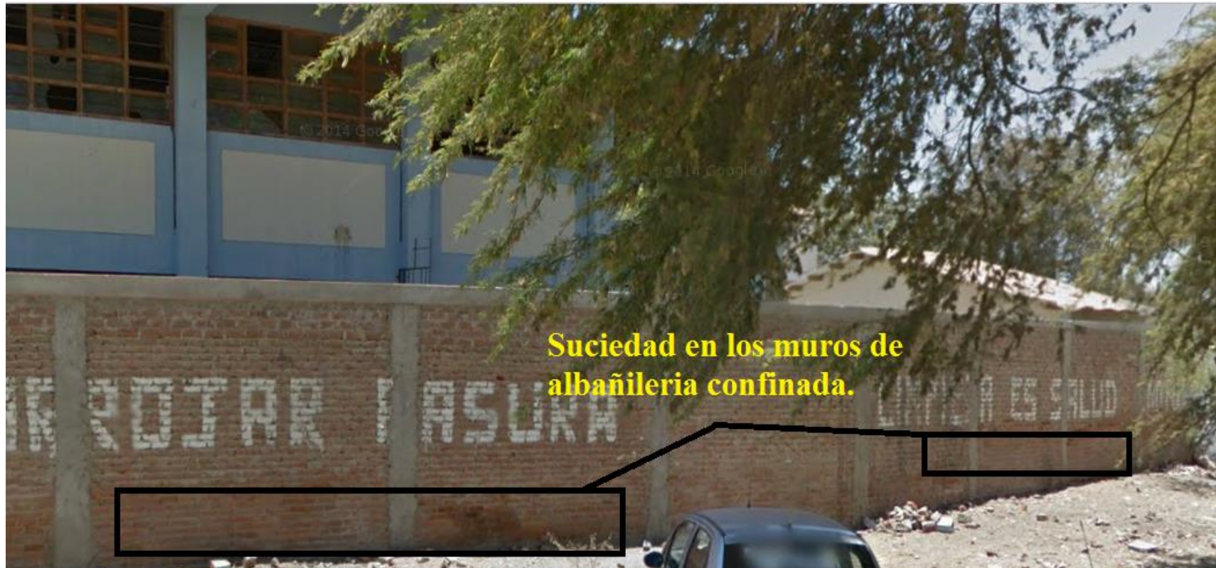
Imagen N° 28: Suciedad encontrada en las estructuras de albañilería confinada.
