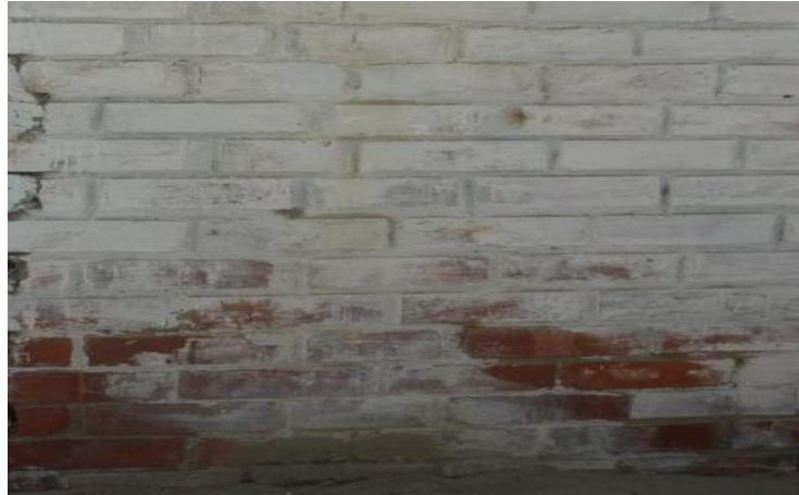
Imagen N° 17: Humedad en muro de albañilería. (Pedro R.)
