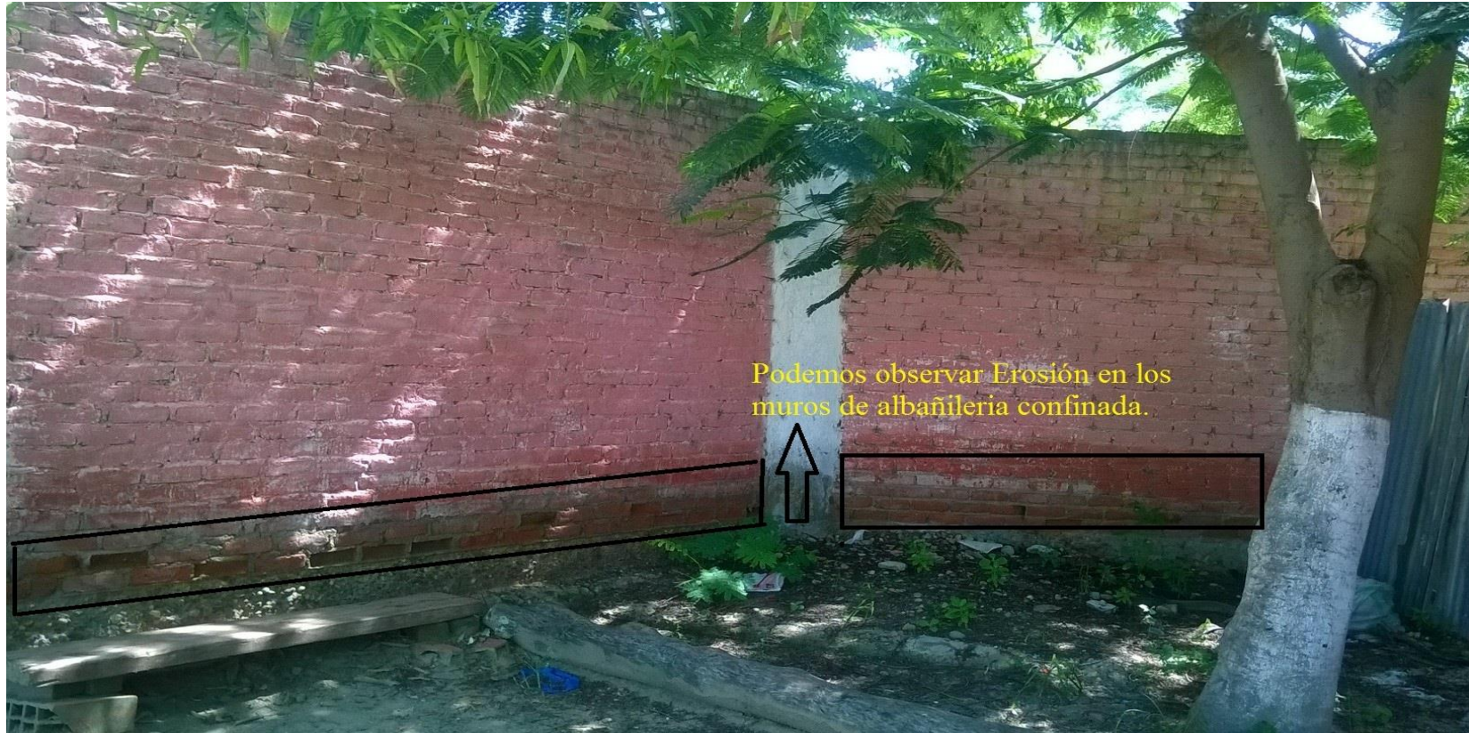
Imagen N° 24: Erosión en muros de albañilería confinada.
