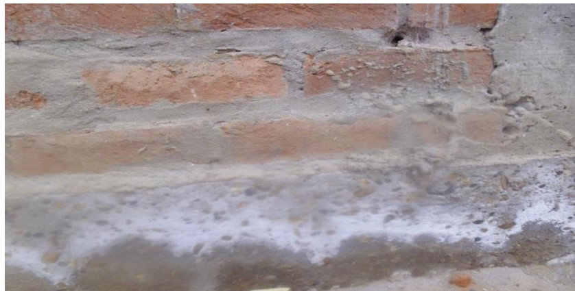
Imagen N° 16: Eflorescencia en muro de albañilería. (Sánchez G.)
