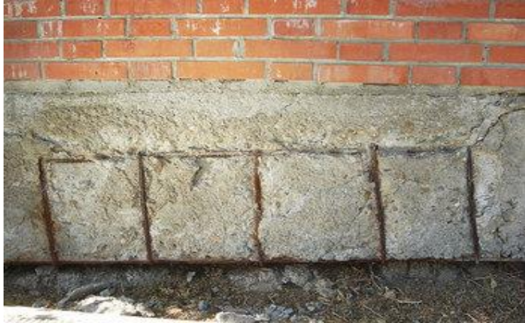
Imagen N°18: Corrosión del acero corrugado. (Pedro R.)
