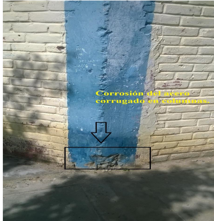
Imagen N° 27: Corrosión del acero corrugado en columnas de albañilería confinada.
