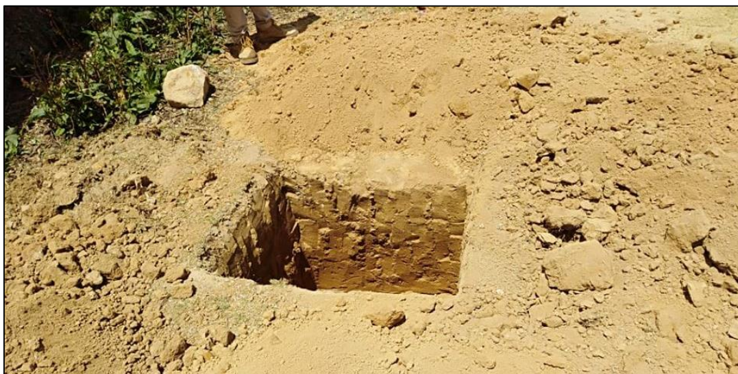
Figura N° 17: Calicata N°2 realizada en la línea de conducción h=1.50 cm. de profundidad para la toma de muestra.
