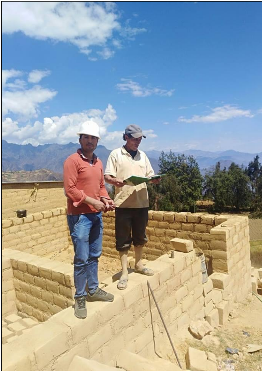
Figura N° 11: Realizando la encuesta en el caserío de Anguy al poblador Juan Bautista Cerna.
