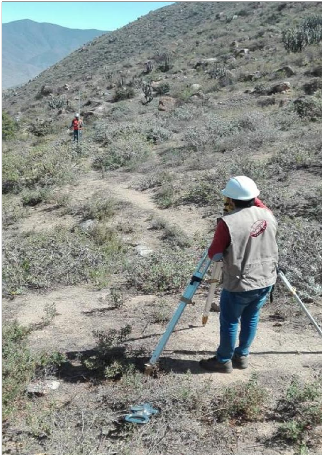
Figura N° 24: Realizando el levantamiento topográfico en la línea de conducción para el proyecto de abastecimiento de agua potable.
