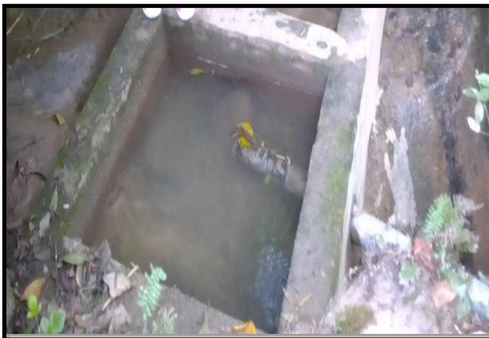
Fotografía N° 01: Captación del sistema
