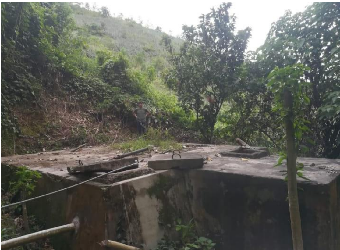
Figura 26: Vista de la conexión de cloracion al reservorio.
