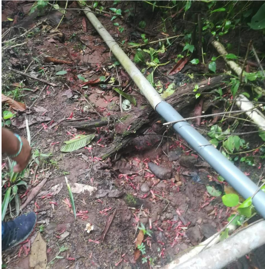
Figura 17: Fotografía de la línea de conducción
