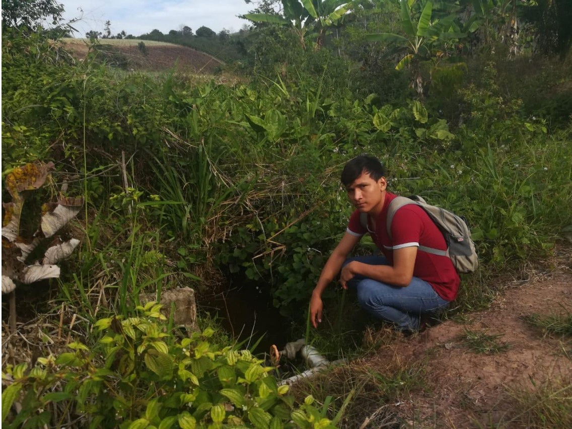
Figura 23: Fotografía con la valvula de paso en el inicio de la red de distribución.
