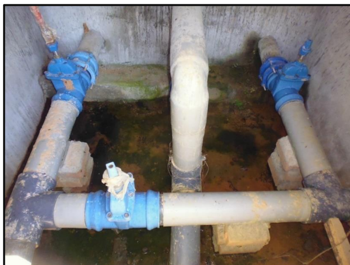
Figura 25: Caseta de válvulas.
