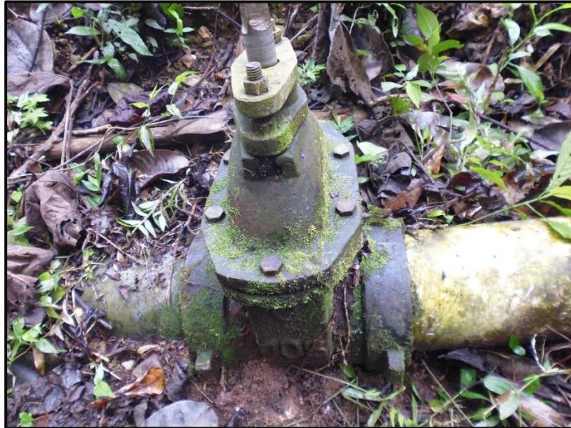
Figura 15: Válvula de control dañada y con deterioro.
