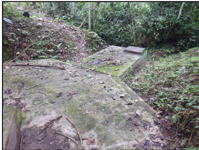
Figura 14: Falta de mantenimiento de la captación.
