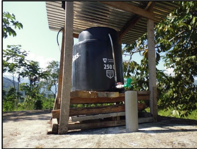
Figura 26: Caseta de Cloración.
