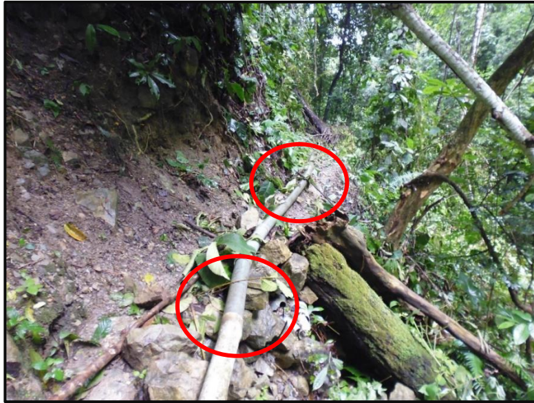
Figura 21: Tubería no está enterrada.
