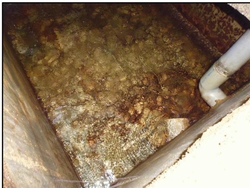
Figura 16: Falta de mantenimiento interna, captación.
