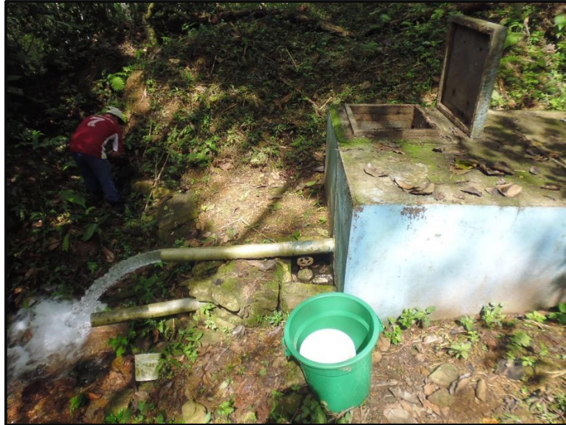
Figura 17: Se aprecia el caudal y el aforo de la captación.
