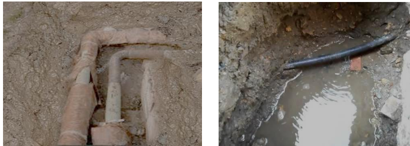
Figura 15. Fugas de agua en las tuberías.
