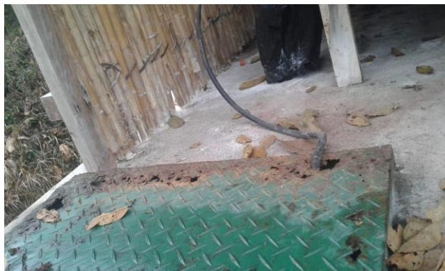
Figura 11. Estado de la tapa sanitaria.
