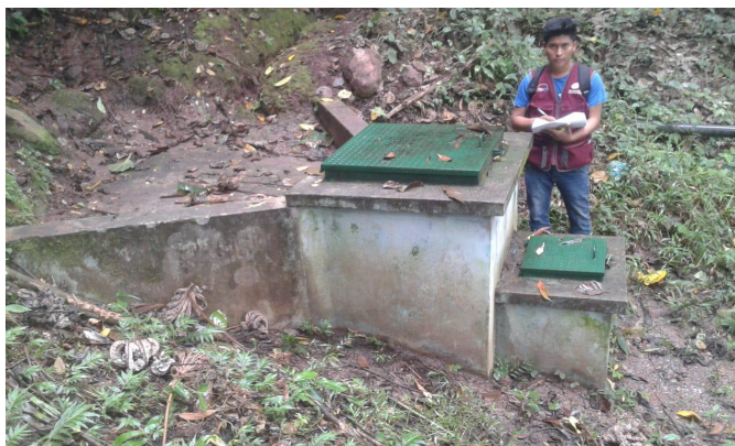
Figura 9. Captación del manantial “agua dulce”.
