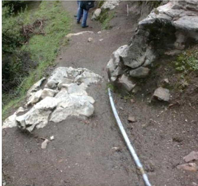
Figura 13. Tubería descubierta y con fuga de agua.
