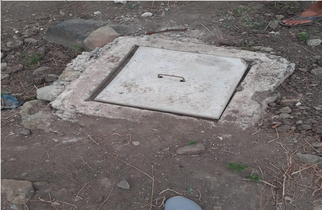
Ilustración 23.Caja de Conexión Domiciliaria
