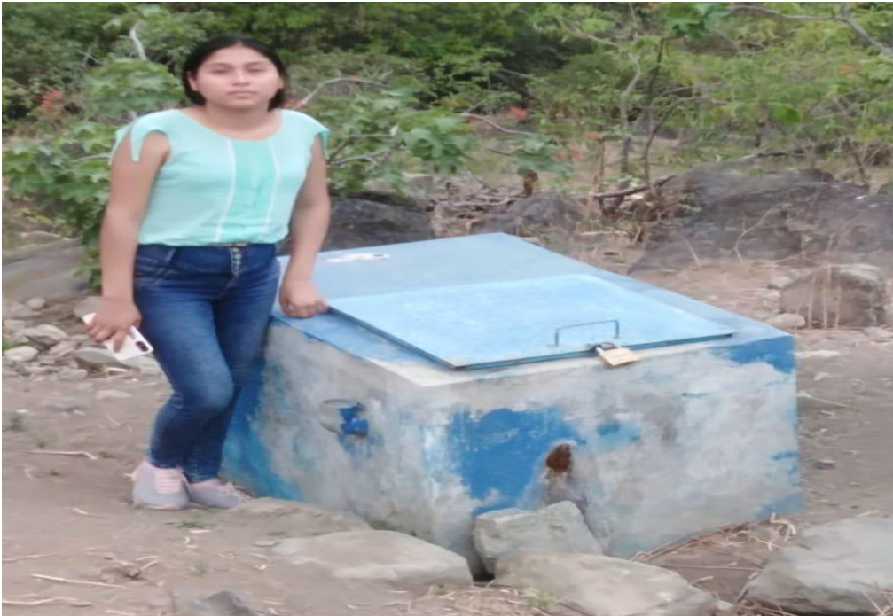
Ilustración 20.Cámara Rompe Presión 7 -Florida
