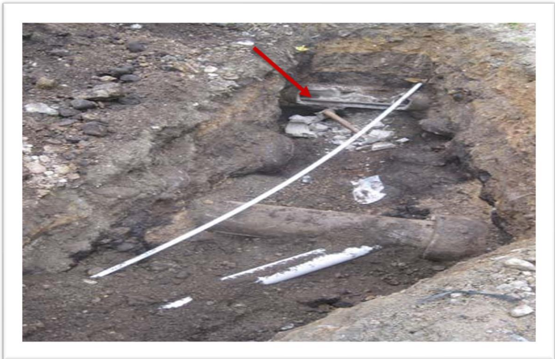
Figura N°20: Estado actual de la red de distribución tramo 0+040.
