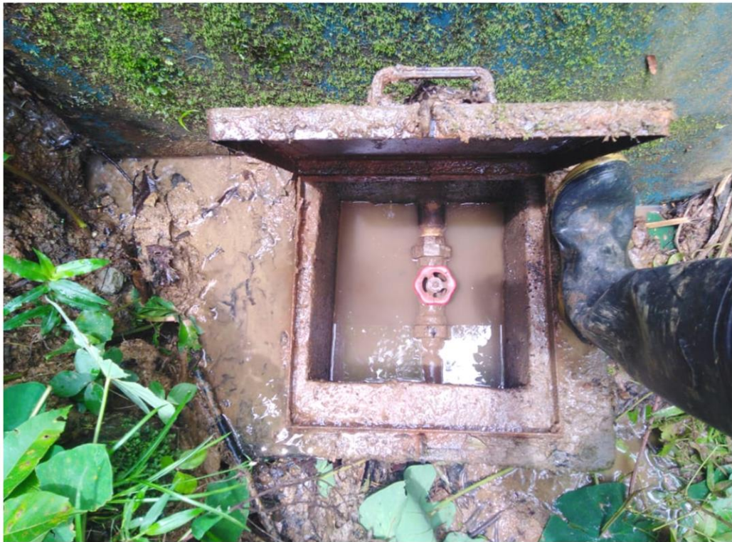
Figura N°14: Cámara seca en estado de deterioro
