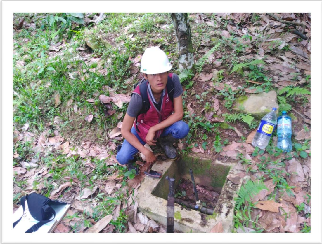
Figura N°17: Estado actual de la válvula de aire.
