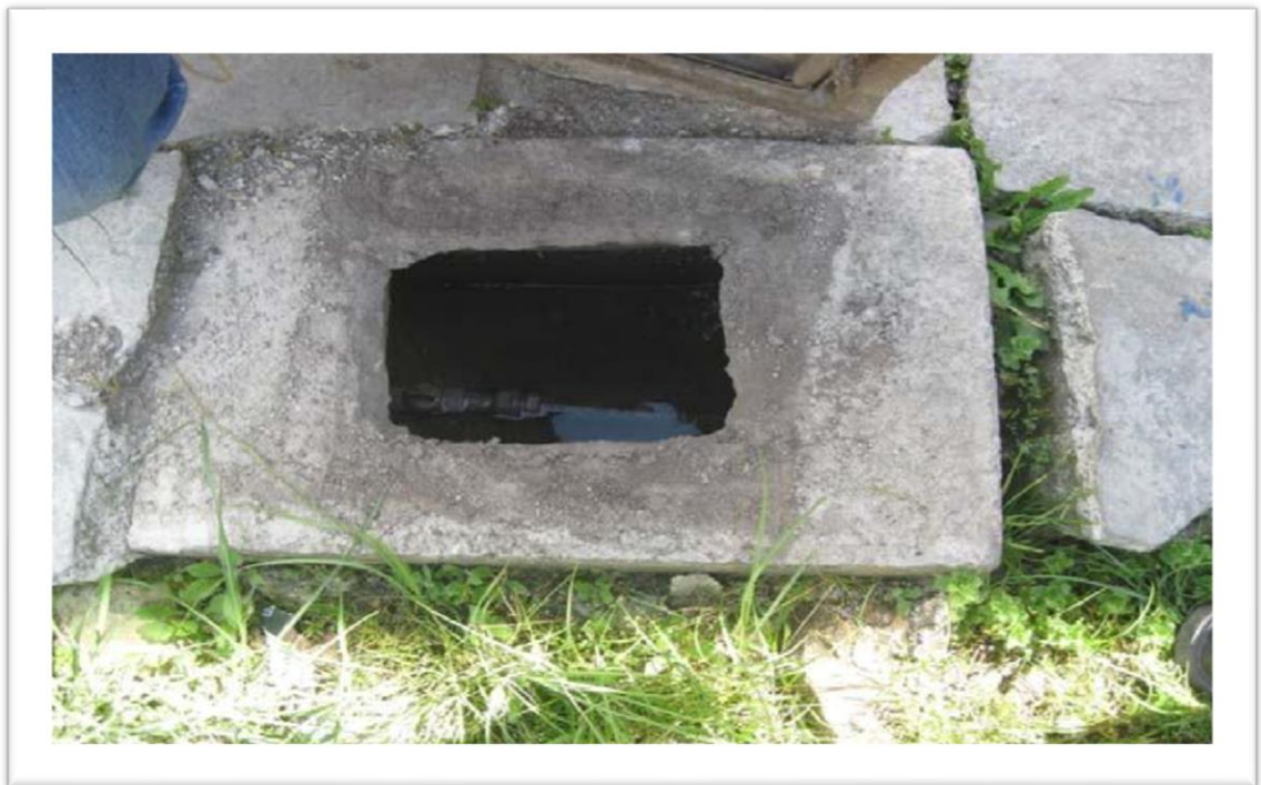
Figura N°22: Estado actual de la caja de medidor.
