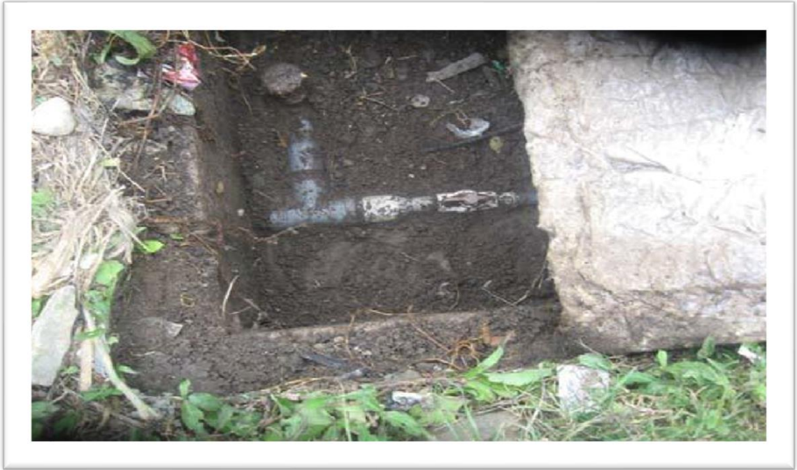
Figura N°21: Estado actual de la acometida.
