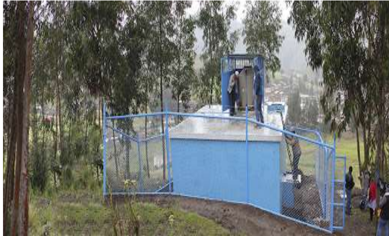
Figura 5: Reservorio de Almacenamiento.
