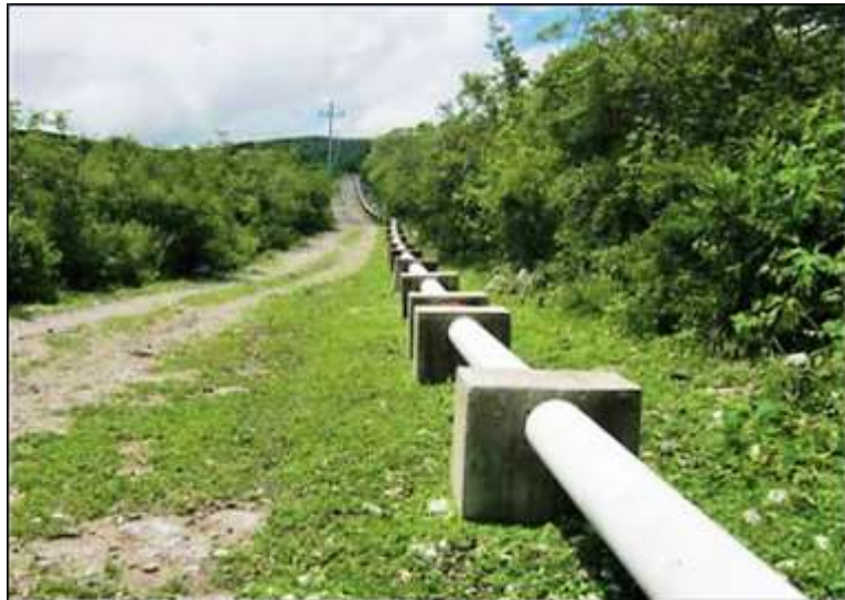
Figura 4: Línea de Conducción.
