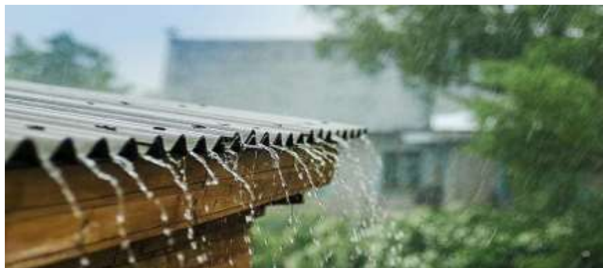
Figura 9: Aguas de lluvia.
