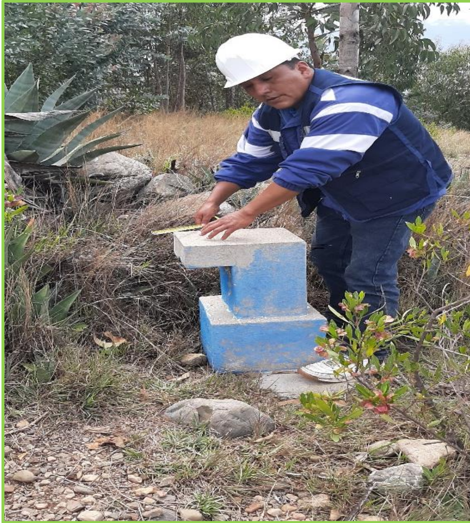
Fotografía N° 11: Tubo rompe cargas en la línea de conducción existente
