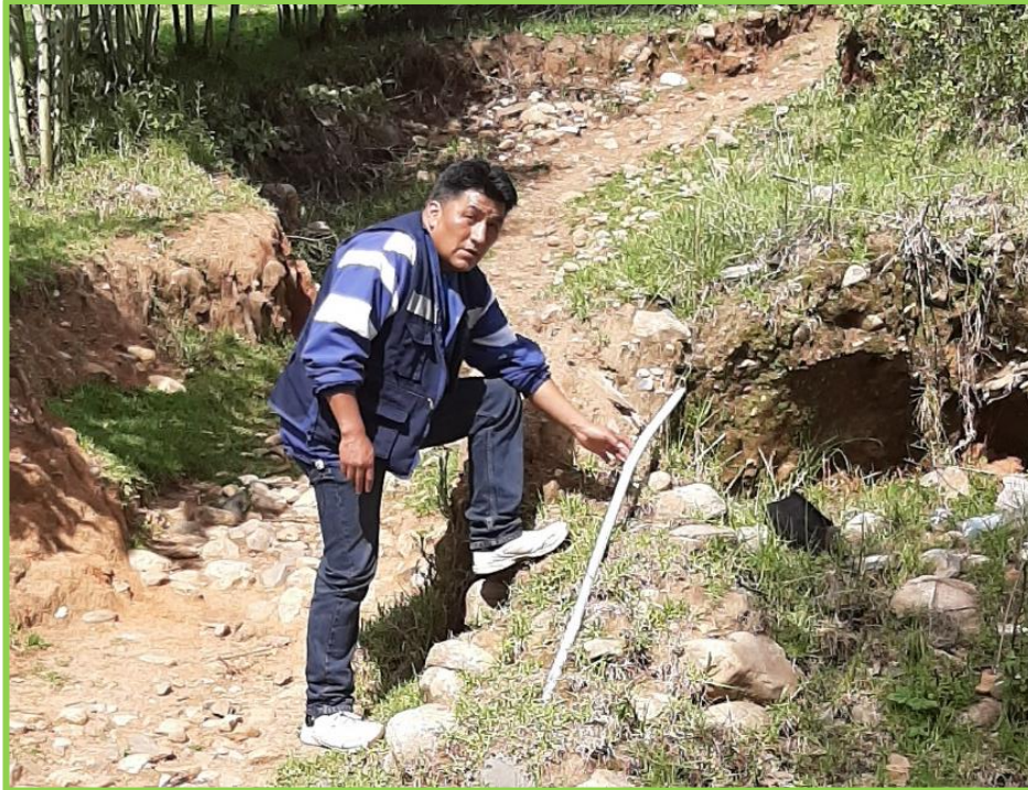
Fotografía N° 09: Tubería expuesta en la línea de aducción.
