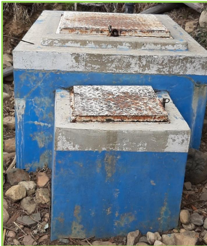
Fotografía N° 10: Cámara Rompe Presión
