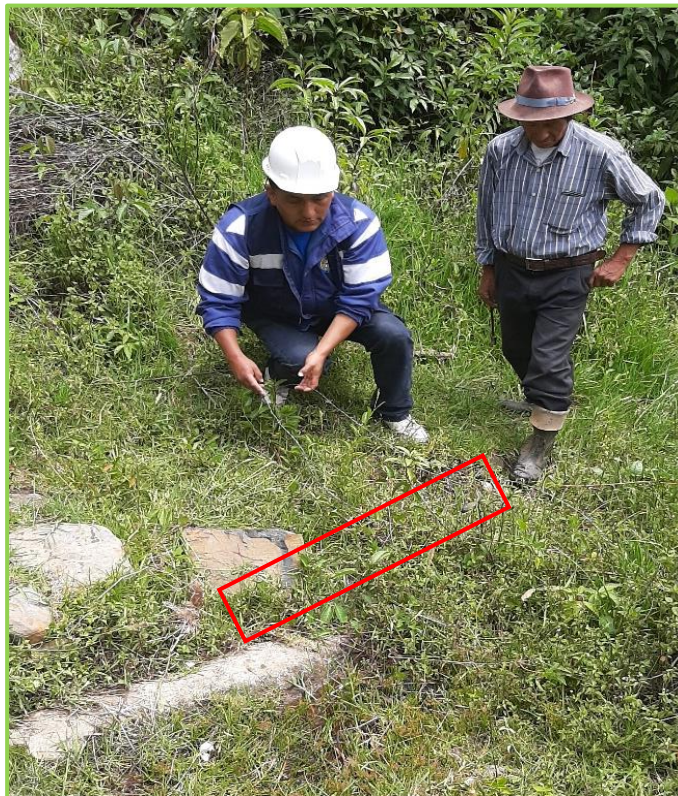
Fotografía N° 06: Tubería PVC expuesta en la Línea de conducción.
