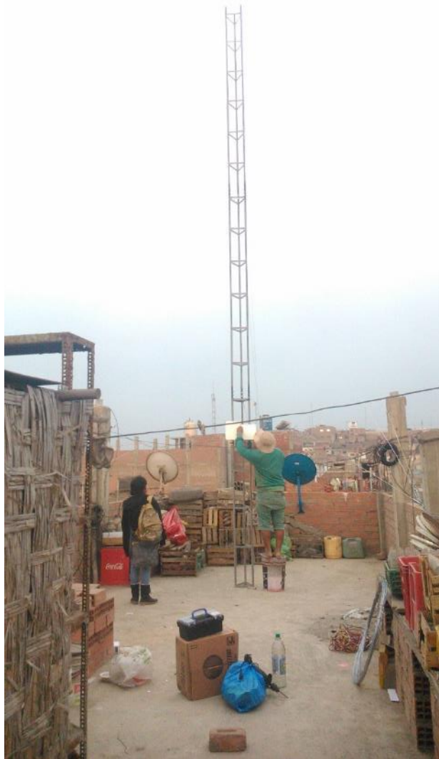
Gráfico Nro. 83: Instalación de Estación base San Luis.
