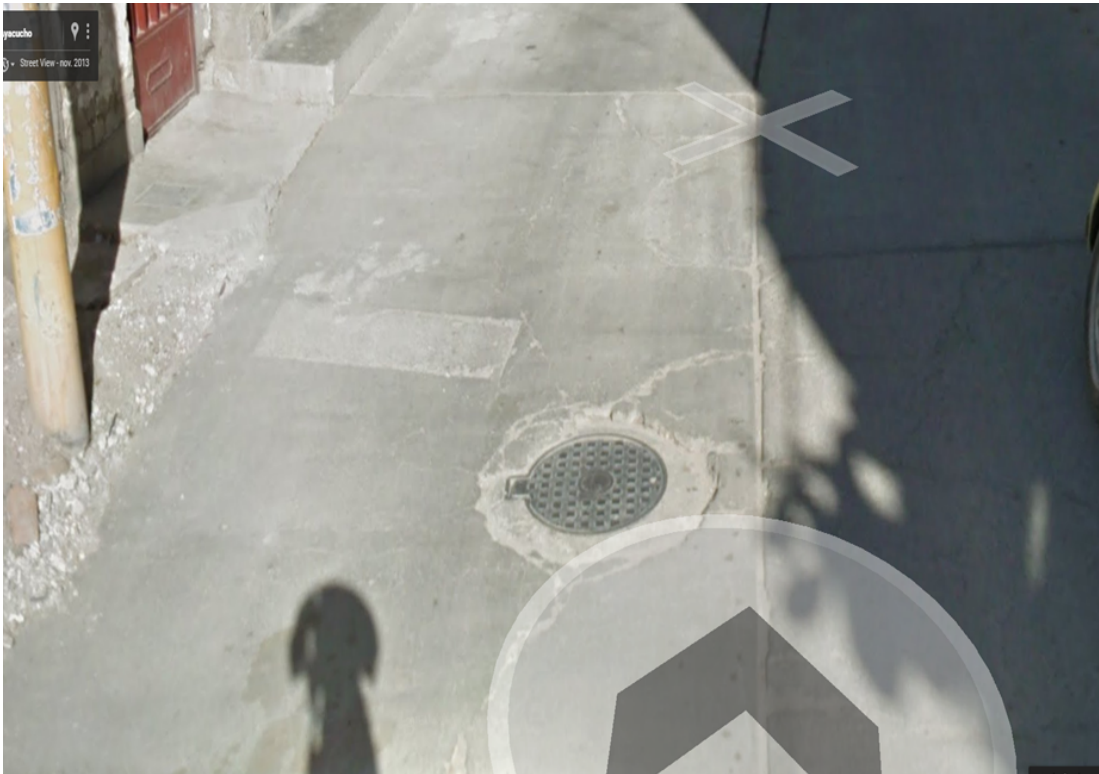
Fotografía 8: Cuadra 1 jr. 24 de Junio, borde de buzón deteriorado.
