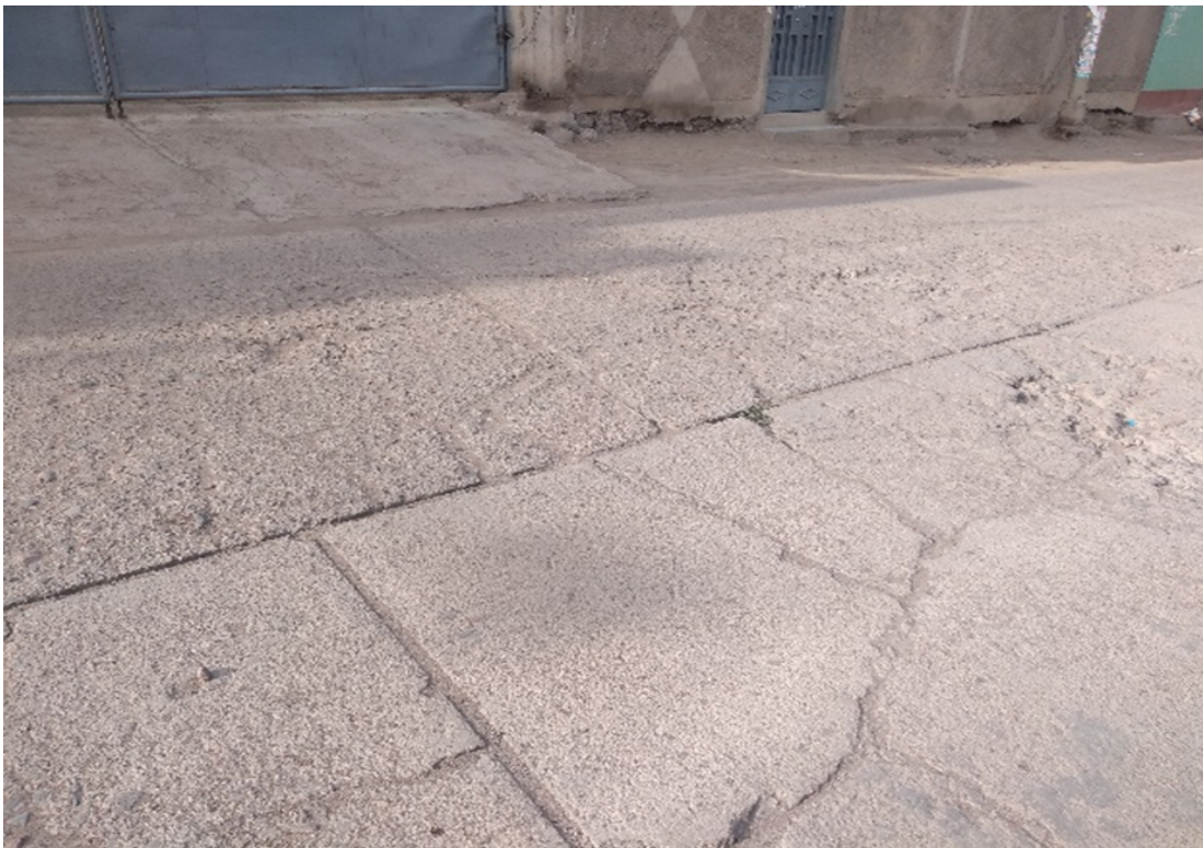
Fotografía 10: Cuadra 3 jr. 24 de Junio, grieta de esquina y pulimiento.
