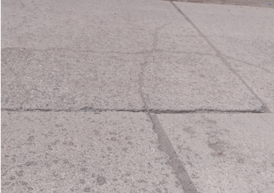
Fotografía 11: Cuadra 4 jr. 24 de Junio, grieta de esquina y pulimiento.
