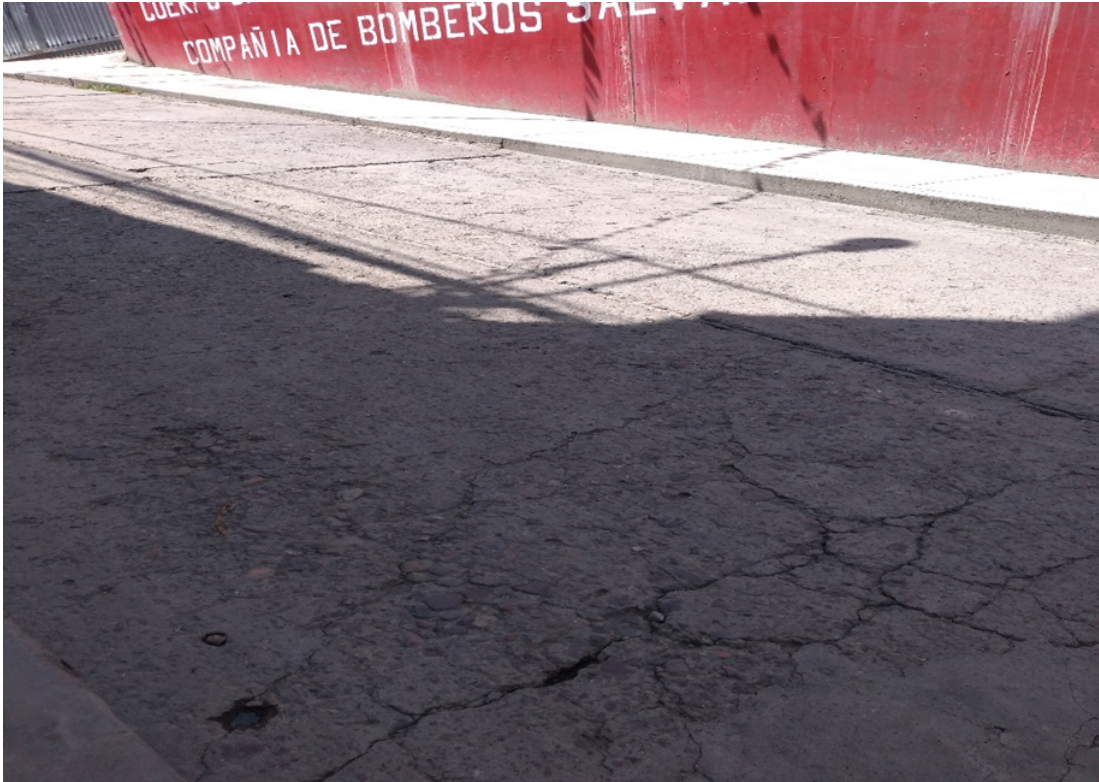
Fotografía 3: Cuadra 2 Mariano Bellido, Pavimento totalmente fracturado.
