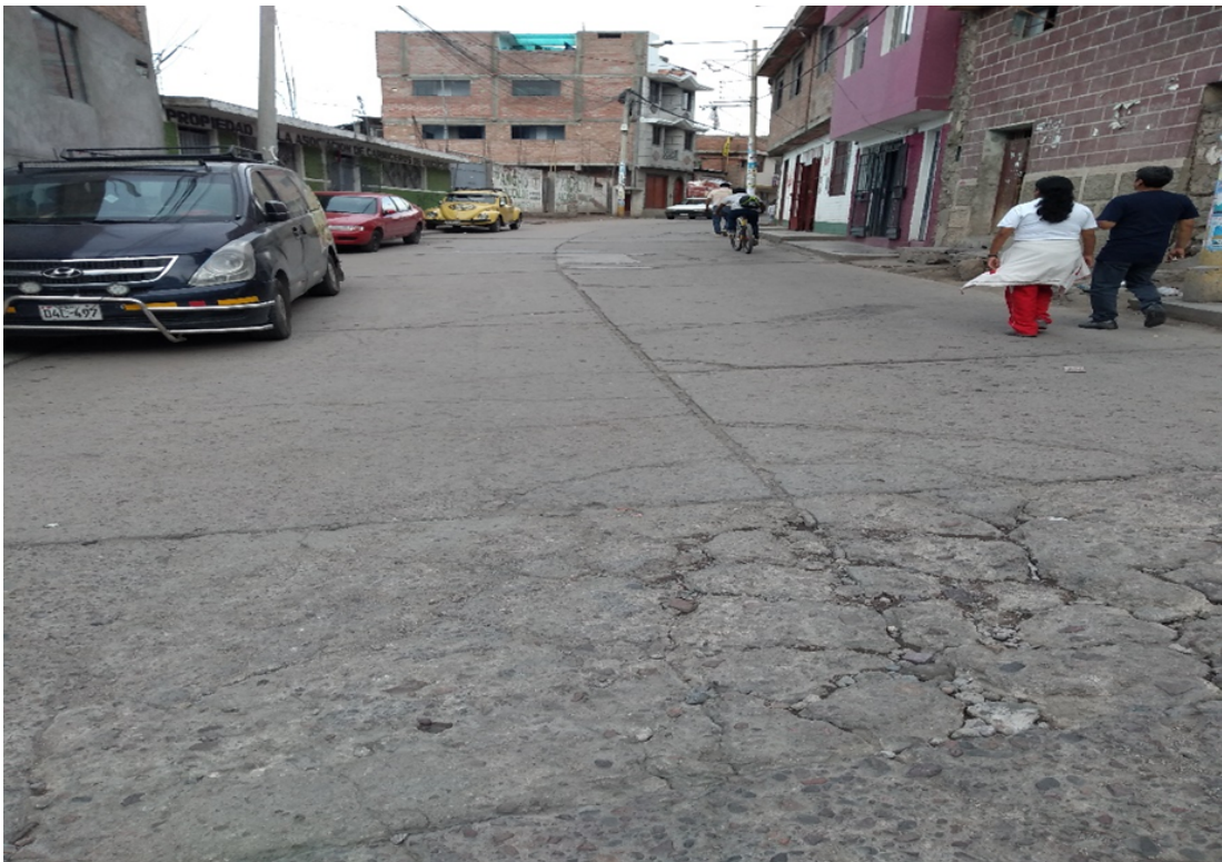
Fotografía 6: Cuadra 1 jr. 24 de Junio, pavimento deteriorado.
