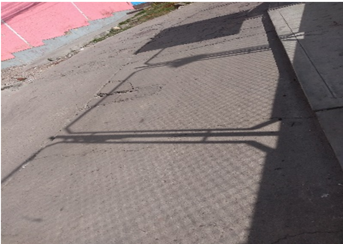
Fotografía 4: Cuadra 2 Mariano Bellido, Pavimento con grieta de esquina.
