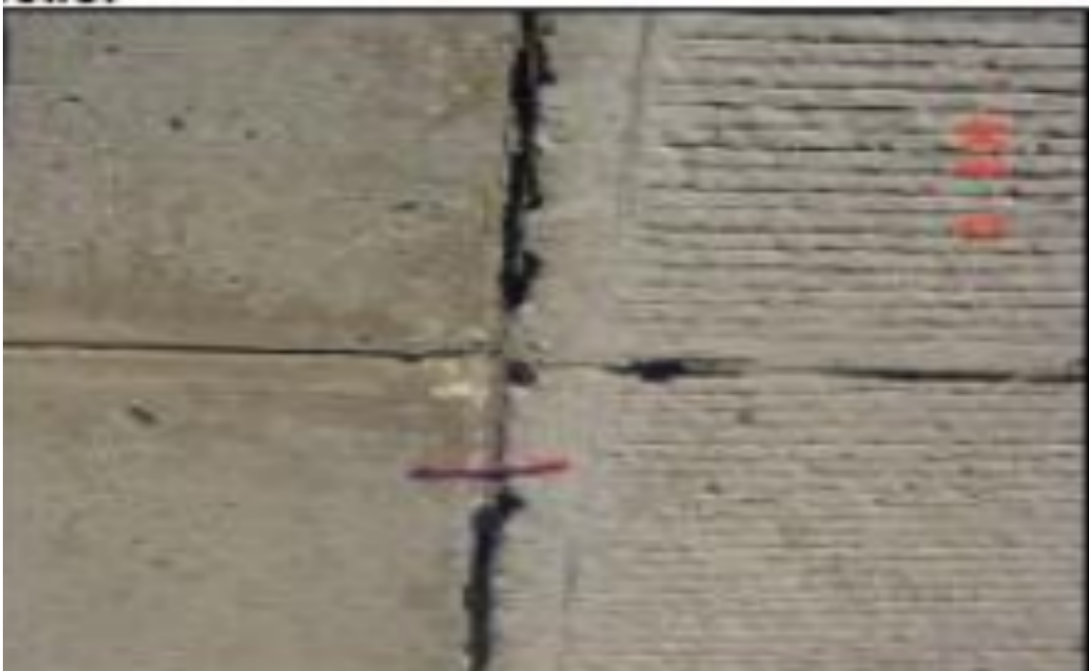
Figura 2.6: Juntas, deficiencia de sellado.
