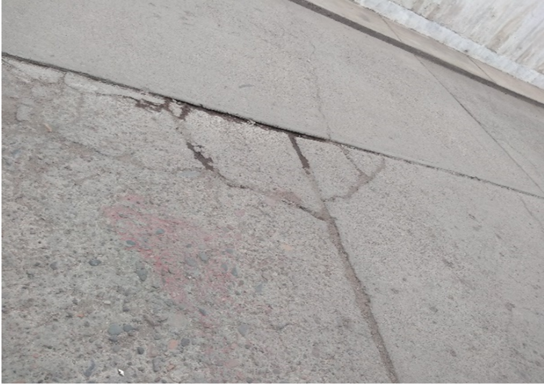
Fotografía 7: Cuadra 1 jr. 24 de Junio, grieta de esquina.
