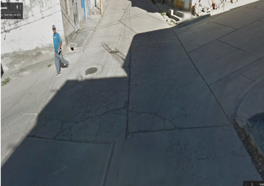
Fotografía 9: Cuadra 1 jr. 24 de Junio con esquina jr. Arica pavimento fracturado.
