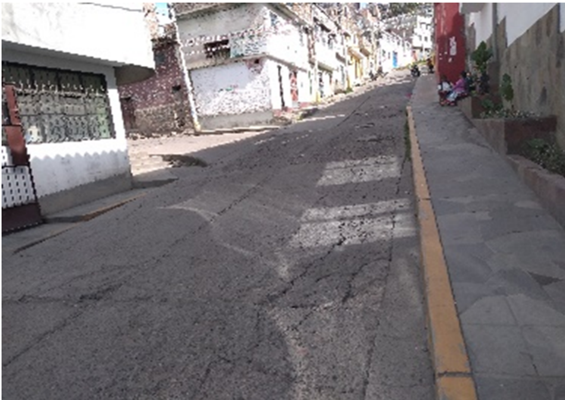
Fotografía 2: Cuadra 1 Mariano Bellido, Pavimento totalmente fracturado.
