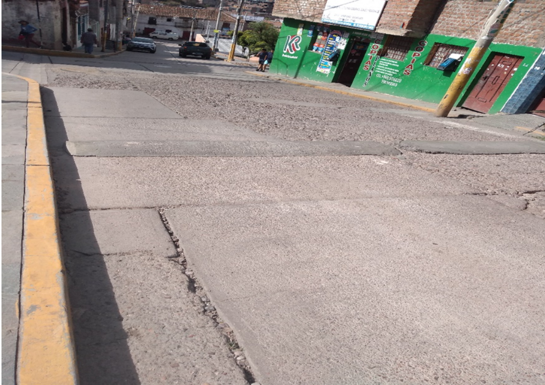
Fotografía 1: Cuadra 1 del jr. Mariano Bellido, Pavimento fracturado.
