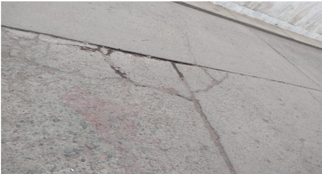
Figura 2.3: Grieta de esquina.
