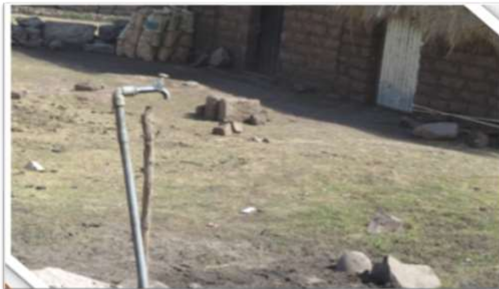
Figura Nro 8:Evidencia del estado actual de las conexiones.
