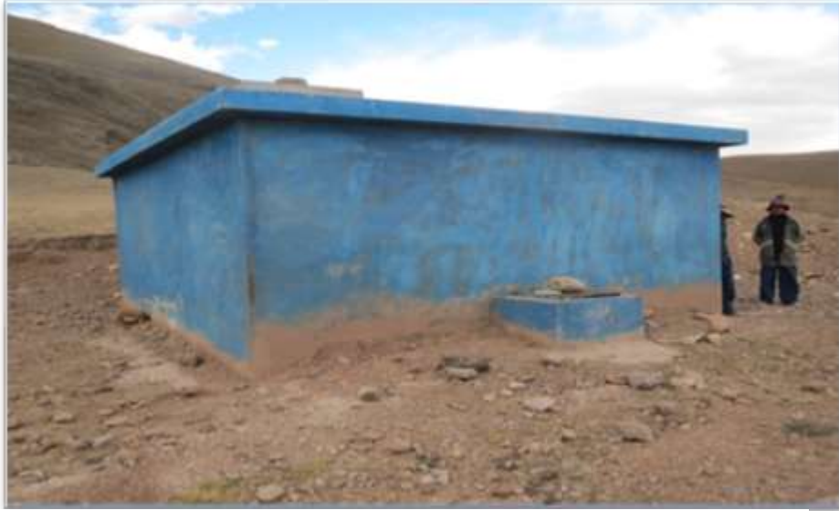
Figura Nro 2 : Reservorio de almacenamiento de 30 m 3
