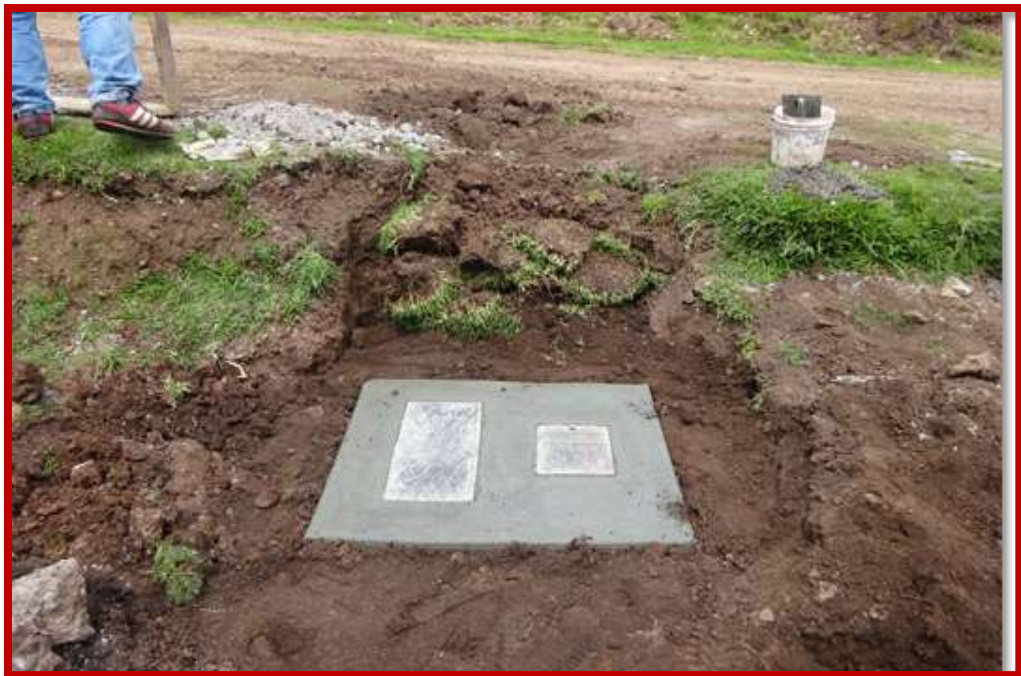
Fotografía N° 05: Cajas domiciliarias de agua y desagüe
