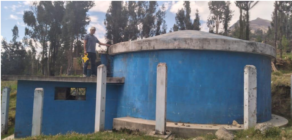
Fotografía 5. Reservorio de 60m 3
