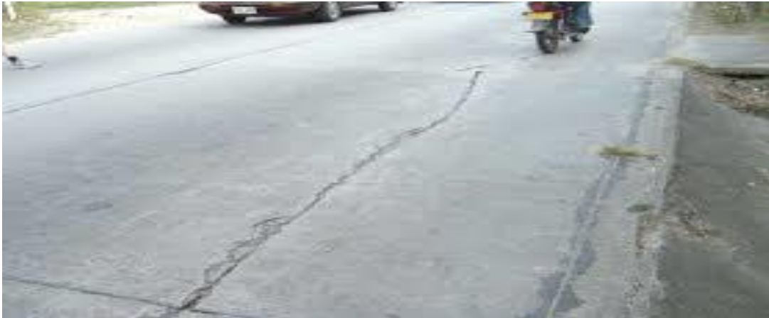
Figura 4 : Deterioro del pavimento rígido con una grieta.
