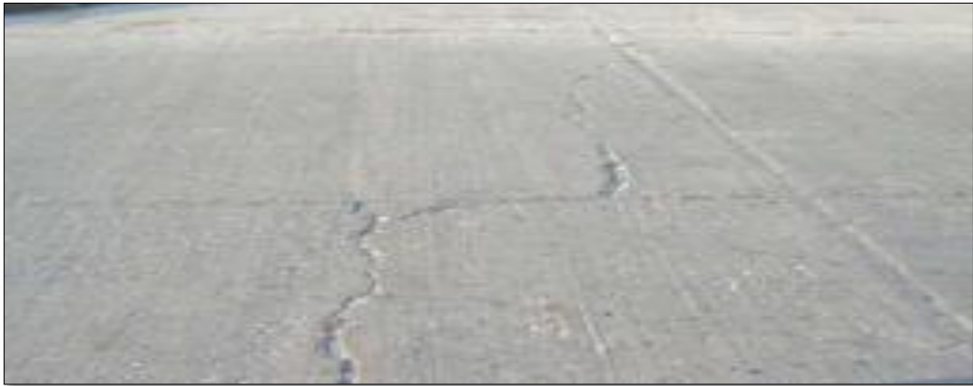
Figura 6 : Una grieta transversal.
