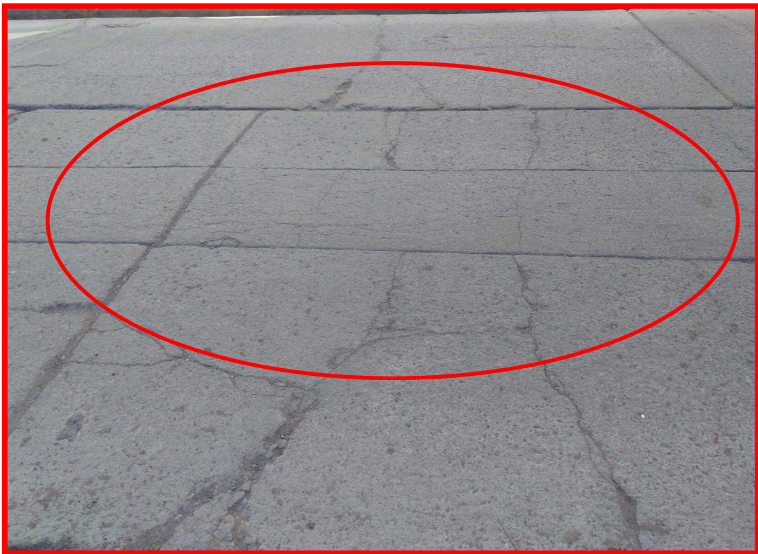
Fotografía 4: como observamos encontramos grietas en bloque de severidad alta.
