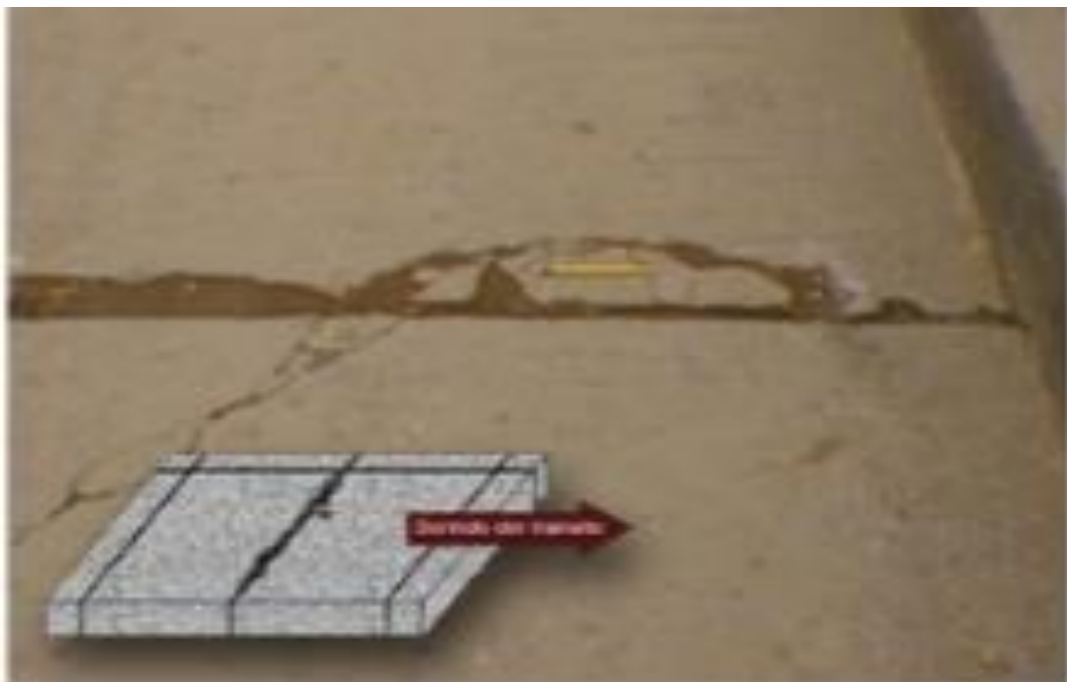
Figura 9 : Deterioro en las juntas longitudinales
