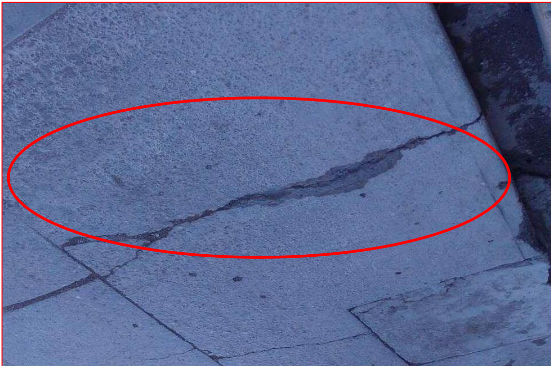
Fotografía 2: como observamos entramos grieta de esquina de severidad media.
