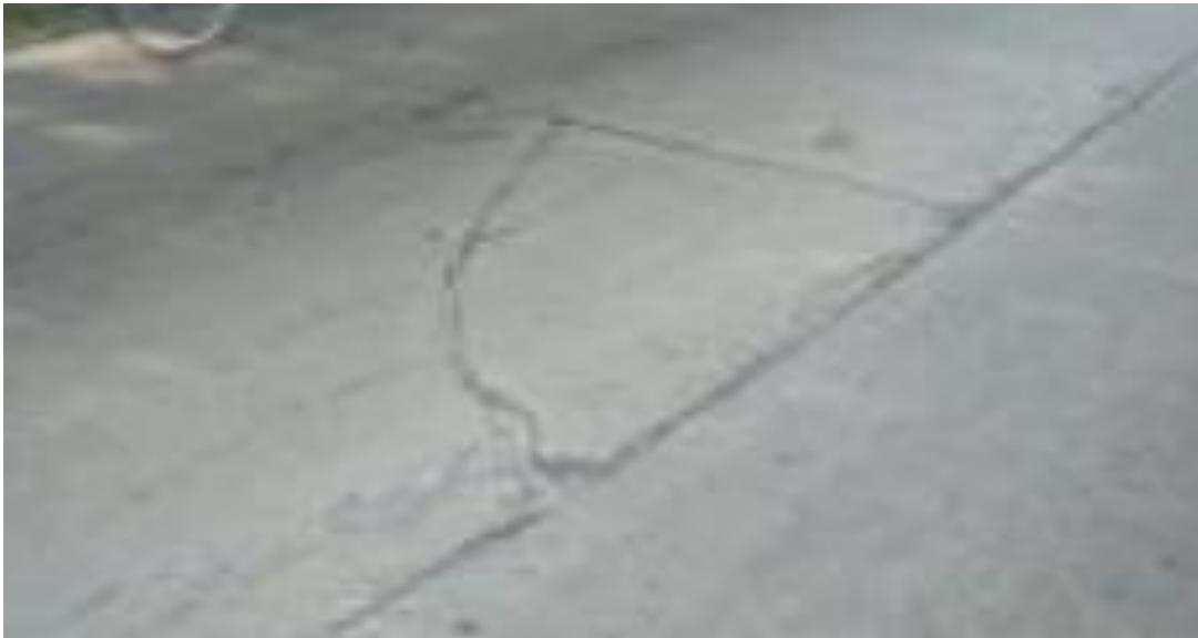
Figura 5 :Deterioro de una hendedura de esquina
