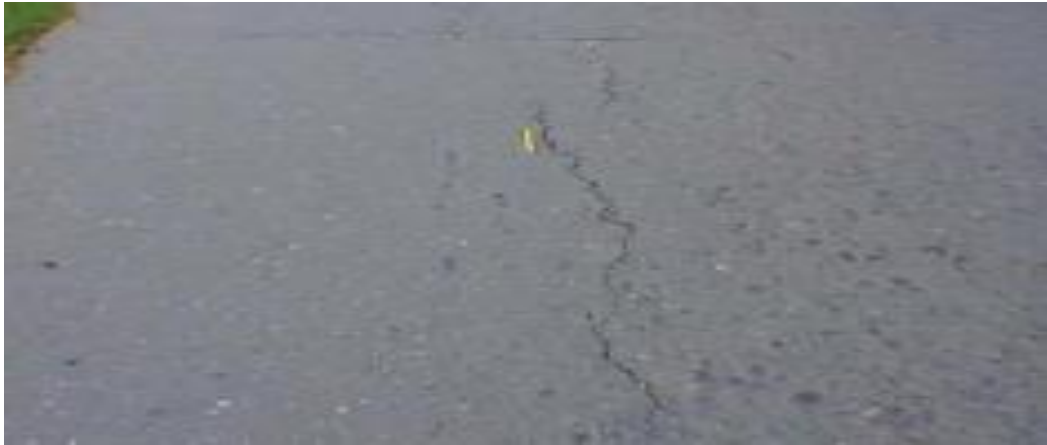
Figura 8 : Deterioro del pavimento rígido con una grieta transversal.
