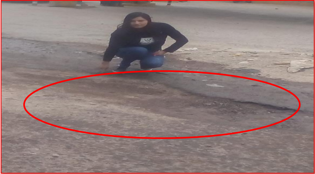
Fotografía 1 : como observamos encontramos un hundimiento con severidad alta presente en la avenida Carmen Alto del paño 0-20.
