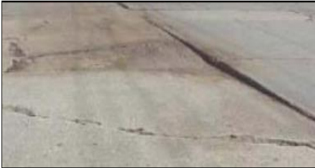
Figura 11: Hundimiento de la losa y su posterior agrietamiento. Fuente: tesis grupo tecnico (2006).
