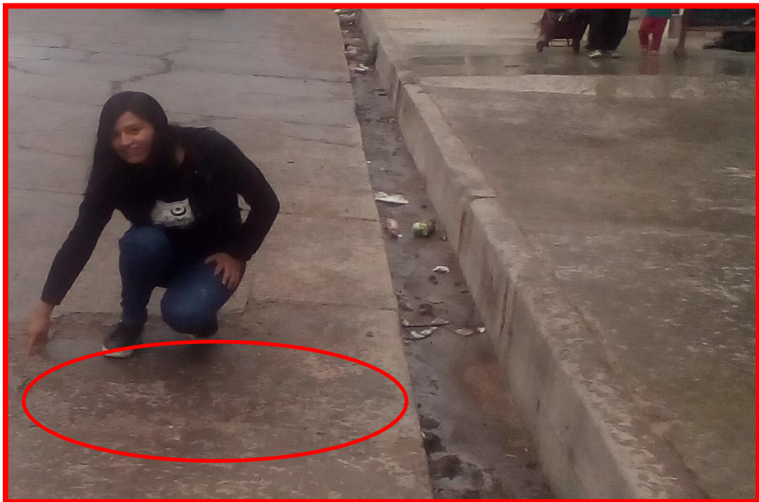
Fotografía 6 : Descascaramiento de esquina de severidad media.
