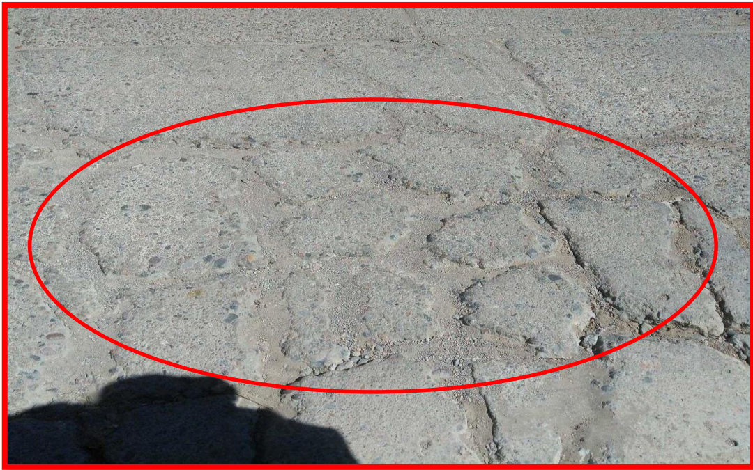
Fotografía 3: como observamos encontramos losas divididas de severidad alta en la avenida Carmen Alto paño de 40.-60.
