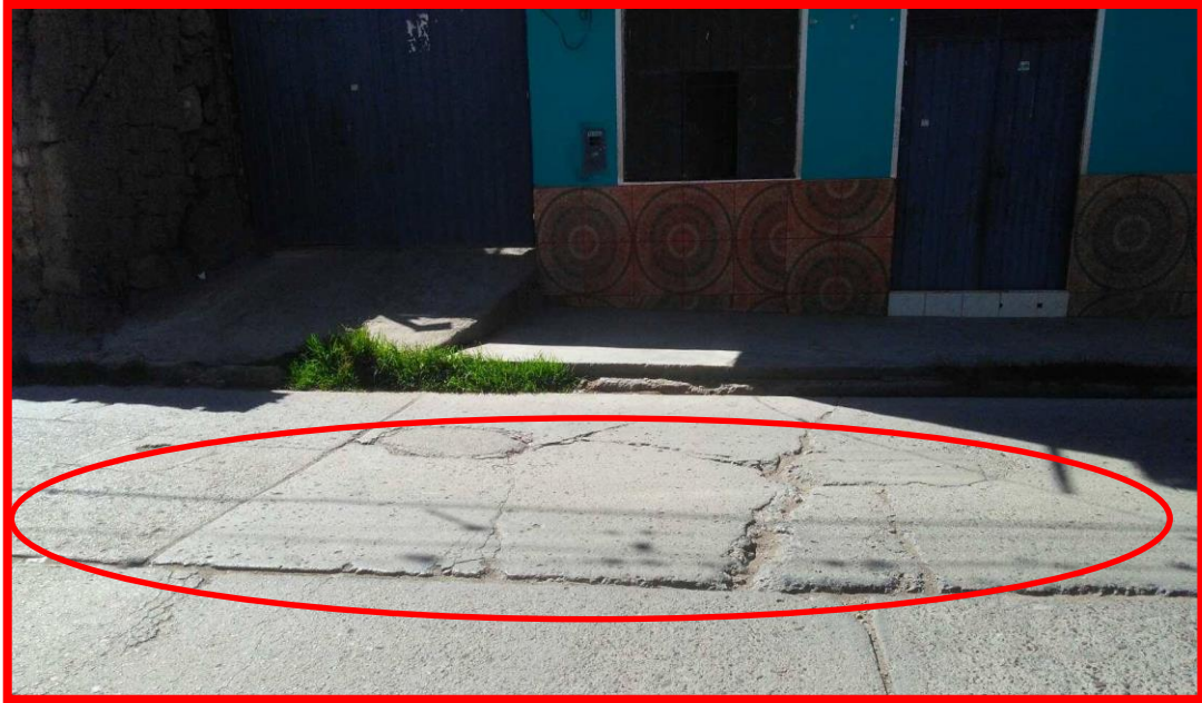
Fotografía 5: observamos Descascaramiento de junta de severidad media paño de 60 a 80.
