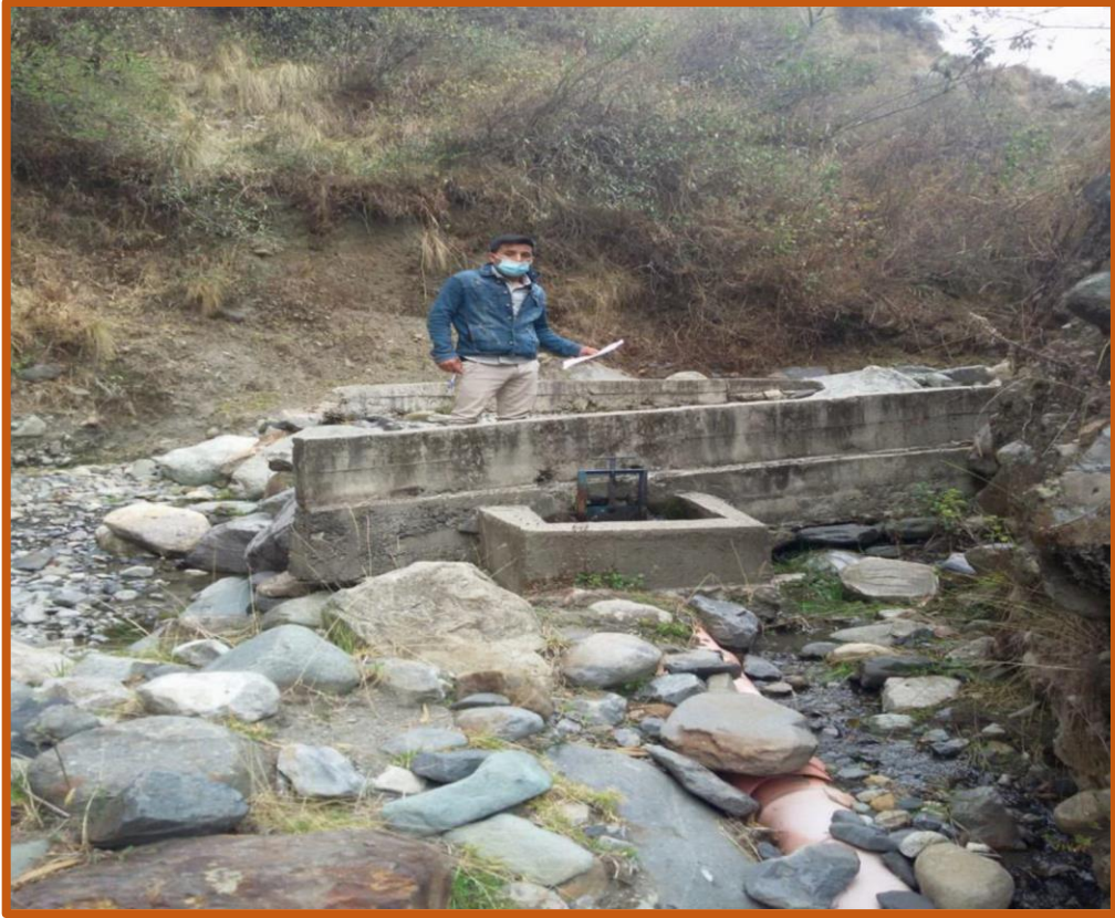
Fotografía 13: Lugar donde desemboca la Filtración, donde la tubería llega a la caja de distribución
