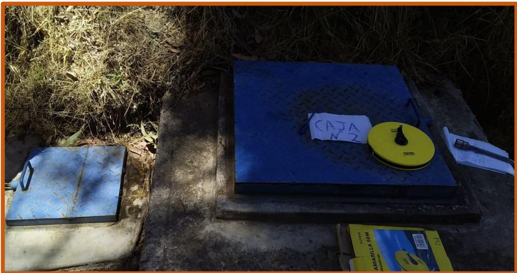
Fotografía 16: Caja de conducción
