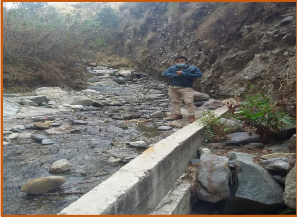
Fotografía 11: zona de filtración del suelo rocoso
