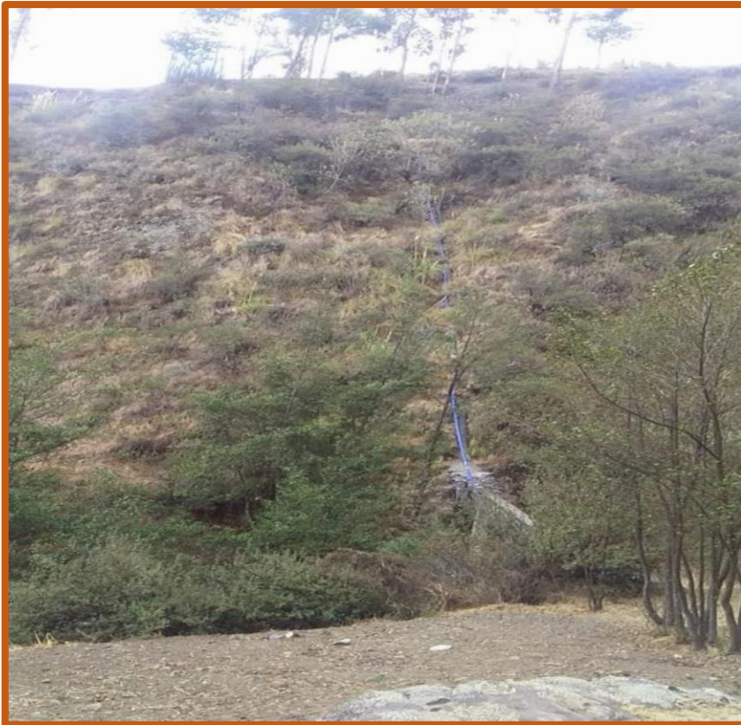
Fotografía 04: Tubería PVC 4" en la quebrada
