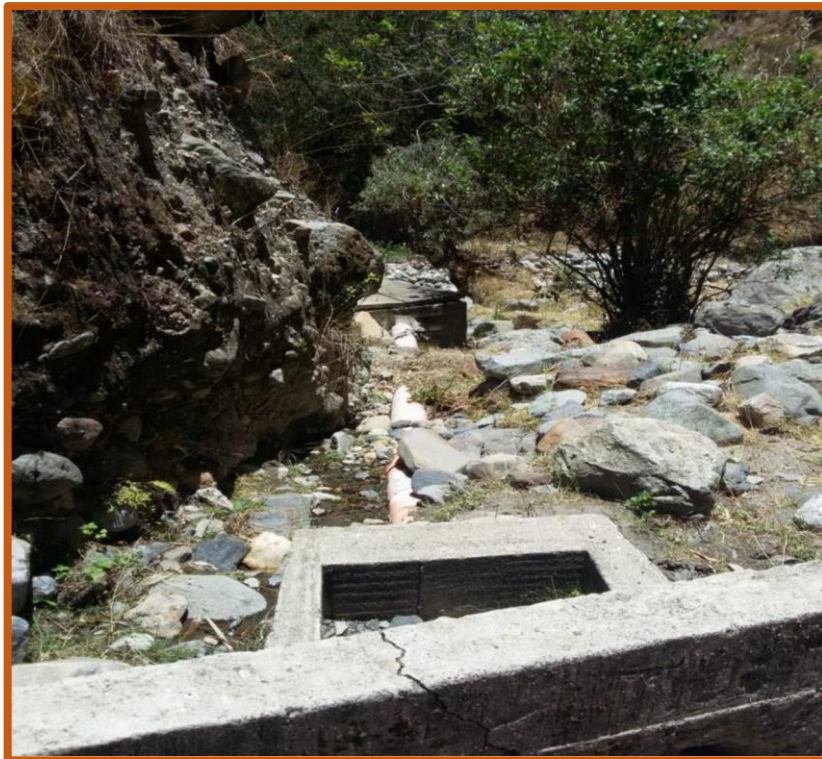
Fotografía 06: Tubería que va a la caja de distribución
