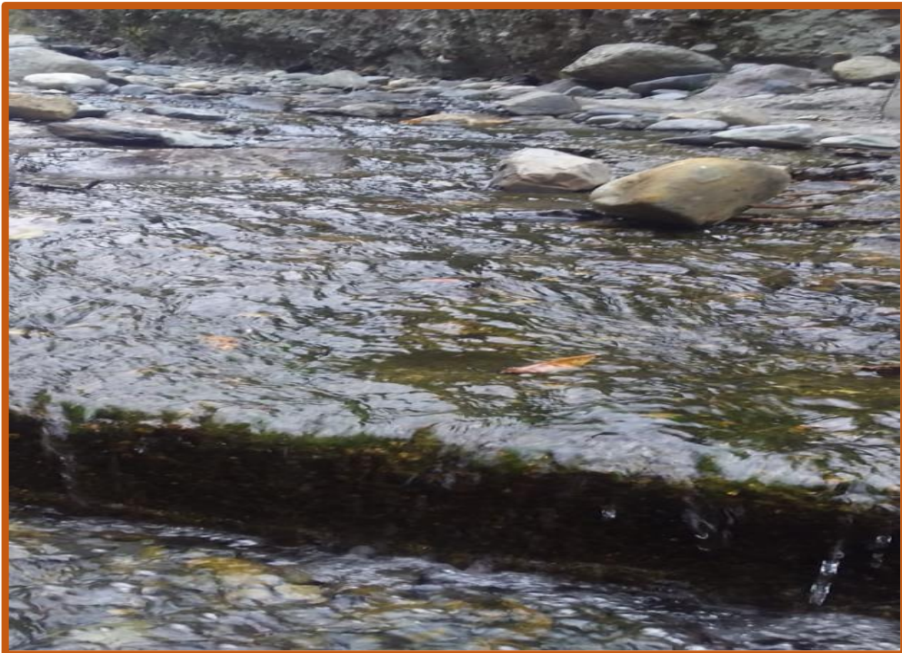
Fotografía 12: filtración de la zona rocosa
