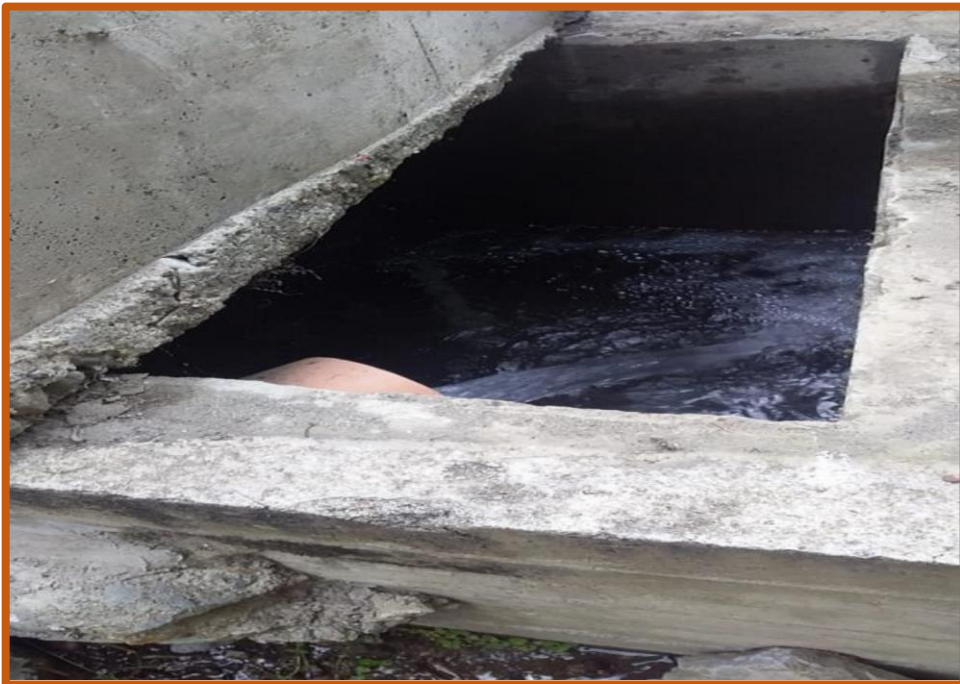
Fotografía 14: Tubería llega a la caja de Distribución
