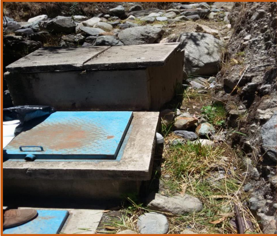
Fotografía 07: Tapa de la caja de distribución
