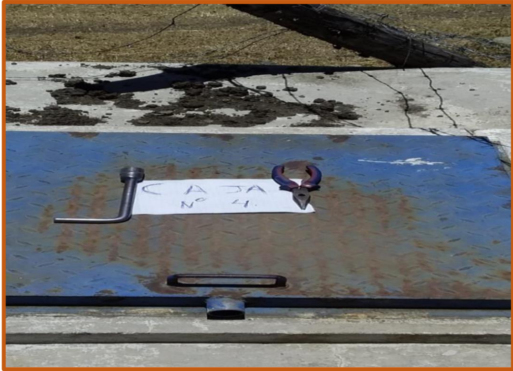
Fotografía 18: Caja de Romper presión
