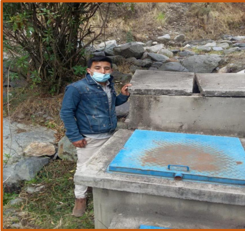
Fotografía 05: Caja de distribución
