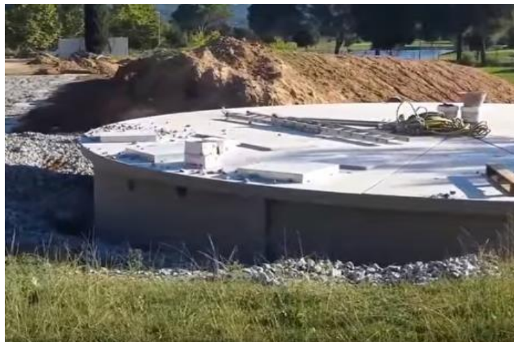
Figura 15: Reservorio enterrado. Fuente: Aquadiposits (2015).
