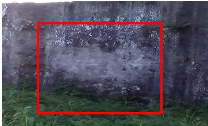
Figura 16. Eflorescencia en muros Nota. Fuente: (Elaboración propia)
