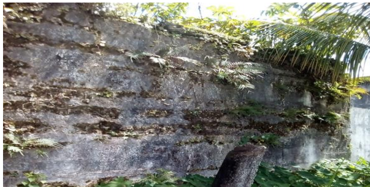
Figura 17. Muros infectados por organismos Nota. Fuente: (Elaboración propia)
