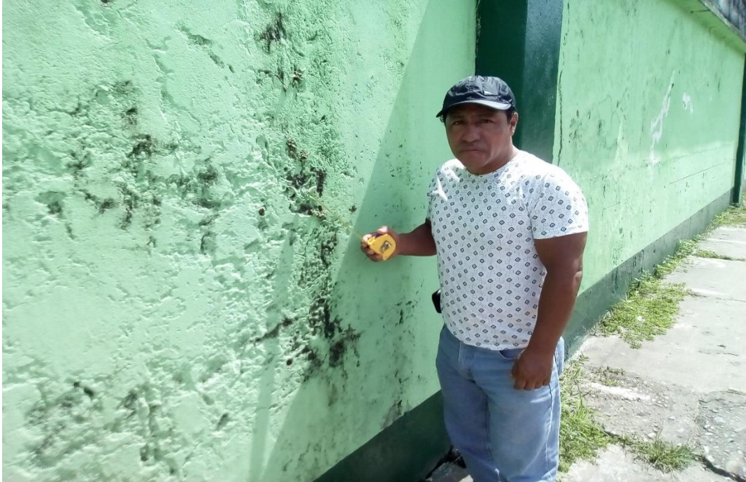
Fotografía 03. Erosión en el cerco perimétrico del cementerio Municipal
