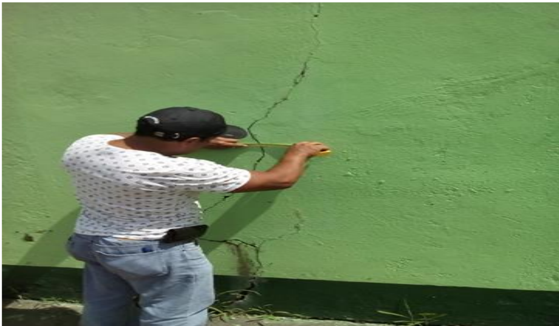
Fotografía 02. Grieta en el cerco perimétrico del cementerio Municipal
