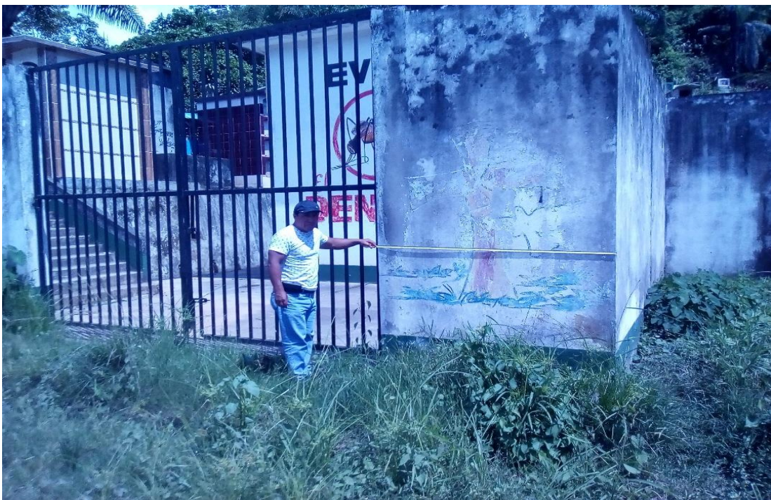
Fotografía 04. Eflorescencia en el cerco perimétrico del cementerio Municipal
