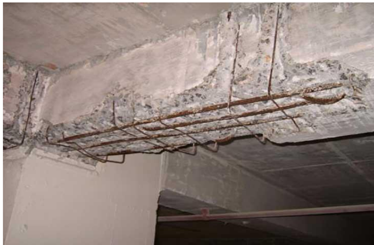
Figura 10. Patología en viga de concreto – corrosión Nota. Fuente: (Vélez L. 2009) 24
