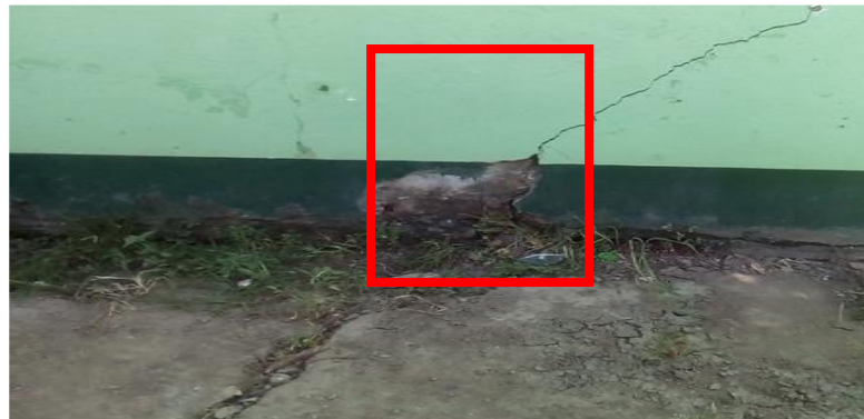
Figura 15. Desprendimiento Nota. Fuente: (Elaboracion propia)
