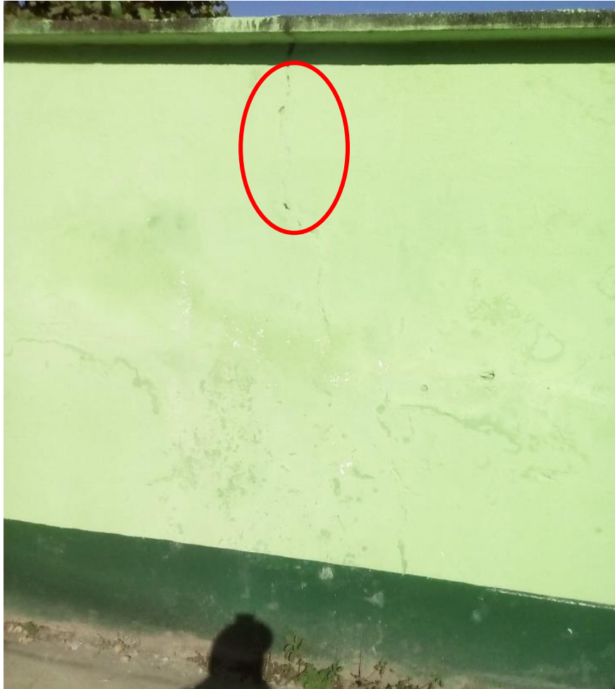
Fotografía 05. Fisura en el cerco perimétrico del cementerio Municipal
