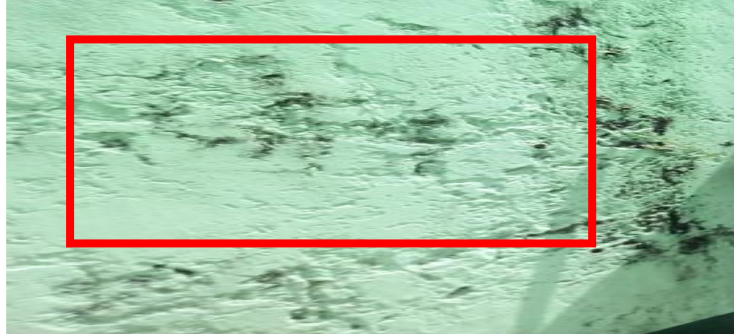
Figura 11. Erosión en muro de albañilería
