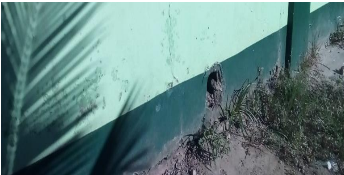
Fotografía 06. Erosión en el cerco perimétrico del cementerio Municipal
