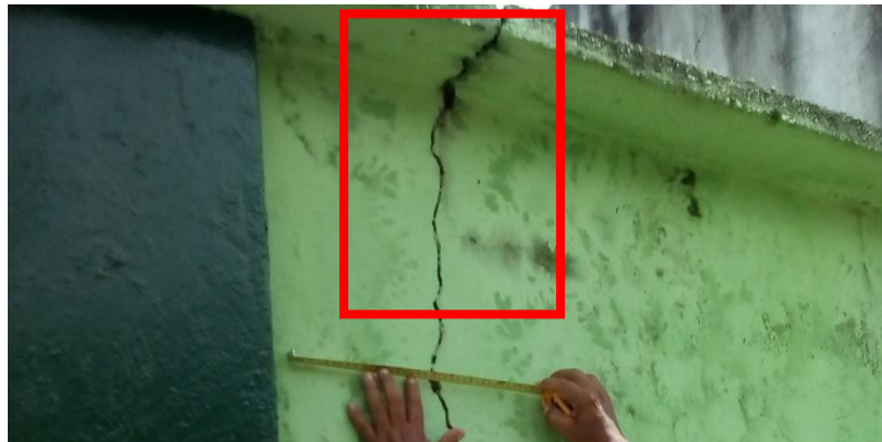
Figura 14. Grieta Longitudinal Nota. Fuente: (Elaboracion propia)
