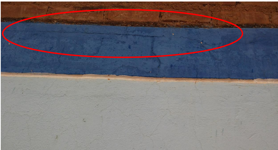
Fotografía 02: Patología Fisura en el muro del cerco perimétrico
