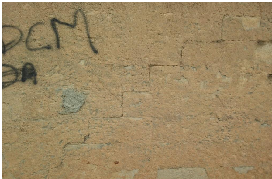
Figura 14. Grieta en muro de albañilería Nota. Fuente: Elaboración Propia
