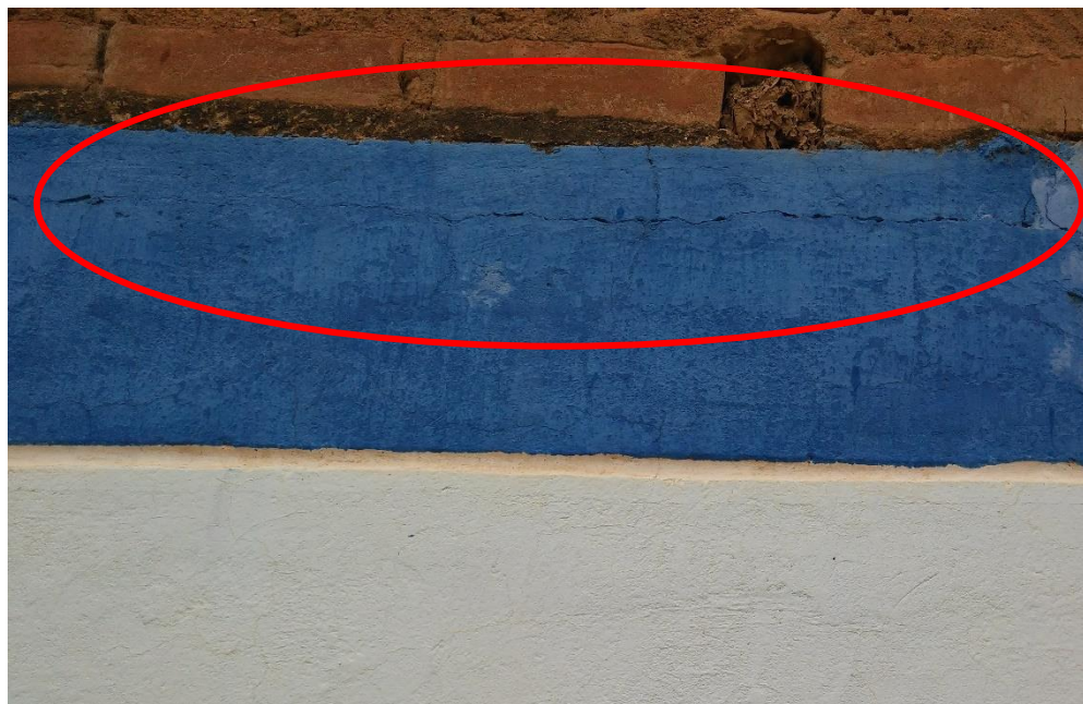
Figura 15. Fisura Nota. Fuente: Elaboración Propia
