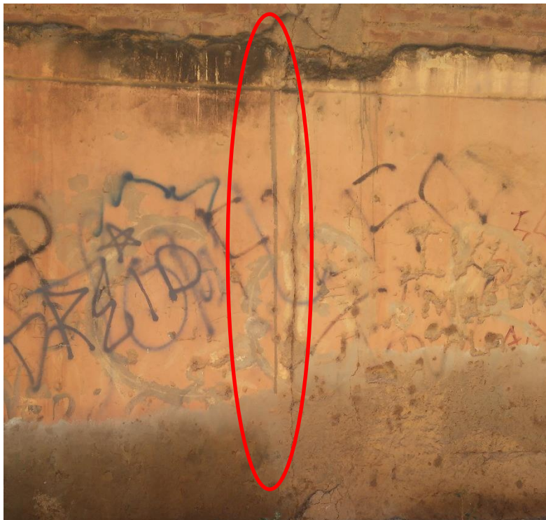
Fotografía 06: Patología Grieta en el muro del cerco perimétrico
