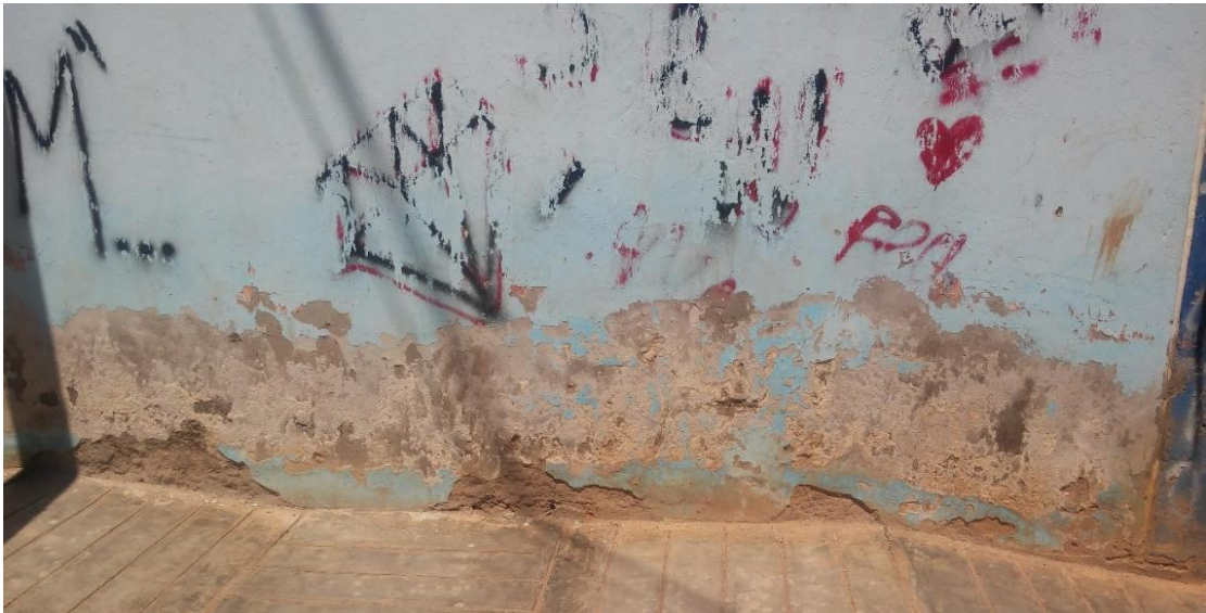
Fotografía 03: Patología Eflorescencia en el muro del cerco perimétrico
