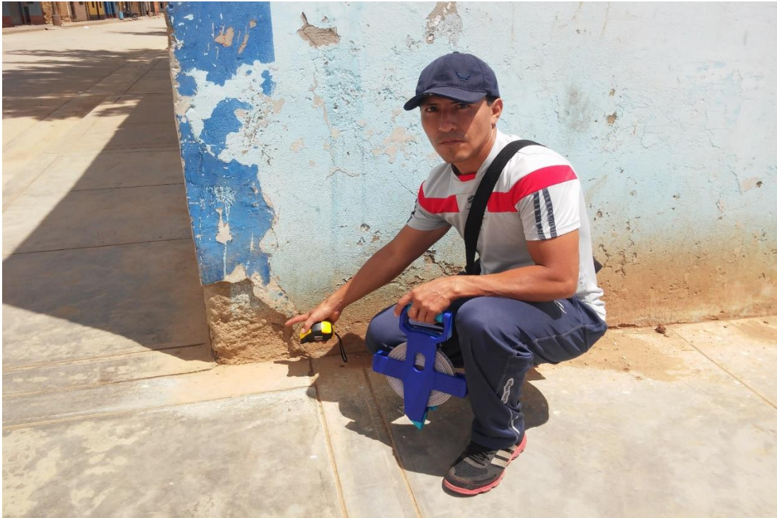
Fotografía 01: Patología desprendimiento en la columna del cerco perimétrico
