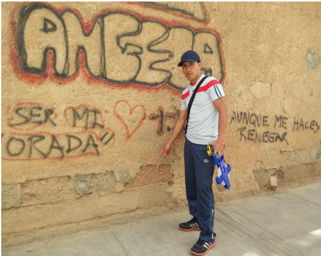
Fotografía 04: Patología Desintegración en el muro del cerco perimétrico
