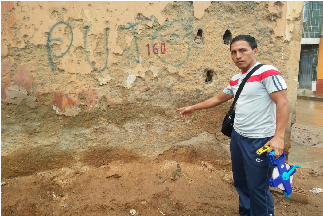
Fotografía 07: Patología Descascaramiento en el muro del cerco perimétrico
