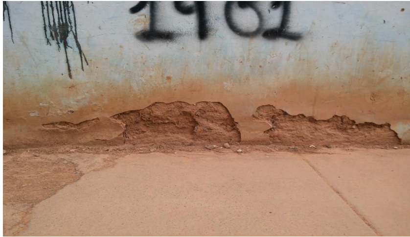
Figura 11. Desprendimiento Nota. Fuente: Elaboración Propia
