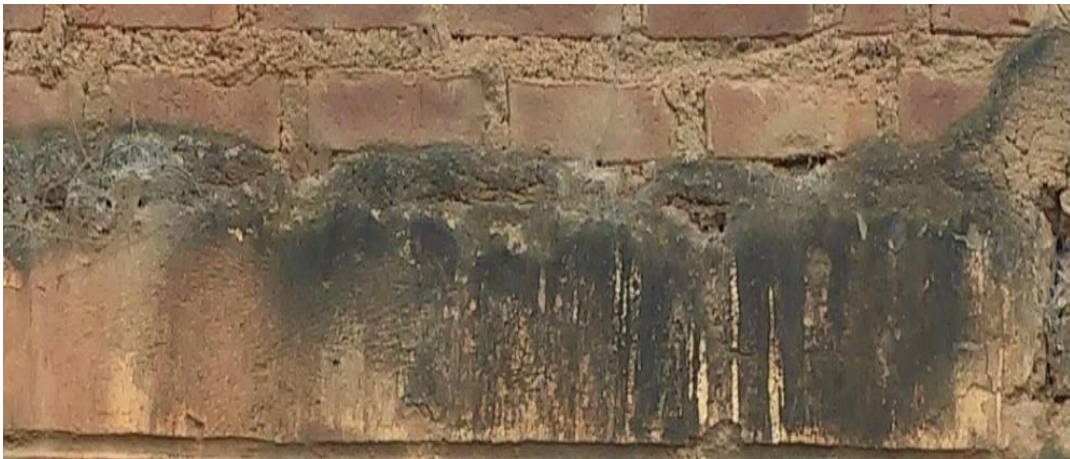
Fotografía 08: Patología Organismo en el muro del cerco perimétrico
