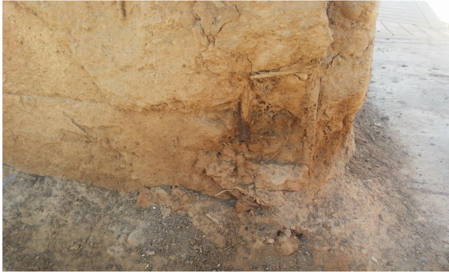
Figura 17. Corrosión en el acero de la columna Nota. Fuente: Elaboración Propia
