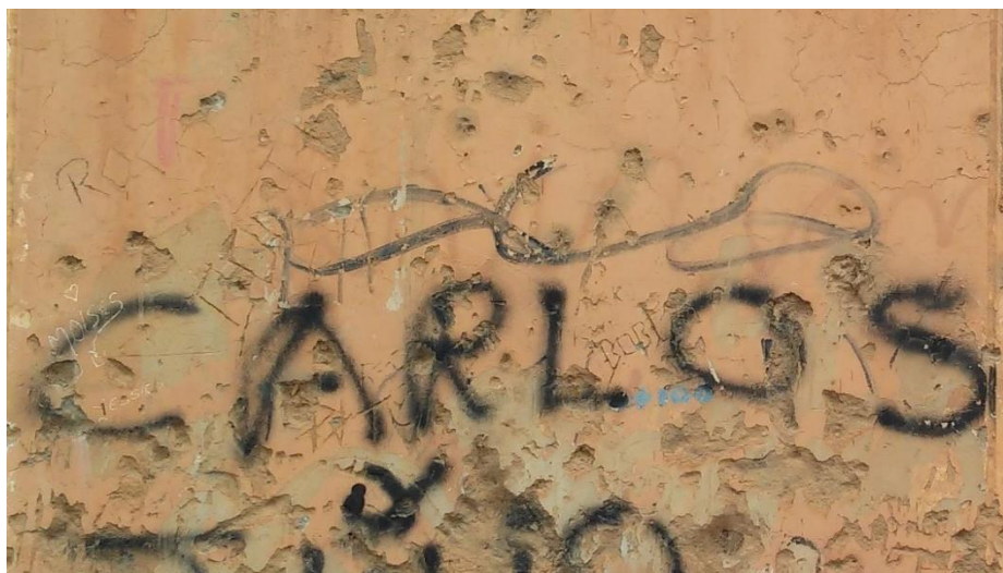
Figura 10. Descascaramiento Nota. Fuente: Elaboración Propia
