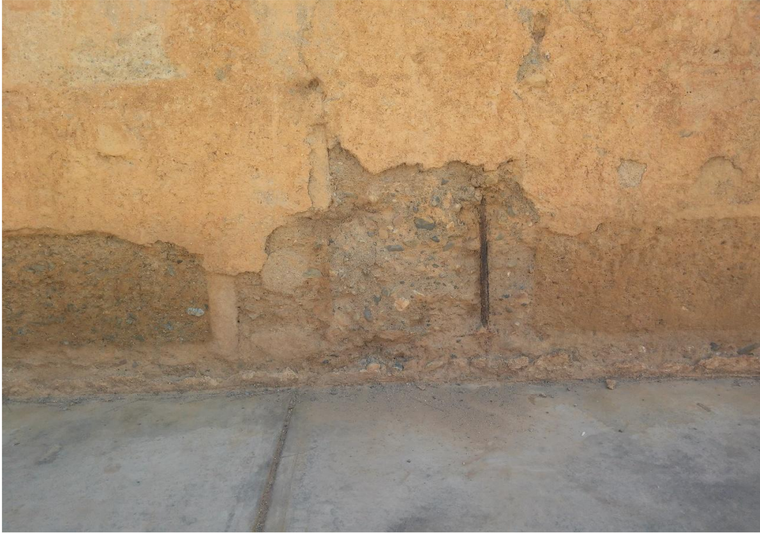
Fotografía 05: Patología Corrosión en columna del cerco perimétrico
