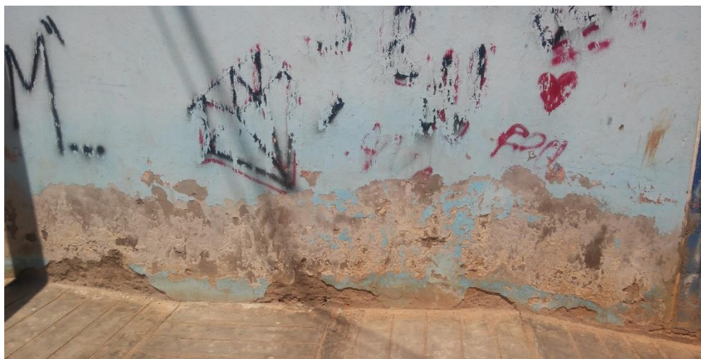
Figura 12. Eflorescencia Nota. Fuente: Elaboración Propia
