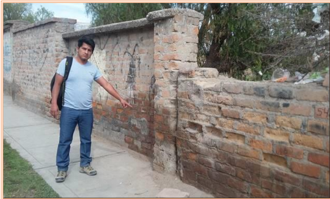
Figura 20: Imagen de la verificación de los daños ocasionados por las patologías más comunes.
