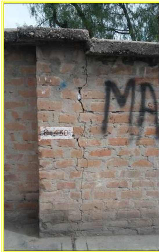
Figura 18: En la imagen se puede observar las grietas en los muros de la UNSCH
