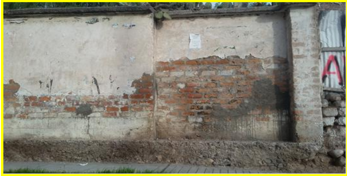
Figura 4: Fotografía de paño o muestra 01 con humedad y erosión.
