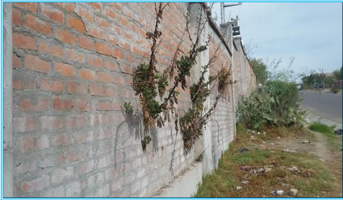
Figura 19: Se observa en la imagen grietas ocasionadas por las plantas en los muros de la UNSCH.
