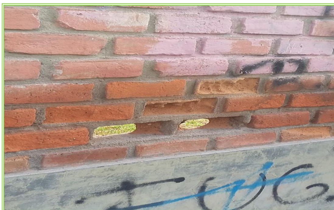
Figura 14: Daños ocasionados por la erosión en los muros de la UNSCH.
