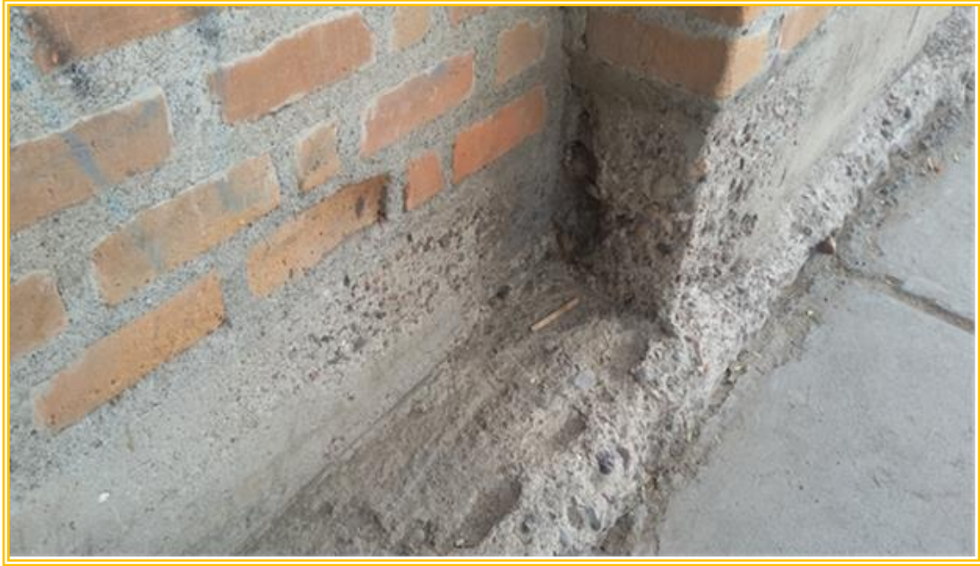
Figura 15: Desprendimiento de concreto en el sobrecimiento.
