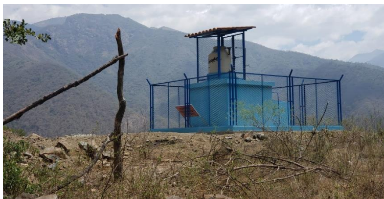
Gráfico 7: Estación de Bombeo
