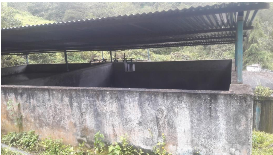
Fotografía N° 06: Planta de Tratamiento de Agua Potable
