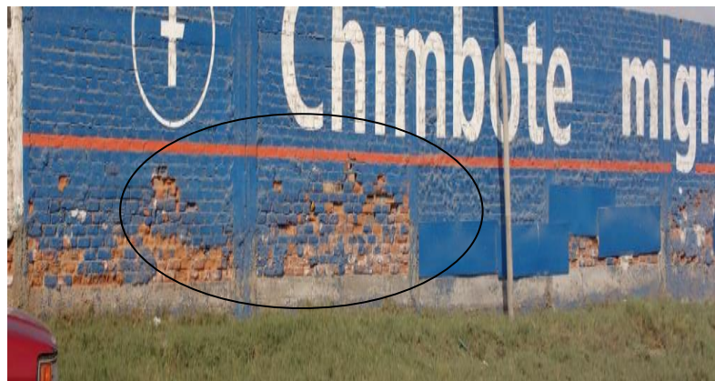
Figura 19. Presencia de desintegración en un muro. Nota. Fuente elaboración propia. (2016)
