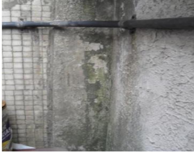
Figura 1. Humedad y erosión en pared.
