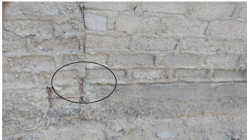
Figura 22. Varillas de acero afectadas por corrosión. Nota. Fuente elaboración propia. (2016)
