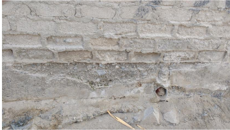
Figura 23. Deterioro de estructura de concreto. Nota. Fuente elaboración propia. (2016)
