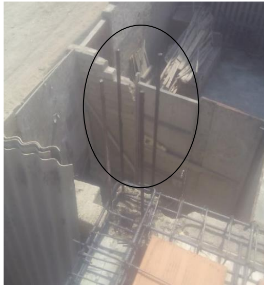
Figura 21. Fierro con presencia de óxido. Nota. Fuente elaboración propia. (2016)
