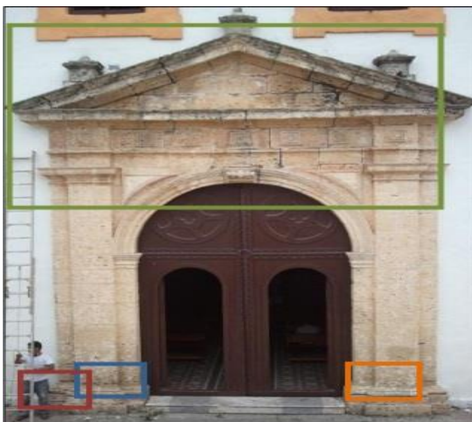
Figura 2. En la entrada de la Iglesia se aprecia humedad erosión y desintegración.
