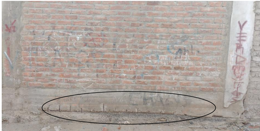
Figura 15. Elemento afectado por erosión. Nota. Fuente elaboración propia. (2016)
