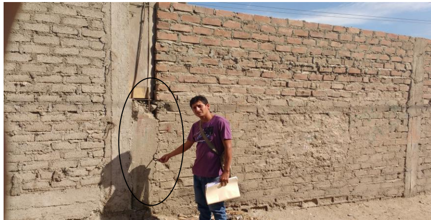
Figura 16. Muro agrietado verticalmente. Nota. Fuente elaboración propia. (2016)
