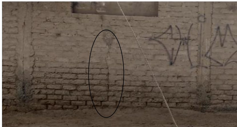
Figura 17. Muro fisurado verticalmente. Nota. Fuente elaboración propia. (2016)
