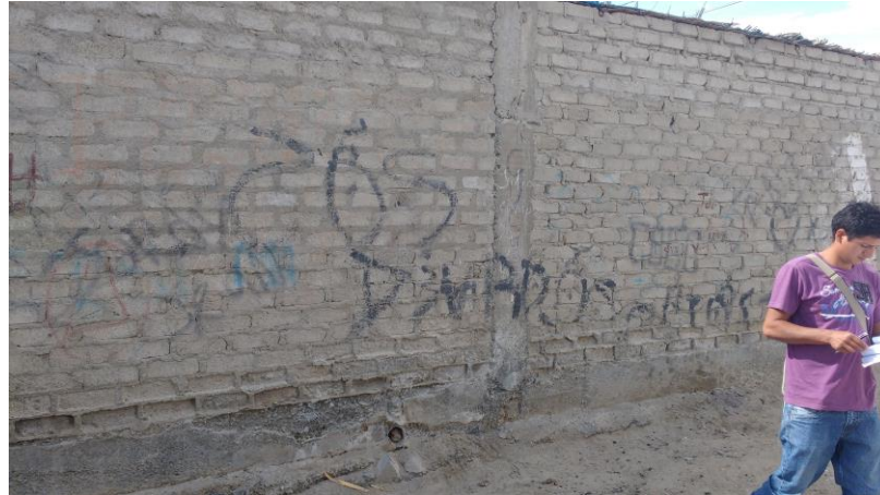
Figura 14. Patología en muro.
