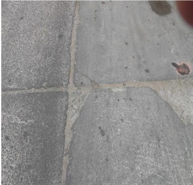
Grieta de Esquina N° 01
