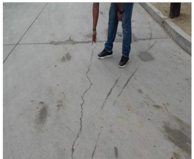
Grieta Longitudinal N° 02
