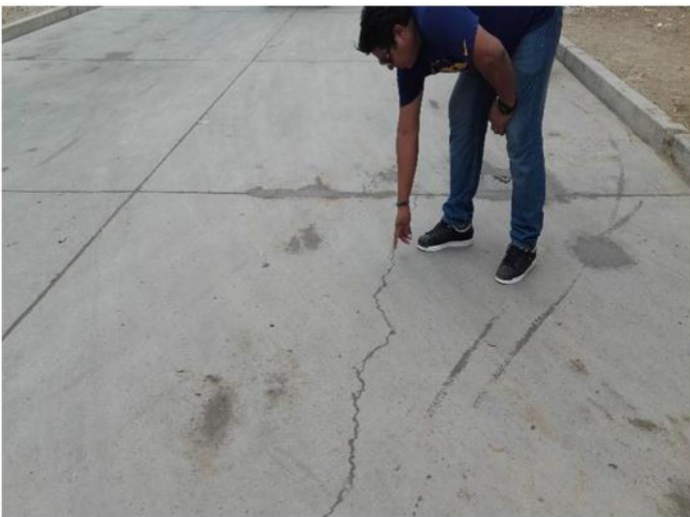
Grieta Longitudinal N° 01
