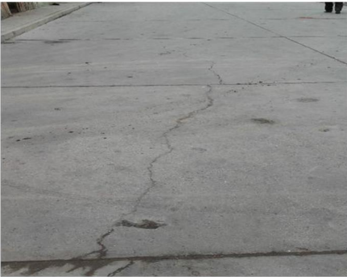
Grieta Longitudinal N° 05
