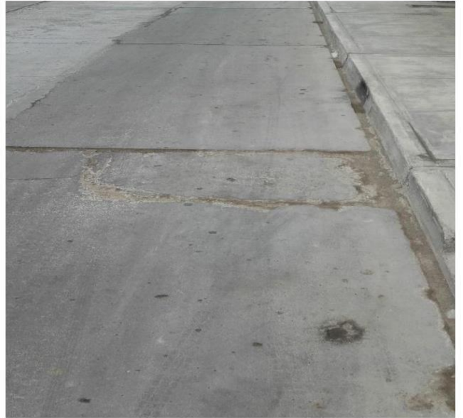
Grieta de Esquina N° 02
