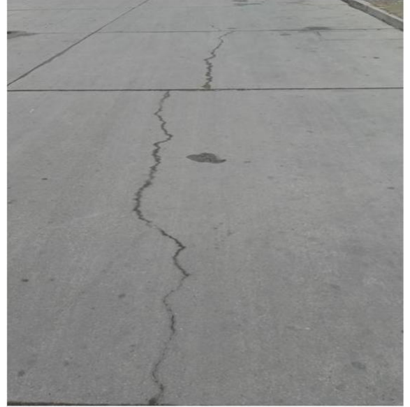
Grieta Longitudinal N° 04
