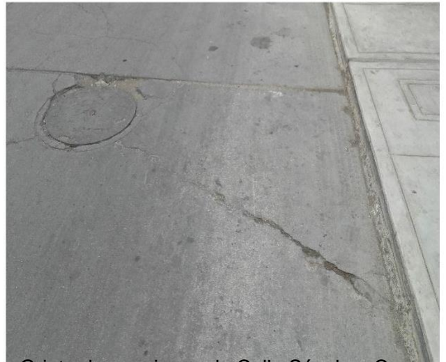
Grieta de esquina en la Calle Sánchez Cerro
