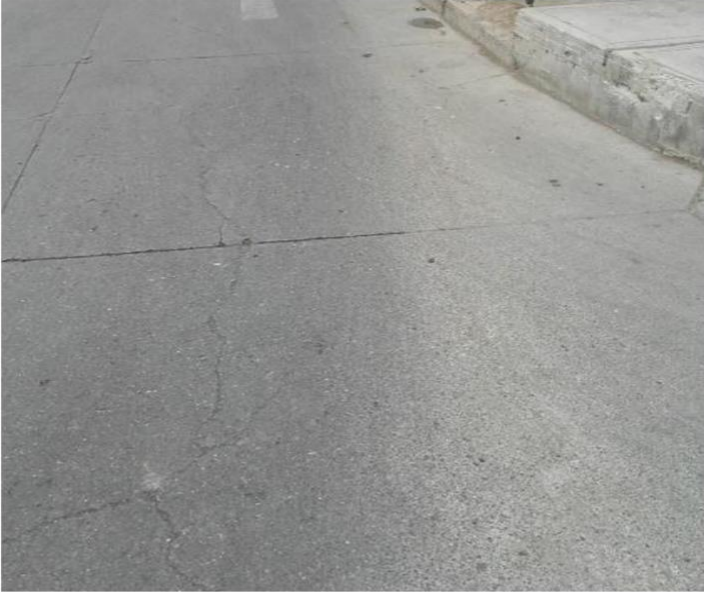
Grieta Longitudinal N° 03
