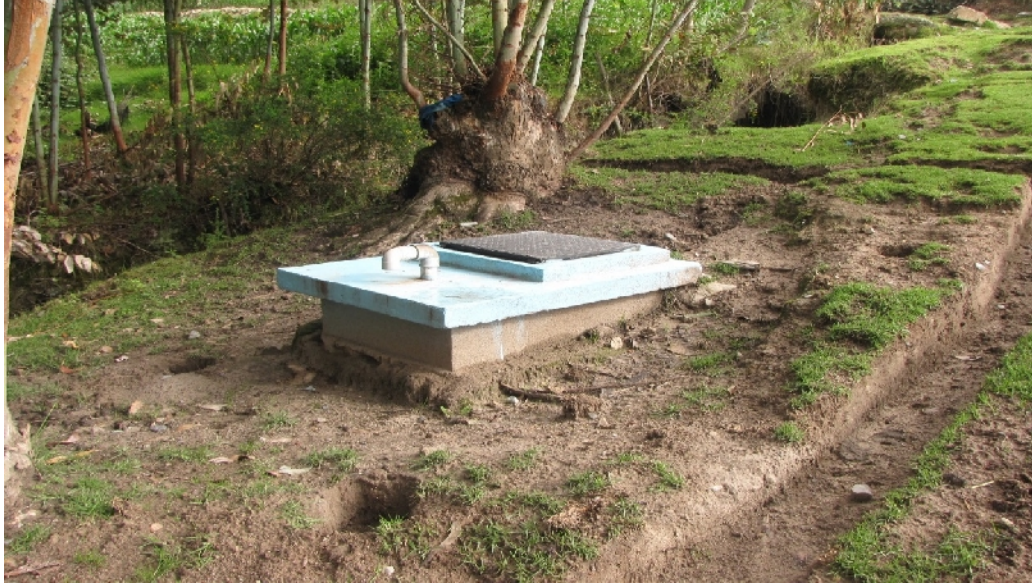
Fotografía 9. Cámara rompe presión
