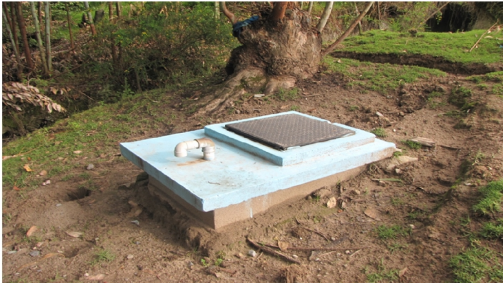
Fotografía 8. Cámara rompe presión
