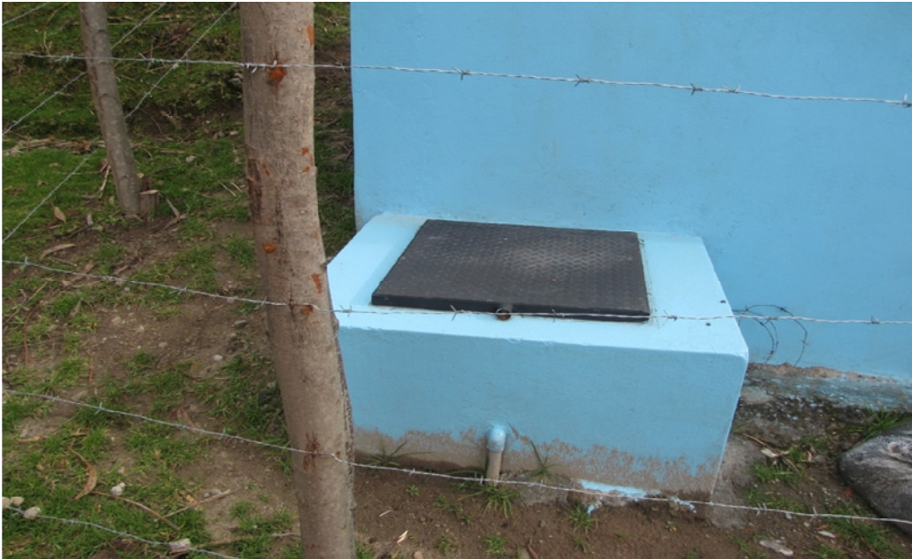
Fotografía 6. Caja de válvulas
