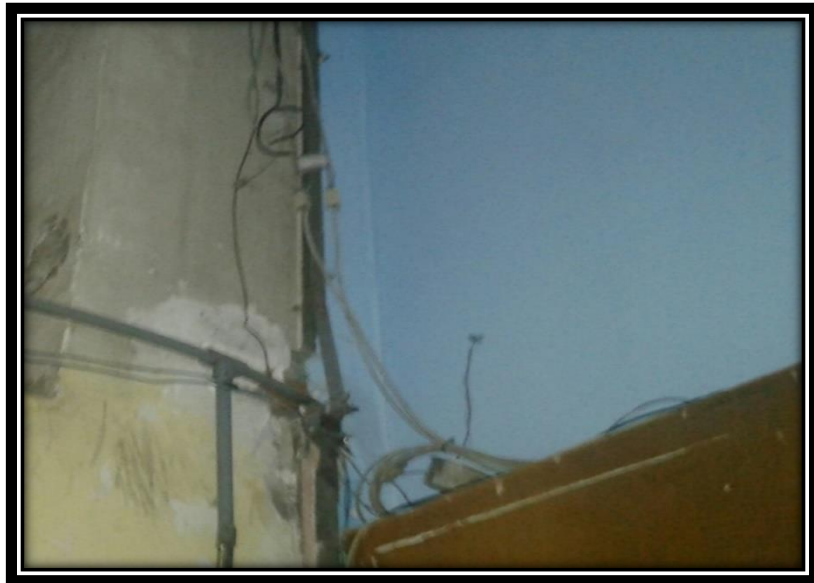
FOTOGRAFÍA N° 3: Cableado en mal estado
