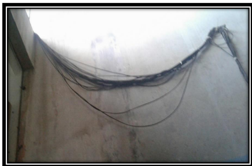
FOTOGRAFÍA N° 2: Cableado en mal estado
