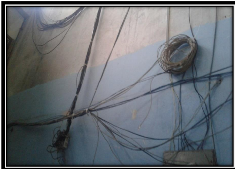
FOTOGRAFÍA N° 1: Cableado en mal estado
