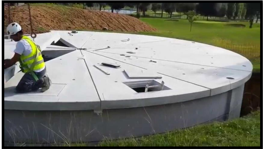
Figura 17. Reservorio circular enterrado.
