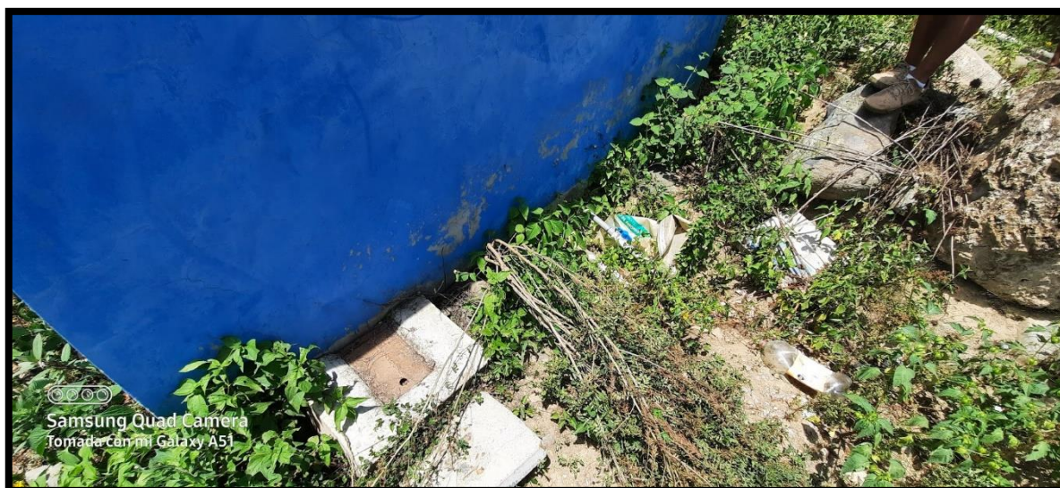
Imagen 25. Línea de aducción.
