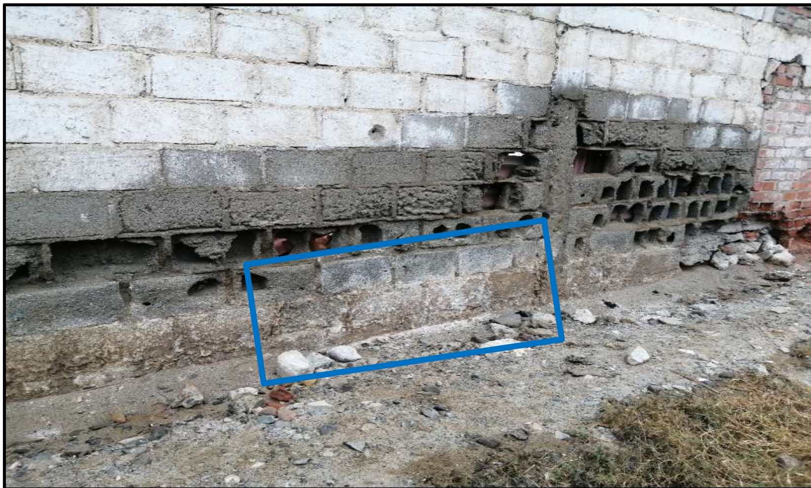
Fotografía 6: Patología Eflorescencia presente en el Muro en la Fábrica Corporación del Mar S.A. en la Unidad Muestral 13.
