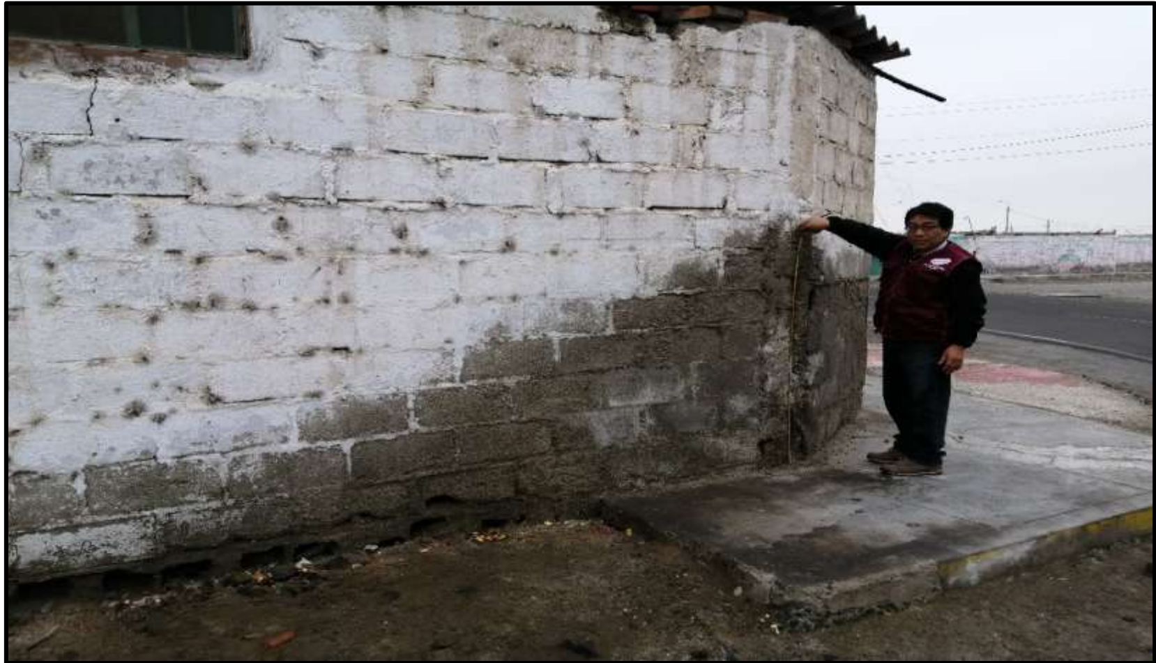
Fotografía 14: Midiendo la patología Corrosión presente en la Columna de la Fábrica Corporación del Mar S.A. en la Unidad Muestral 01.
