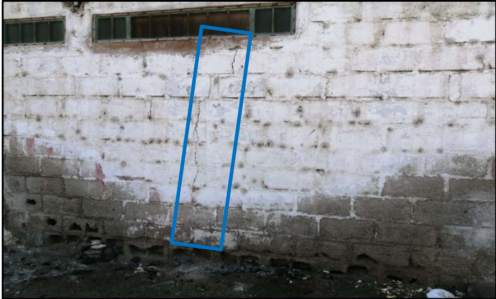
Fotografía 11: Patología Fisura presente en el Muro en la Fábrica Corporación del Mar S.A. en la Unidad Muestral 01.
