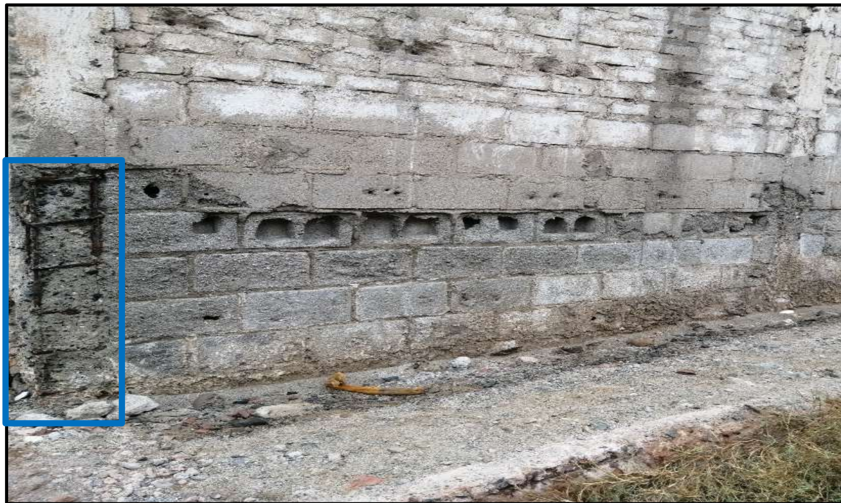
Fotografía 4: Patología Corrosión presente en la Columna en la Fábrica Corporación del Mar S.A. en la Unidad Muestral 15. Fuente: Elaboración propia. (2019).
