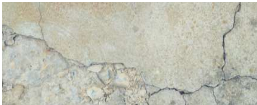
Figura 24: Fisuras en un Muro.
