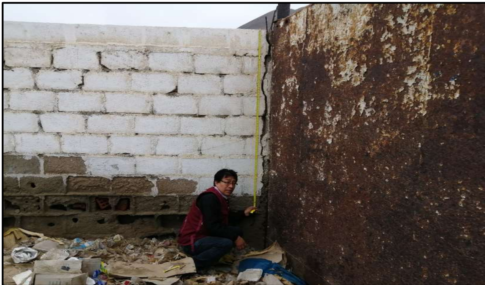
Fotografía 18: Midiendo la patología Grieta presente en la Columna de la Fábrica Corporación del Mar S.A. en la Unidad Muestral 05.
