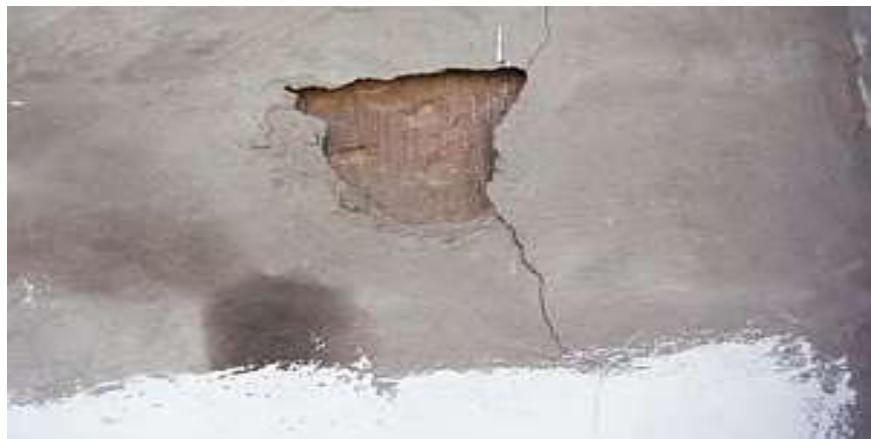
Figura 26: Desprendimiento en un Muro.
