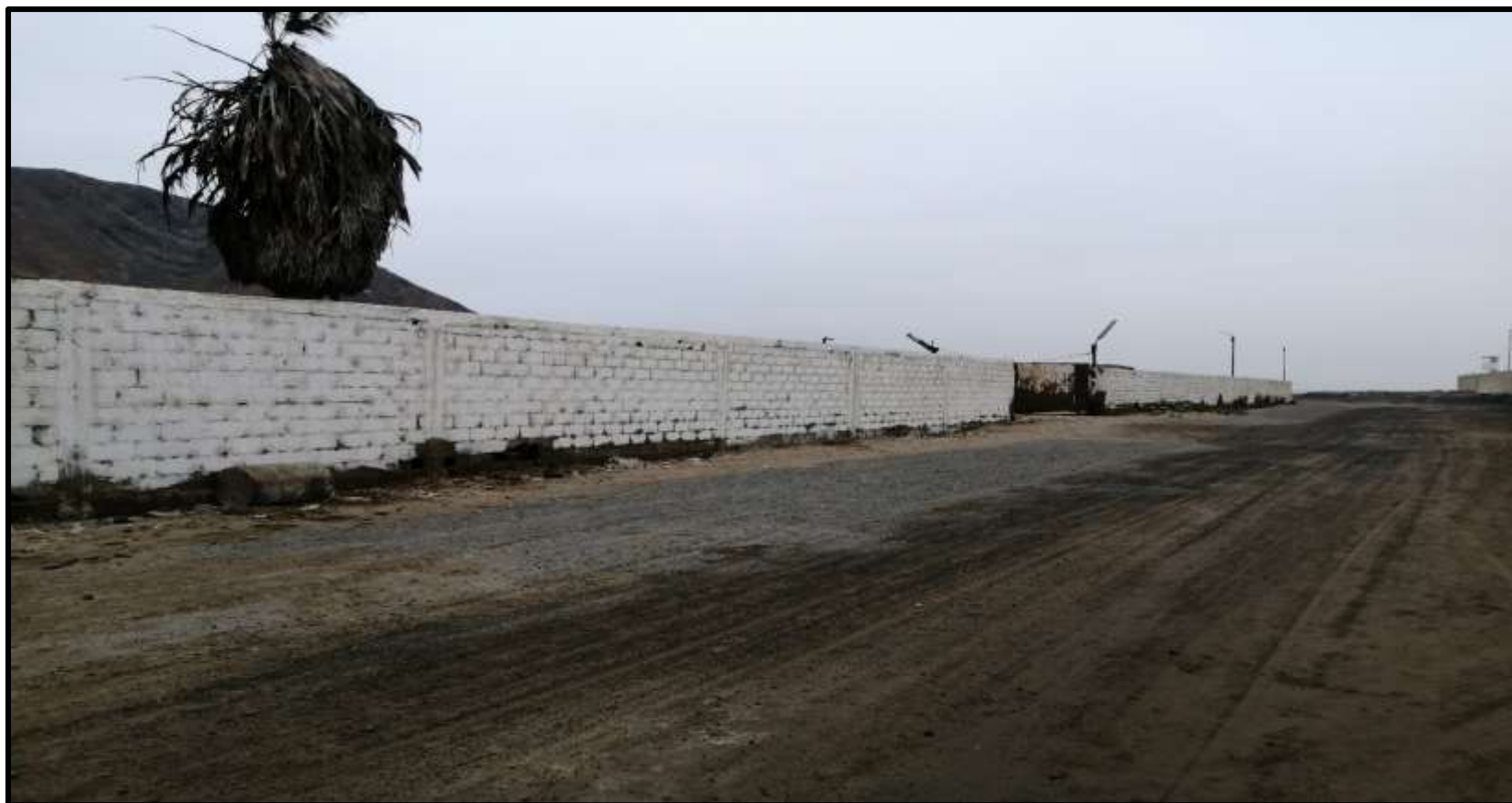
Fotografía 2: Vista del tramo 1 – 2 del cerco perimétrico de la Fábrica Corporación del Mar S.A., Distrito de Comandante Noel, provincia de Casma, región Áncash.
