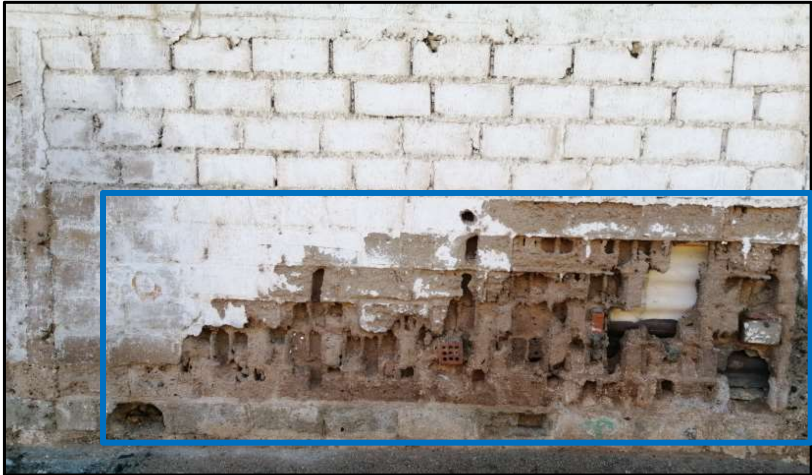
Fotografía 9: Patología Erosión presente en el Muro en la Fábrica Corporación del Mar S.A. en la Unidad Muestral 09. Fuente: Elaboración propia. (2019).
