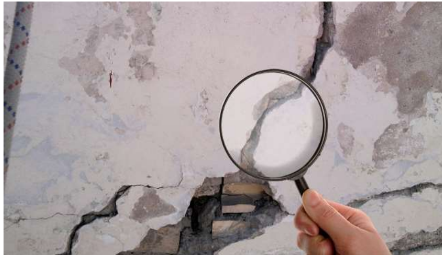
Figura 21: Patología Grieta en un Muro.
