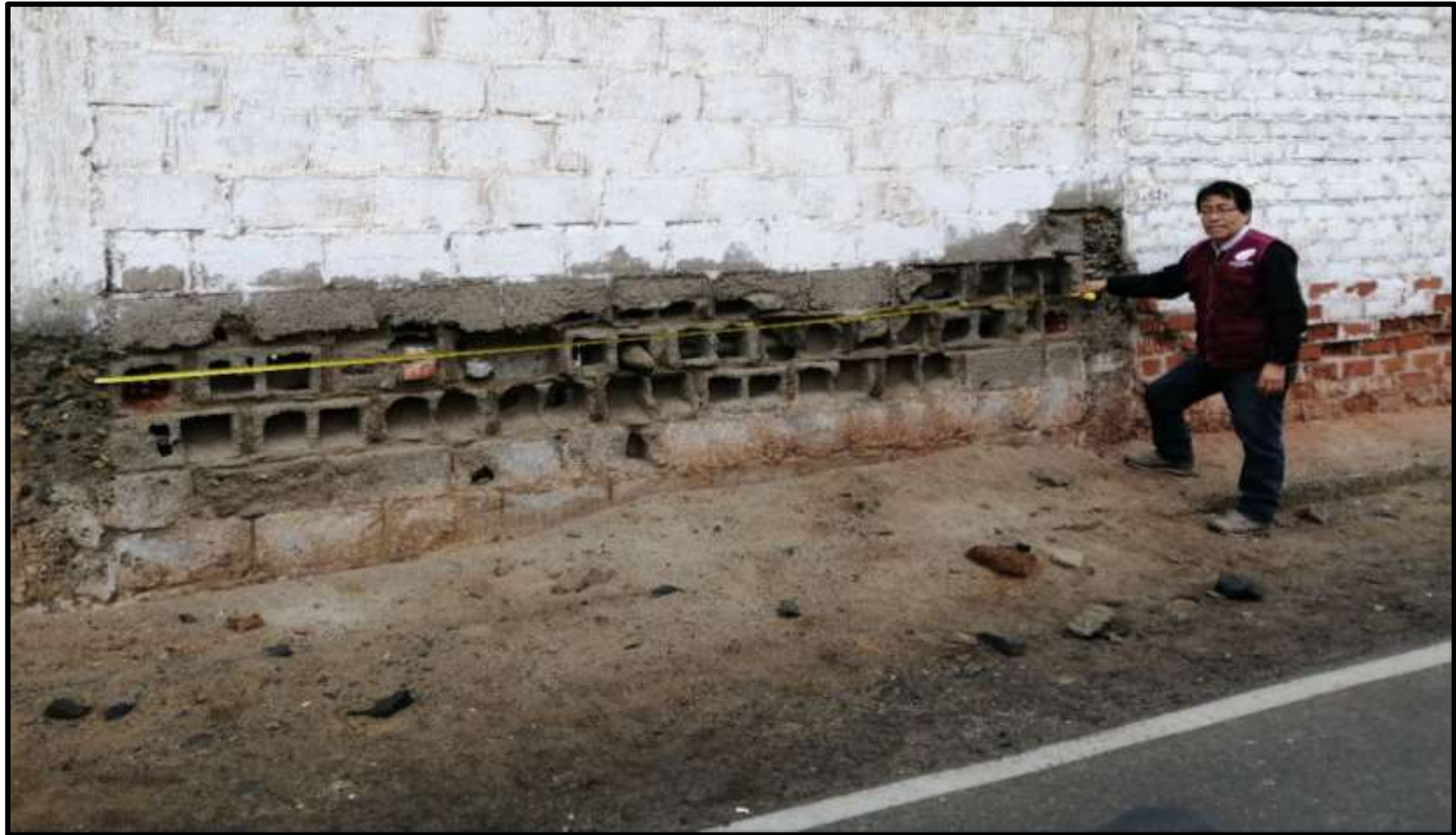
Fotografía 16: Midiendo la patología Erosión presente en el Muro de la Fábrica Corporación del Mar S.A. en la Unidad Muestral 12.
