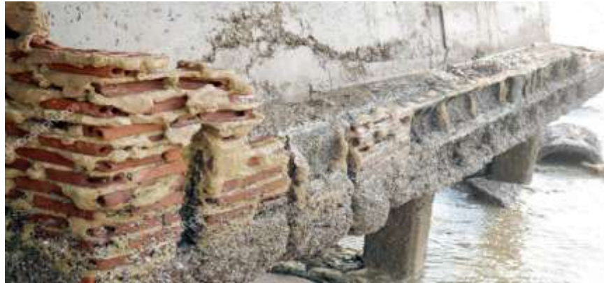
Figura 23: Erosión del ladrillo.
