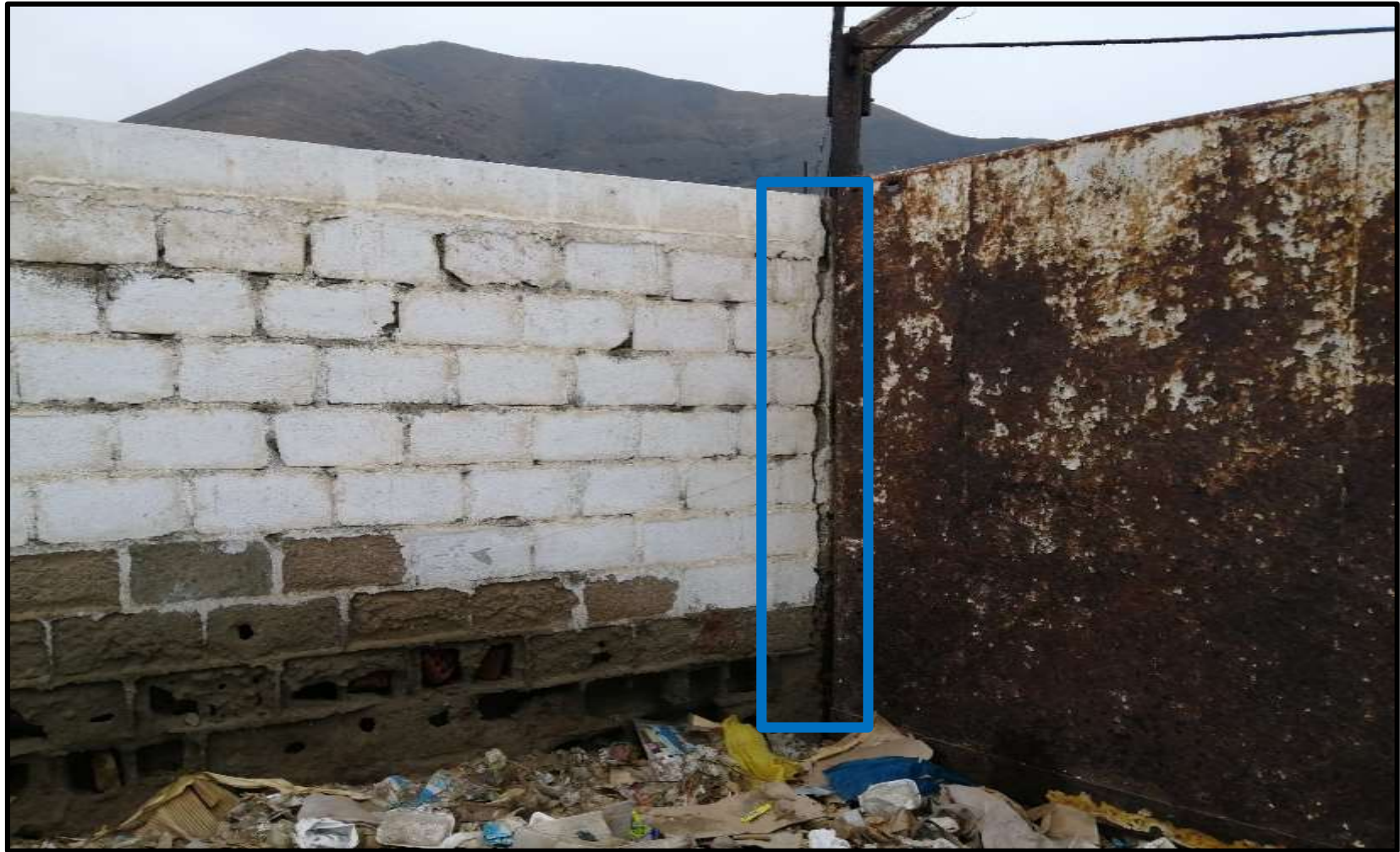
Fotografía 12: Patología Grieta presente en la Columna en la Fábrica Corporación del Mar S.A. en la Unidad Muestral 05. Fuente: Elaboración propia. (2019).
