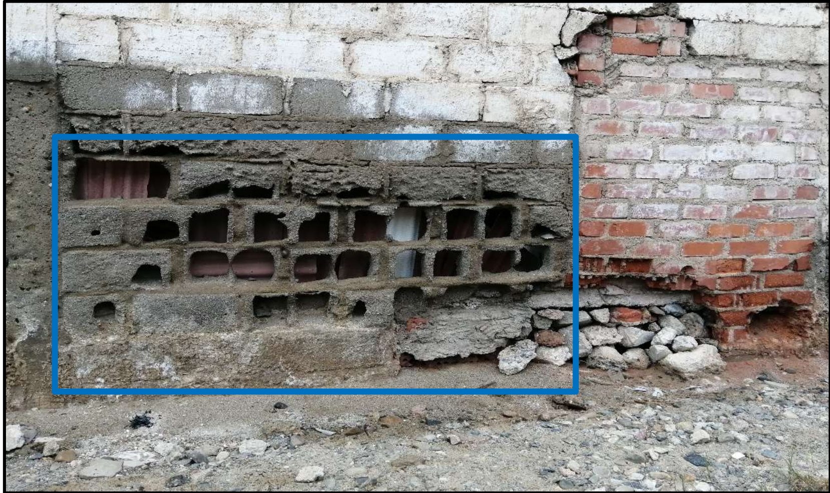
Fotografía 8: Patología Erosión presente en el Muro en la Fábrica Corporación del Mar S.A. en la Unidad Muestral 13.
