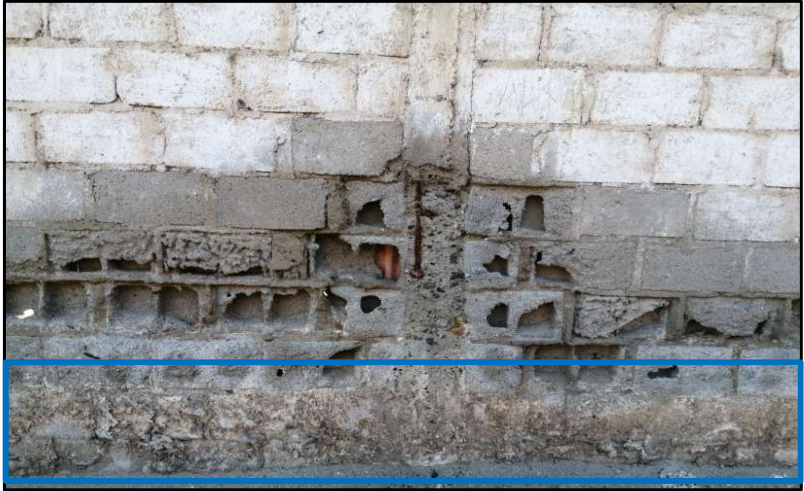
Fotografía 7: Patología Eflorescencia presente en el Muro en la Fábrica Corporación del Mar S.A. en la Unidad Muestral 10. Fuente: Elaboración propia. (2019).
