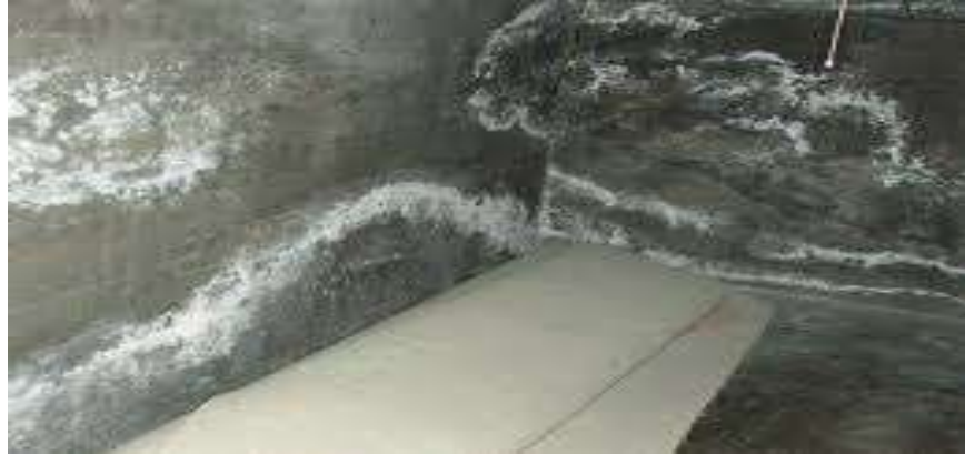
Figura 28: Eflorescencia en un Muro.
