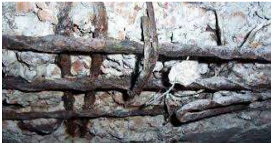
Figura 27: Corrosión del acero de una Viga.
