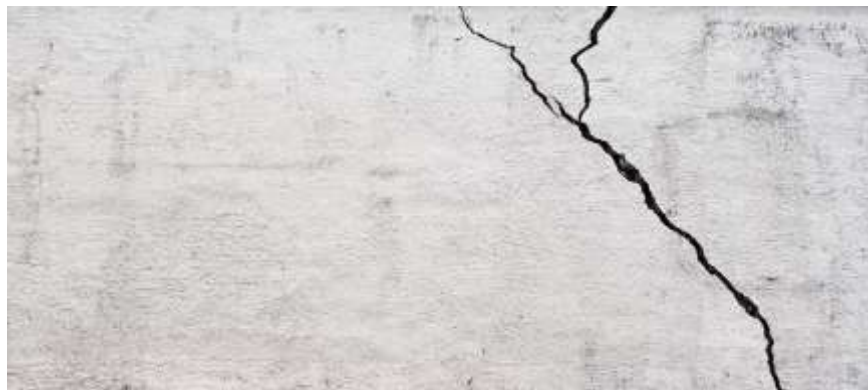
Figura 25: Grietas en un Muro.
