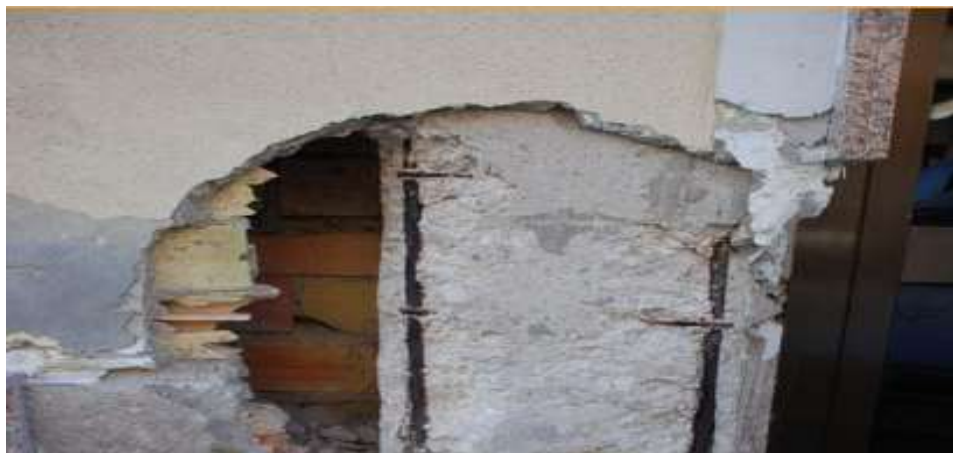
Figura 20: Patología Corrosión y Desprendimiento.
