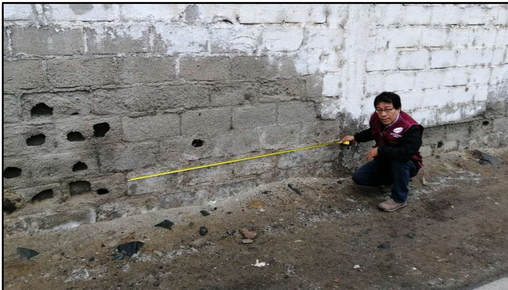
Fotografía 15: Midiendo la patología Eflorescencia presente en el Muro de la Fábrica Corporación del Mar S.A.en la Unidad Muestral 04.
